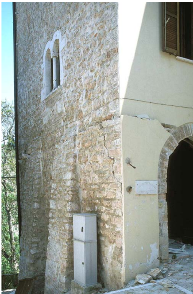
Umbria 1997: rottura orizzontale muratura dovuta al nuovo solaio in calcestruzzo
