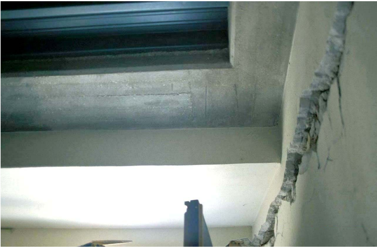
Umbria 1997: rottura orizzontale muratura dovuta al nuovo solaio in calcestruzzo
