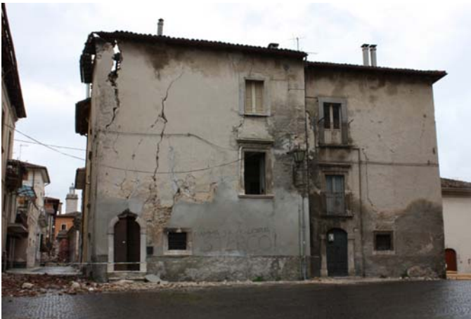
L'Aquila 2009 Separazione parete all'intersezione con quella perpendicolare
