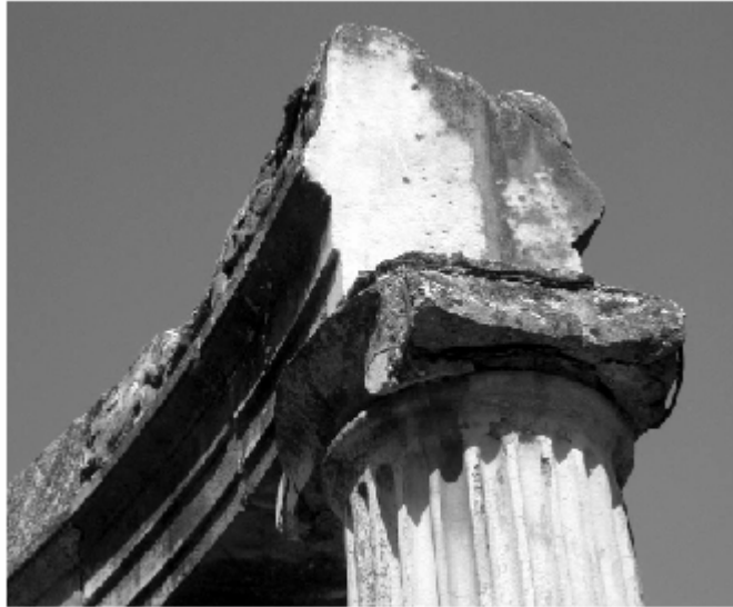
Figura 9 • Ricomposizione con aggiunta di un capitello in calcestruzzo armato. Sono visibili i ferri di armatura.
