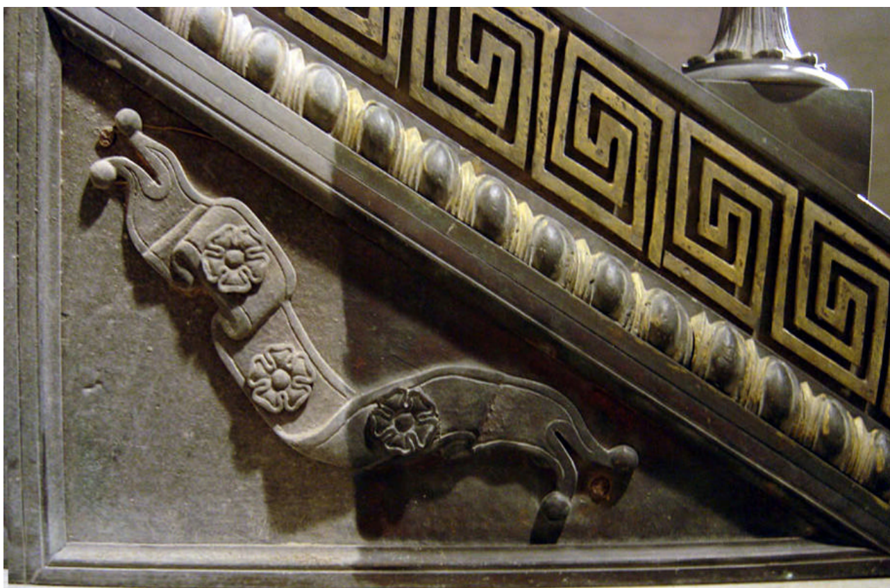
Figura 3 • Palazzo Nobile di Villa Torlonia (Roma). Particolare di una formella della ringhiera durante la stesura del protettivo a base di resina acrilica e benzotriazolo. Il protettivo oltre a proteggere il metallo dalla corrosione, esalta le decorazioni. (DEMMELEBAUER)
