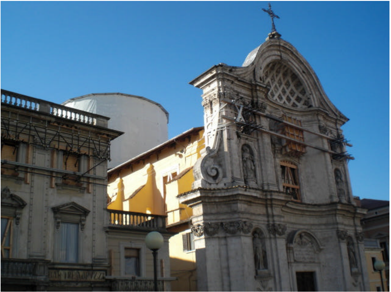
Figura 10 • L'Aquila, chiesa delle Anime Sante: sistema provvisorio di tiranti atto a raffrenare il possibile moto verso l'esterno delle fronti libere di facciata. (BUC)
