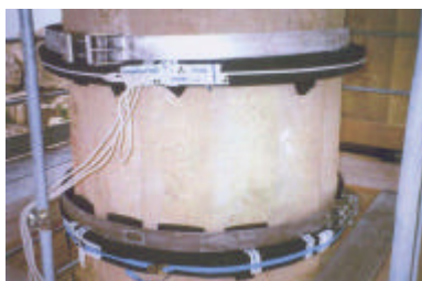
Fig. 27 • Selinunte (Trapani), Tempio C. Intervento di cerchiatura con fascia in titanio e strati elastometrici intermedi in neoprene.
