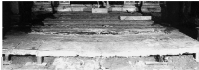
Figura 5 • Smontaggio del rivestimento marmoreo di un pavimento. Anche i sottostanti lastroni, che costituiscono lo "zatterone" in pietra sul quale è posato il pavimento a tarsie, sono stati rilevati, numerati e fotografati prima di procedere alla loro rimozione. (SAV)
