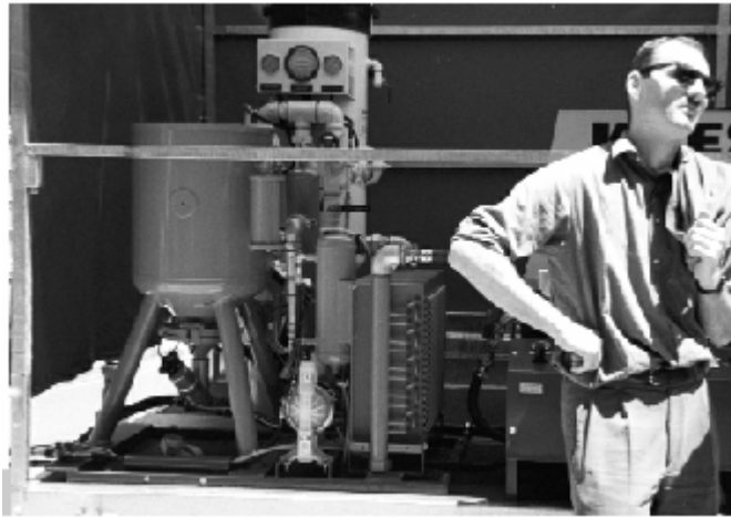
Figura 1 • Centrale di trattamento e distribuzione allestita su un camion per facilitare il trasferimento dell'apparecchiatura sul luogo dell'intervento. (HRB)
