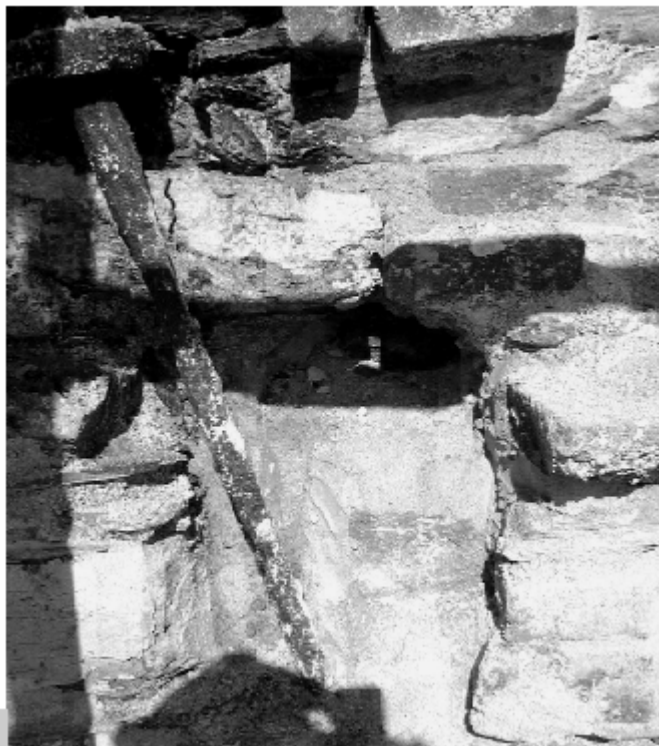
Figura 3 • Lacuna di muratura in prossimità di un bolzone.
