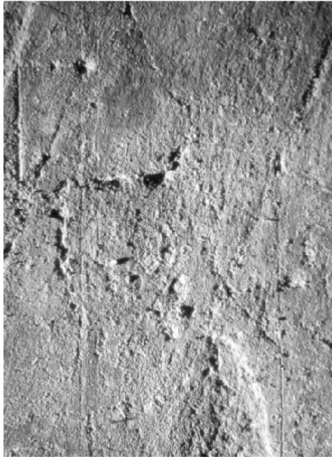
Figura 3 • Efflorescenza con effetto disgregativo (impasto di cocciopesto). (OPD)
