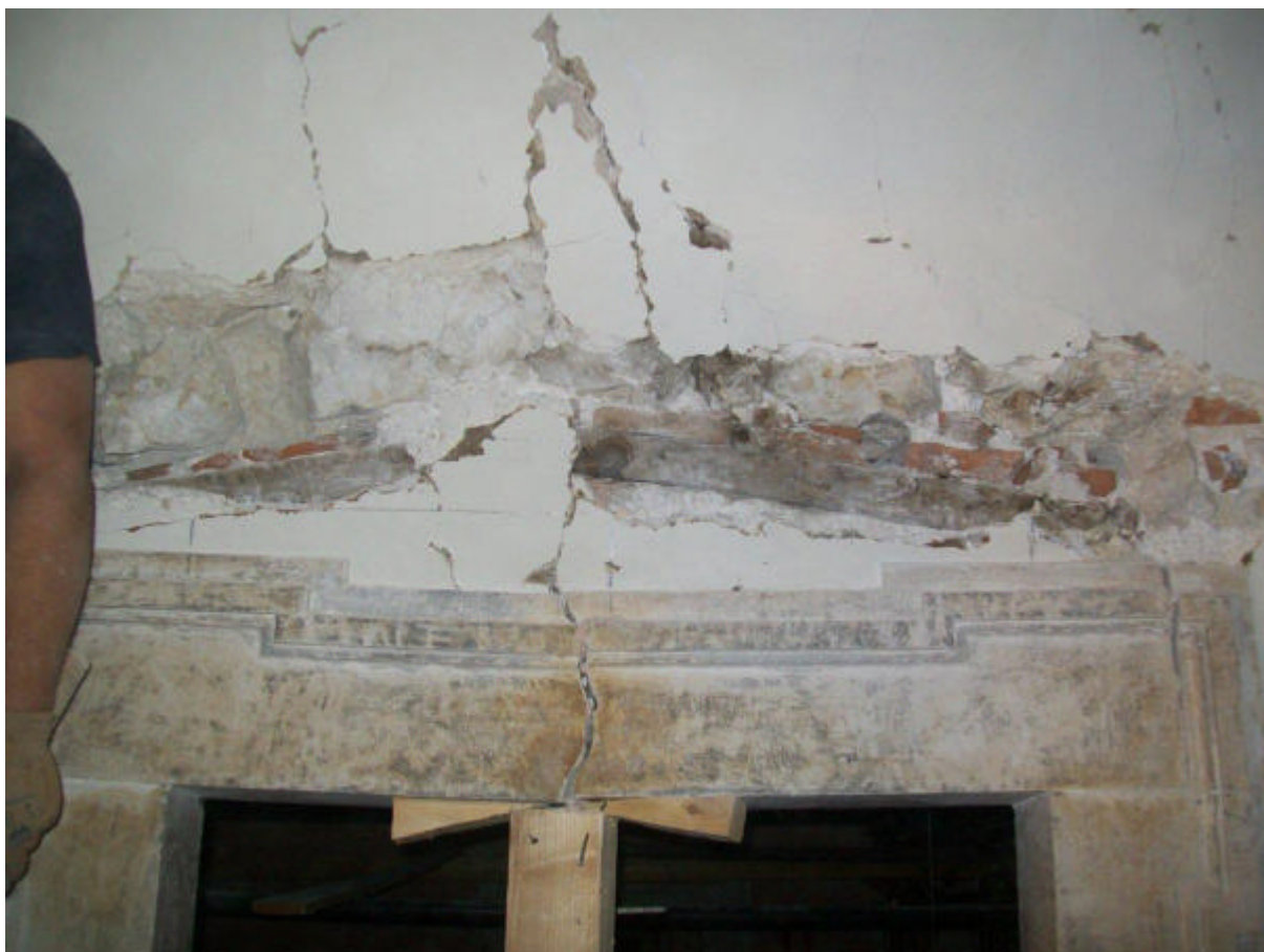
Figura 5 • Ripa di Fagnano (Fagnano Alto, L'Aquila), palazzo Rosati, dissesto di un architrave danneggiato dal sisma del 6 aprile 2009; Settembre 2011.
