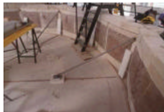
Fig. 13 • Perugia, Fontana Maggiore: il restauro della fontana ha previsto l'impiego di materiali moderni tra cui le FRP e il titanio, utilizzato in sostituzione del ferro piombato originario (già precedentemente soppiantato da elementi d'acciaio) e, sotto forma di lamine, per proteggere le stesse fibre.
