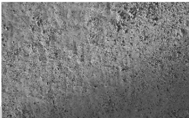
Figura 4 • Presa analoga a quella della fig. 2, ma su una superficie intonacata. Le ombre create dalla luce radente (solare) evidenziano le leggere ondulazioni della superficie apparentemente liscia. (SAT)
