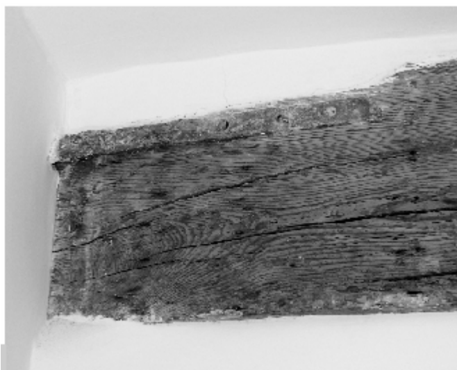
Figura 2 • Catena lignea di serraggio delle murature. È visibile la staffa metallica di collegamento al muro.
