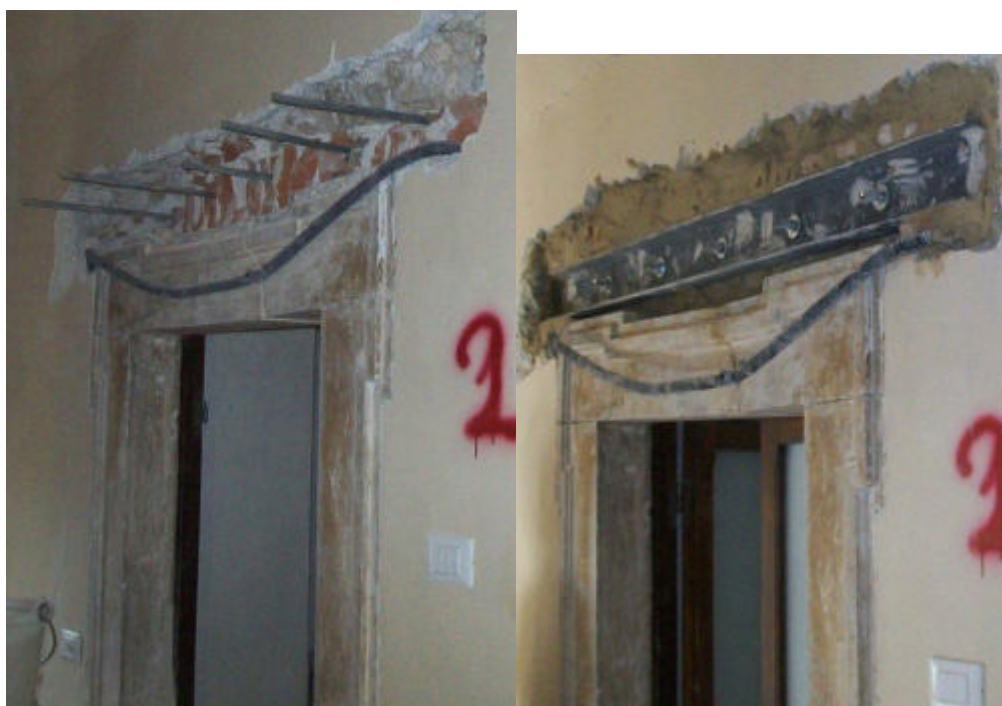
Figura 6 • Ripa di Fagnano (Fagnano Alto, L'Aquila), palazzo Rosati, fasi di intervento nel rinforzo di un architrave lapideo con una coppia di profilati metallici: a) alloggiamento di barre di collegamento fra i 2UPN140; b) disposizione del profilato metallico e serraggio delle barre; Ottobre 2011.
