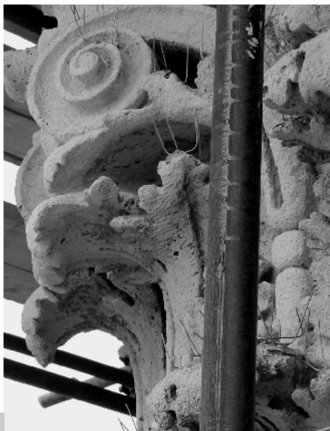
Figura 4 • Protezione di un capitello mediante il posizionamento di dissuasori ad aghi.
