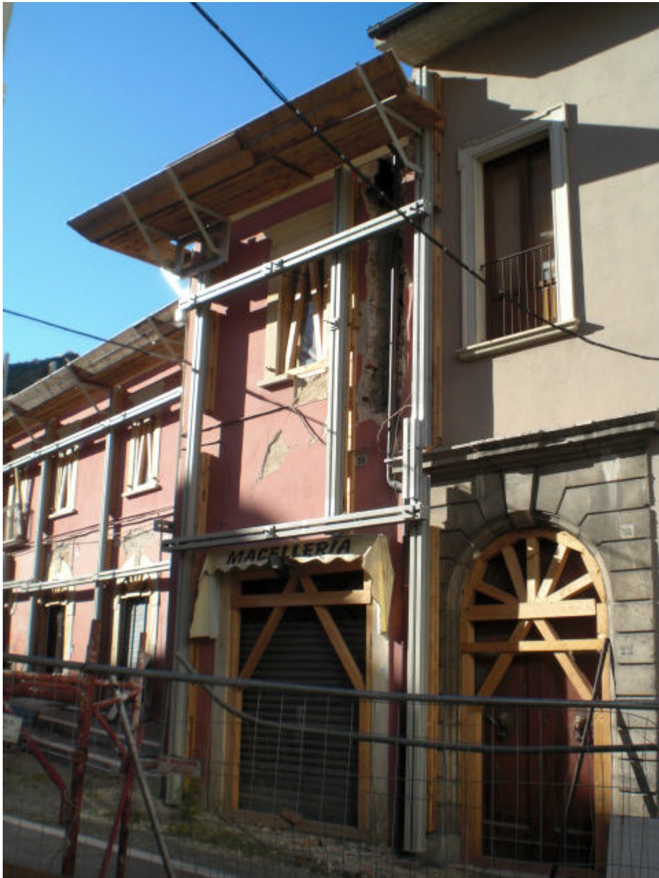
Figura 11 • Sbadacchiature in legno nel centro storico di L'Aquila, Aprile 2010. (BUC)
