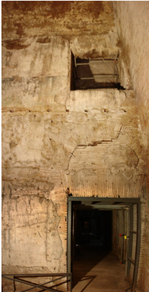
Figura 13 • Roma, Domus Aurea, il dissesto in prossimità di una piattabanda e arco di scarico in laterizi; Studio Croci & Associati, 2011.
