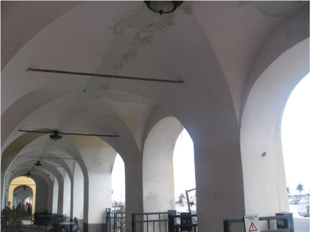
Figura 9 • Portici di Calata Cuneo, Imperia Oneglia: le catene metalliche scandiscono con passo costante la struttura dei portici. (BUC)
