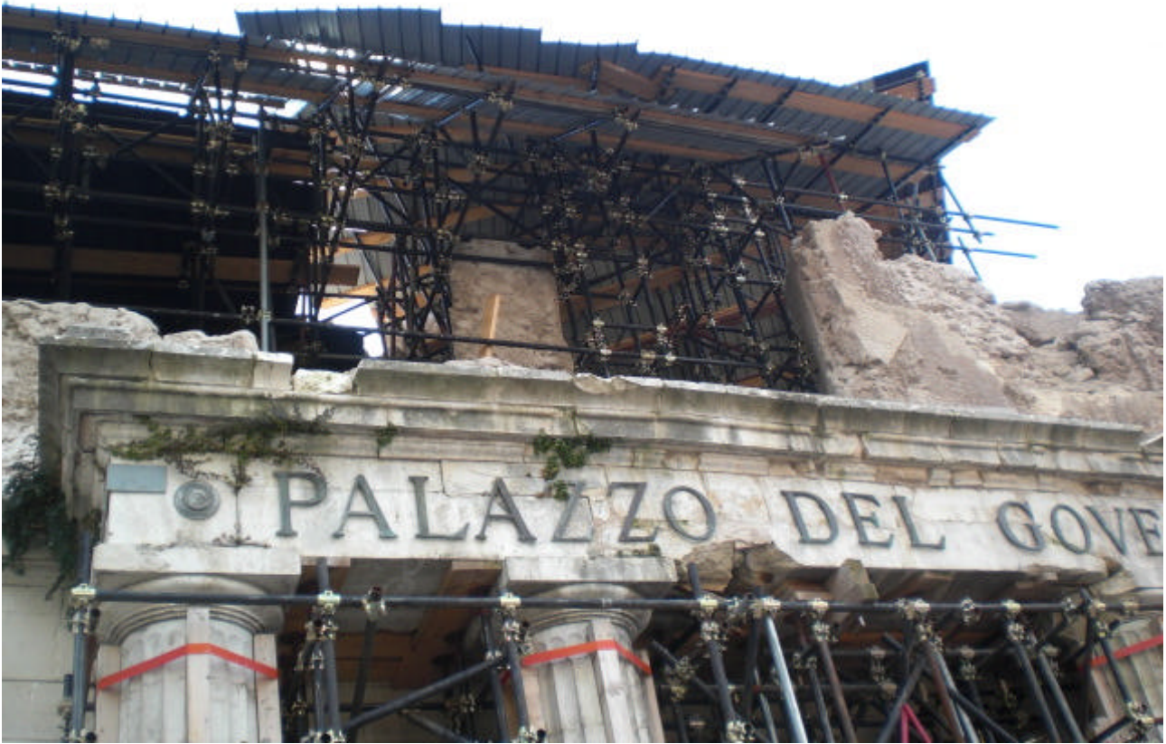
Figura 14 • Sistema reticolare di puntelli metallici a sostegno dell'architrave del Palazzo del Governo nel centro storico di L'Aquila, aprile 2010. (BUC)
