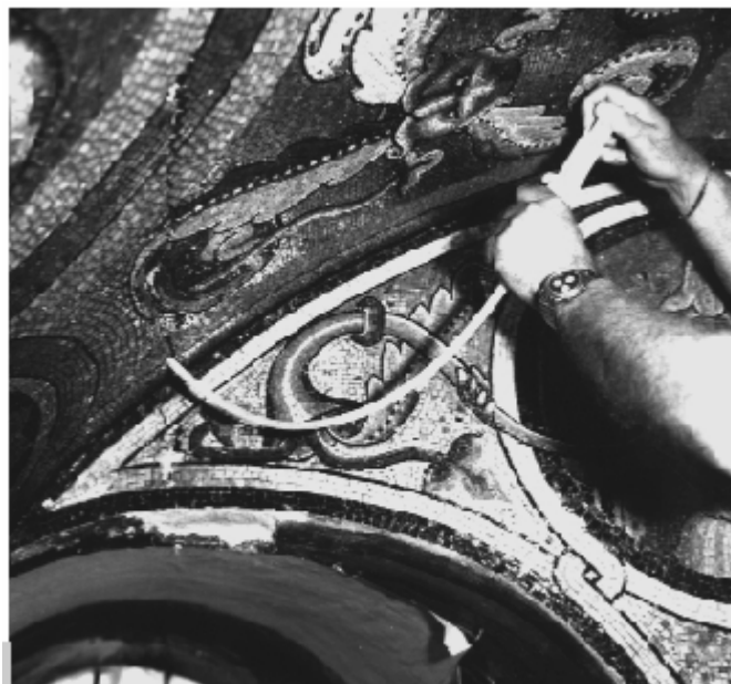
Figura 2 • Mosaico parietale: consolidamento del distacco della malta di allettamento dalla struttura muraria, mediante l'inserimento di malta a espansione o "lievitante", sino al raggiungimento della saturazione dei vuoti. (OPD)
