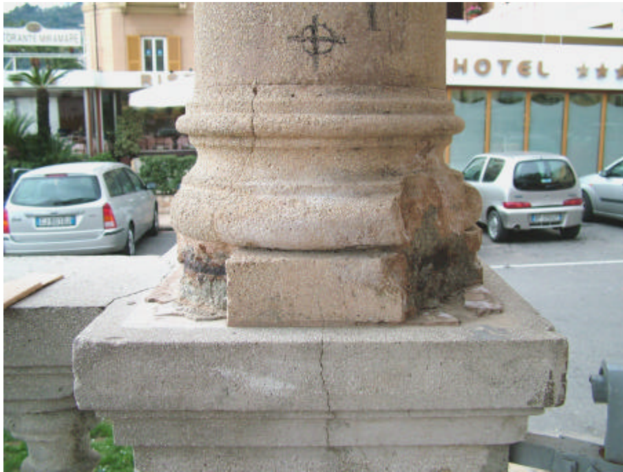
Figura 15 • Mancanze in un basamento in pietra artificiale.
