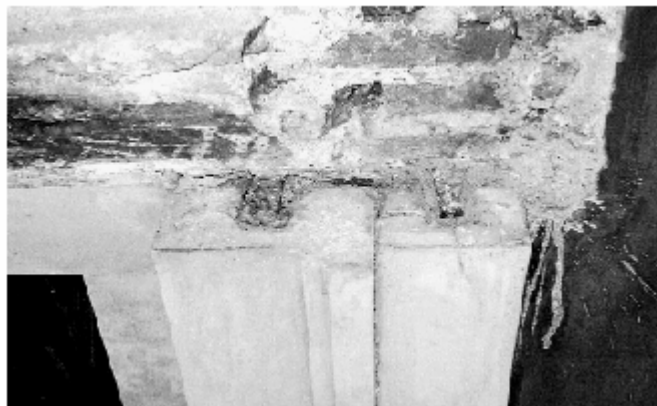
Figura 7 • Sostituzione degli elementi di connessione di una cornice di marmo: elemento di connessione di un montante della cornice.
