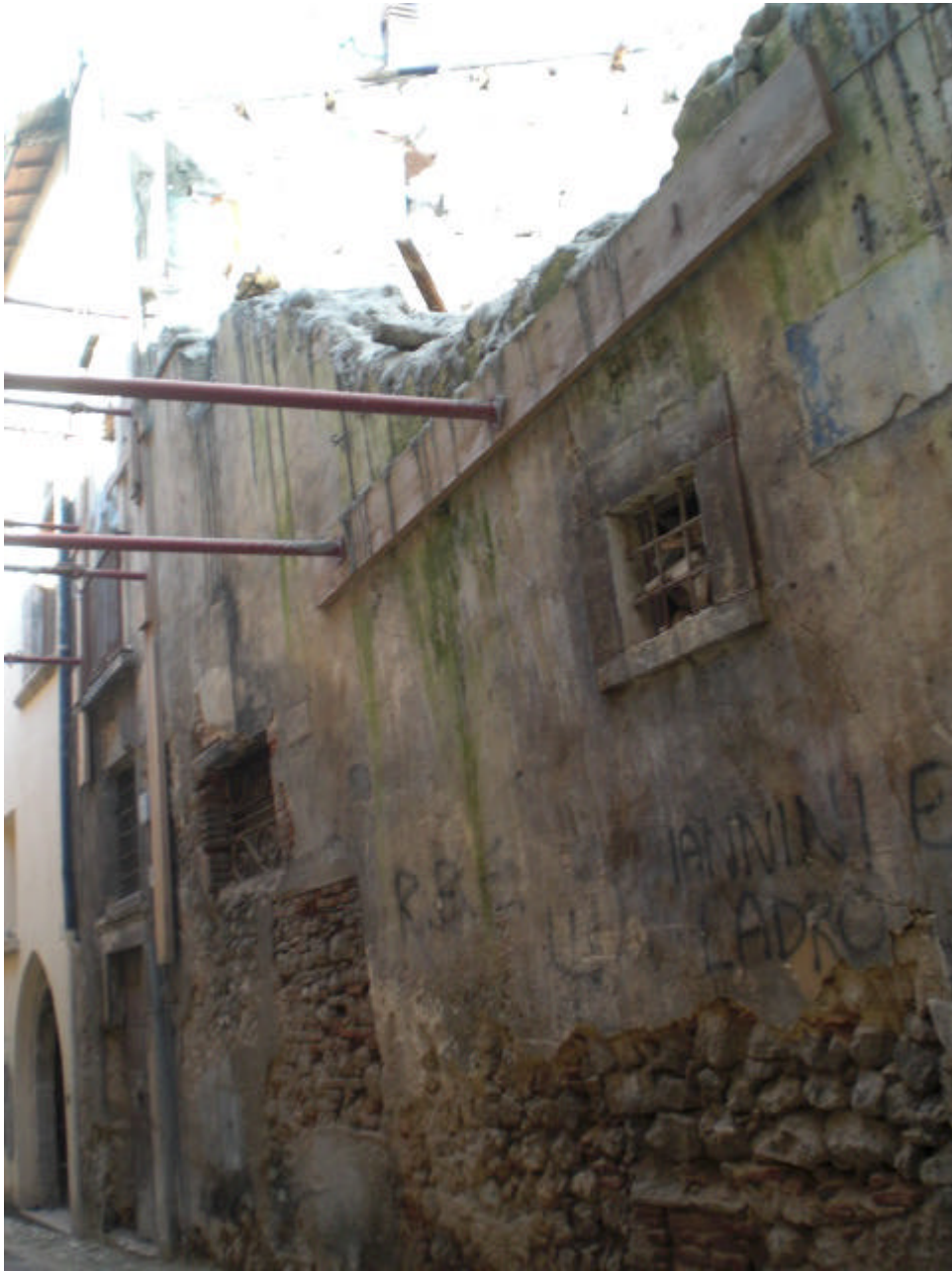
Figura 12 • Puntelli metallici di ritegno nel centro storico di L'Aquila, Aprile 2010. (BUC)
