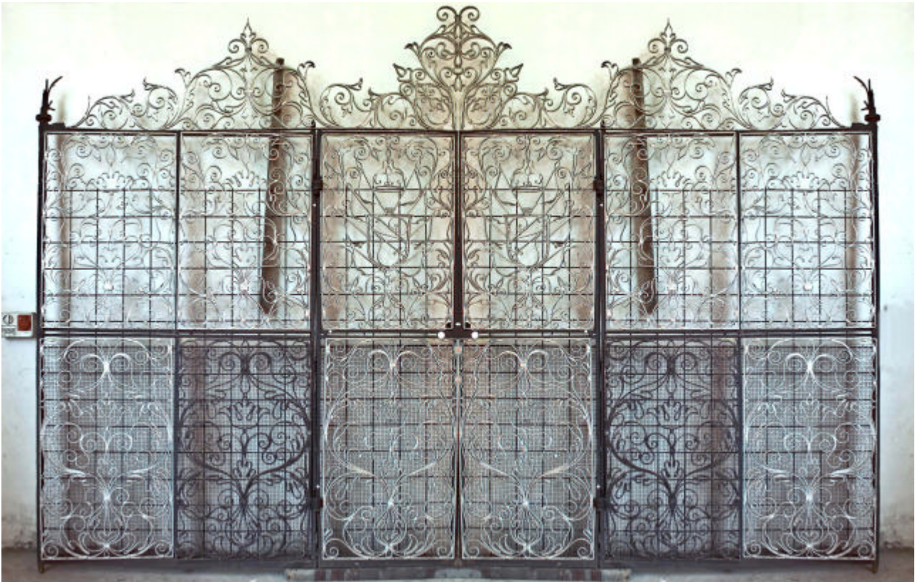
Figura 8 • Villa Barbaro a Maser. Cancelli seicentesco pulito impropriamente con sabbiatura a secco e bagno acido e successivamente sottoposto a zincatura a caldo. Tali trattamenti hanno alterato in modo irreversibile le caratteristiche fisiche e chimiche della superficie metallica. Il cancello, inoltre, è stato rimosso dalla collocazione originaria mediante tagli che hanno lasciato monconi residui delle volute decorative alle estremità superiori destra e sinistra. (TORSSELLO)
