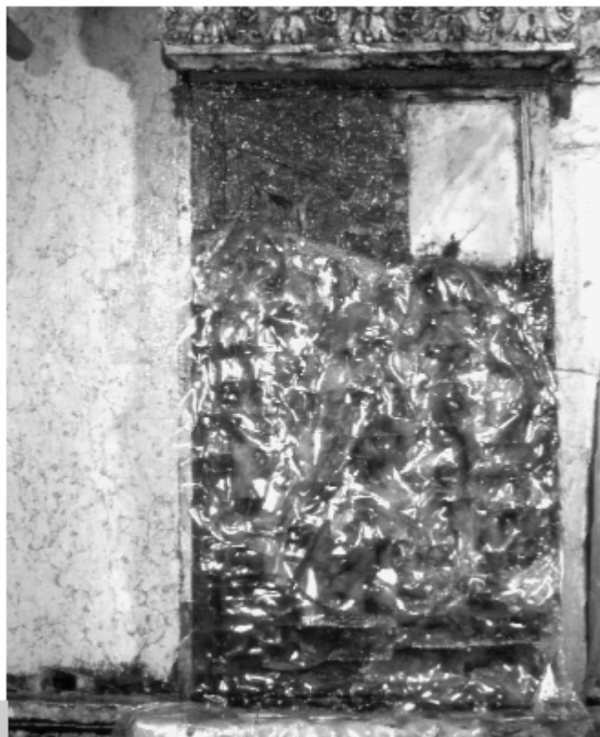
Figura 3 • Pulitura di superficie lapidea da croste nere mediante impacco con sostanze solventi. Sono visibili tre fasi del procedimento: nella parte bassa, la superficie è ancora ricoperta dall'impacco e da una pellicola plastica che ne impedisce l'evaporazione; in alto a sinistra, l'impacco è ormai impregnato di materiale disciolto; in alto a destra, la fase finale e la superficie pulita. (NFM)
