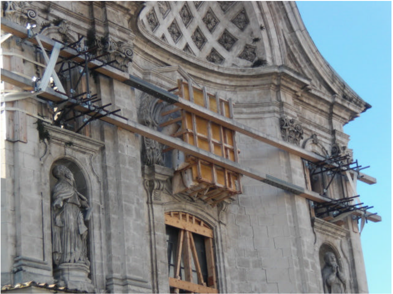
Figura 11 • L'Aquila, chiesa delle Anime Sante: particolare del sistema provvisorio di tiranti. (BUC)
