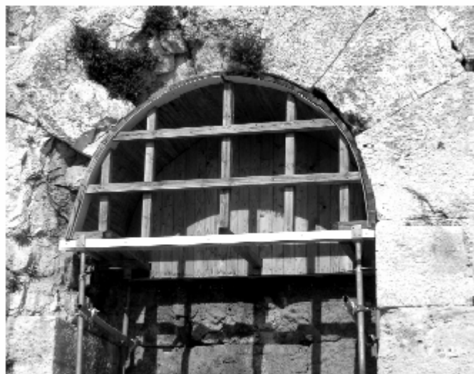
Figura 8 • Puntellatura "a sbalzo" realizzata in legno e metallo nelle arcate del teatro di Erode Attico ad Atene.
