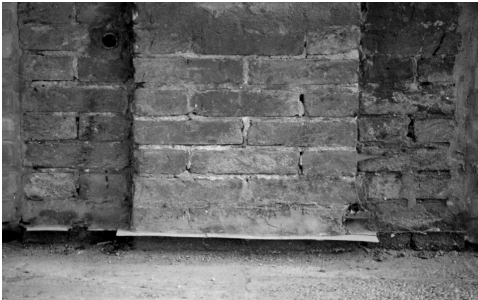
Figura 1 • Taglio meccanico della muratura: barriera con fogli di materiali impermeabili . Inserimento dei fogli impermeabili, dimensionati in modo da prevedere la loro sporgenza dal filo del muro per almeno 2 cm (per creare la barriera anche nello strato di finitura esterno della parete).
