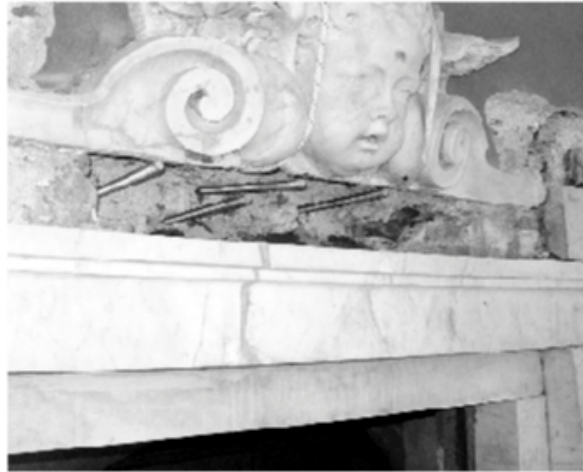
Figura 5 • Sostituzione degli elementi di connessione di una cornice di marmo: inserimento di perni filettati di acciaio inox alla base dell'architrave.
