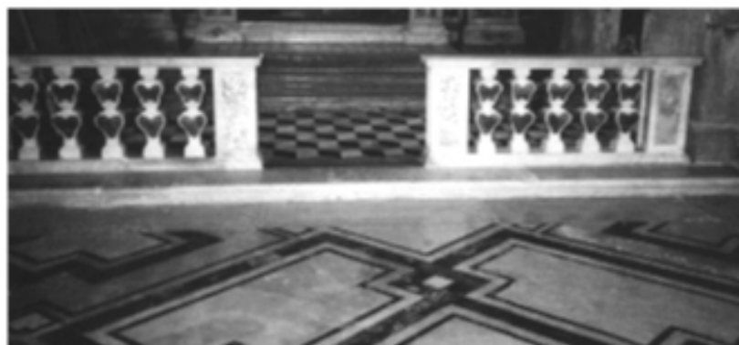
Figura 8 • Smontaggio del rivestimento marmoreo di un pavimento. L'intervento ha consentito il recupero del cedimento, il restauro della superficie marmorea e, attraverso il ripristino dello strato di resina, l'impermeabilizzazione della struttura. (SAV)
