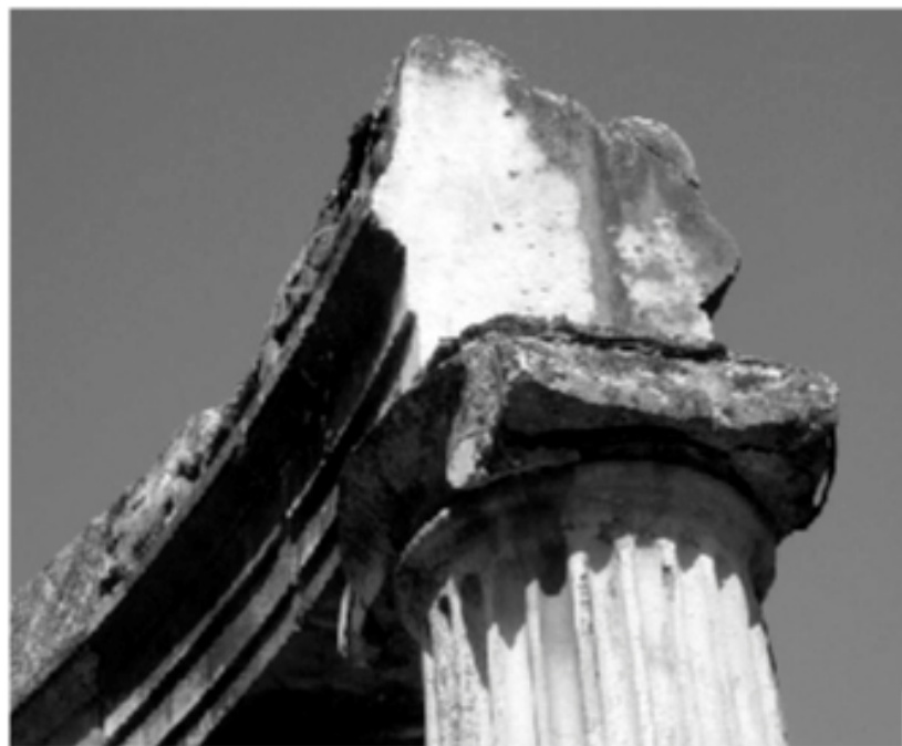
Figura 9 • Ricomposizione con aggiunta di un capitello in calcestruzzo armato. Sono visibili i ferri di armatura.
