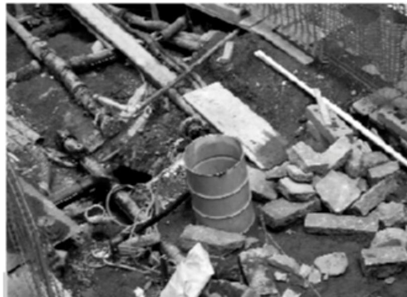
Figura 9 • Pavimentazione rimossa per consentire opere di manutenzione straordinaria degli impianti tecnici urbani.
