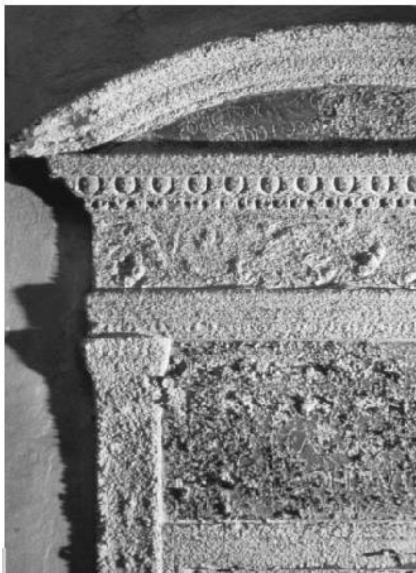
Figura 1 • Superficie lapidea fortemente decoesa sulla quale sono necessari interventi di pulitura che potrebbero essere incompatibili con la fragilità della superficie stessa e determinare perdite o distacchi irreversibili di materiale. (NFM)
