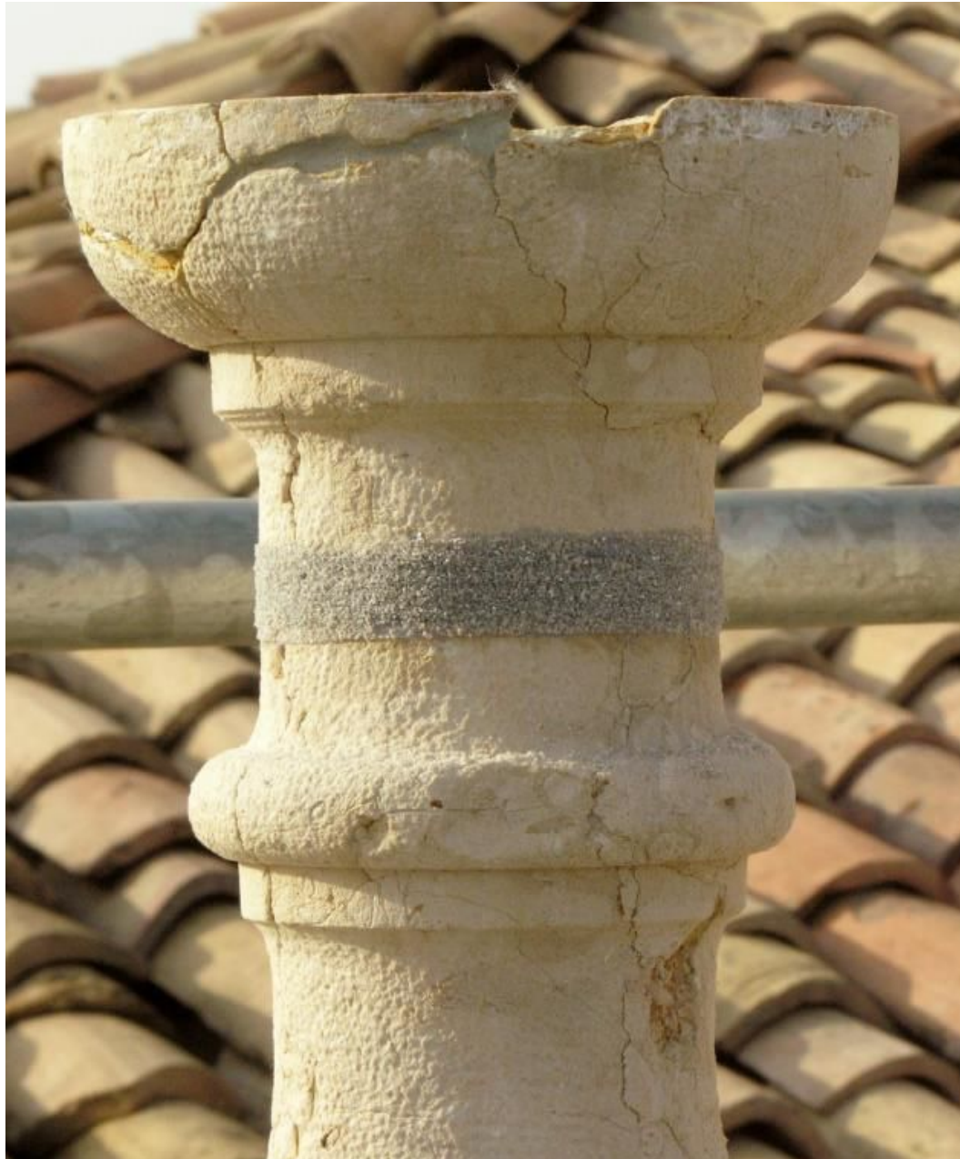
Figura 13 • Nastro di altezza ridotta in fibra di carbonio prima della stesura della malta di finitura. (ADORNI)
