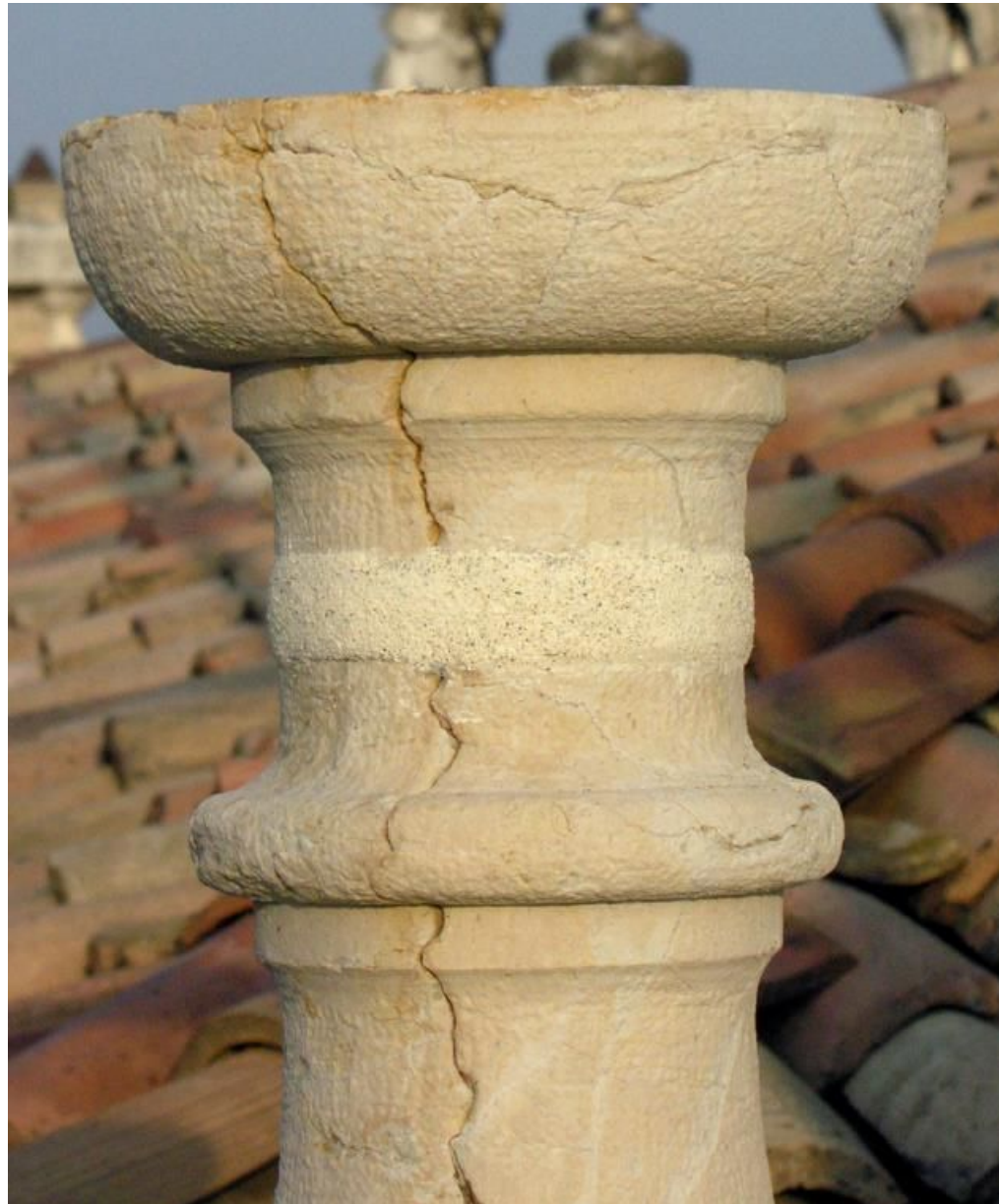
Figura 14 • Nastro in fibra di carbonio dopo la stesura della malta di finitura (calce naturale e inerti di calcare ammonitico, dimensioni > 0,1-0,2 mm). (ADORNI)
