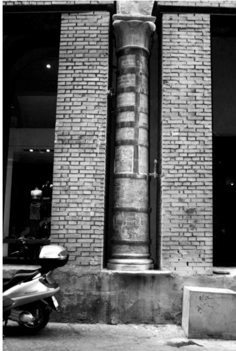
Figura 3 • Colonna in mattoni con base e capitello in pietra, stretta da numerose cerchiature lungo tutto il fusto. Ai lati, due pilastri di mattoni scaricano, parzialmente, la colonna dal peso delle strutture sovrastanti.
