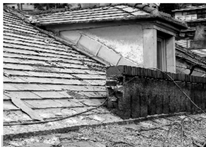
Figura 9 • Dettaglio di un tratto di copertura con abbadini frantumati, nei pressi di muretto d'attico pericolante.
