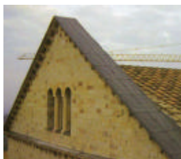
Fig. 28 • Assisi, Basilica di San Francesco. Copertura oggetto degli interventi succedutisi al sisma del 1997.
