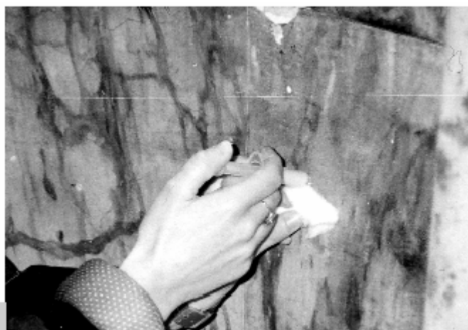
Figura 4 • Iniezione del consolidante. Con una piccola spugna umida si provvede alla immediata pulitura della superficie forata dall'eventuale fuoriuscita del consolidante.
