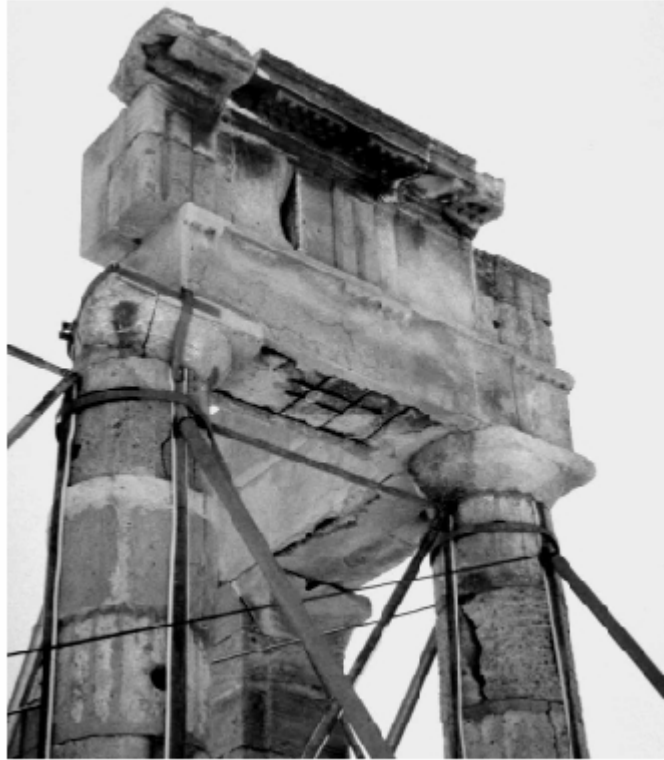
Figura 2 • Sistema articolato di puntellazione che comprende sia sostegni verticali che inclinati. Sono inoltre presenti numerose cerchiature e staffature.
