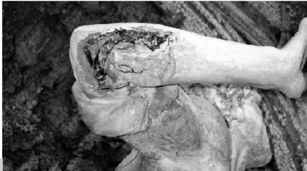
Figura 1 • Caduta di parte del modellato per effetto dell'ossidazione dell'armatura: è in vista il riempimento con pezzi di laterizio. (OPD)
