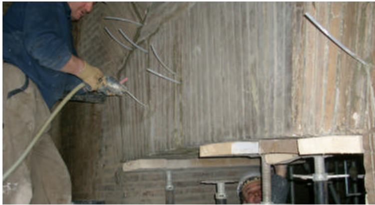
Figura 9 • Roma, Domus Tiberiana, consolidamento di una piattabanda e arco di scarico in laterizi: a) fase preliminare di messa in sicurezza con puntelli metallici; b) inserimento delle cannule per l'esecuzione di iniezioni; c) iniezione; Febbraio - Marzo 2011.
