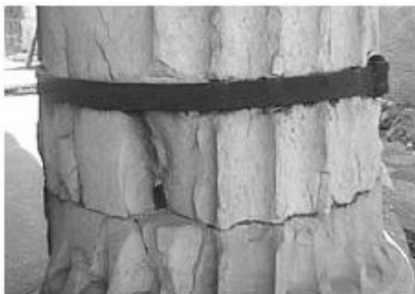
Figura 8 • Cerchiatura tradizionale applicata a diretto contatto della pietra e con rottura delle scanalature.
