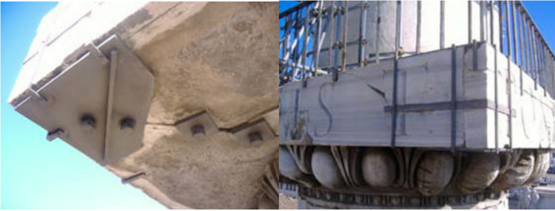
Figg. 19 e 20 • Roma, Colonna Antonina. Immagini del capitello rinforzato con una gabbia metallica, adottata in passato per far fronte alla presenza delle fratture rappresentate nello schema assometrico di fig. 20. Negli stessi anni dell'esecuzione dell'intervento sull'Eretteo, elementi di titanio vennero adottati sulla colonna Antonina per sostituire quelli di ferro imposti da Fontana.
