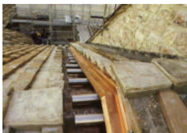
Fig. 31 • Assisi, Basilica di San Francesco. Dettaglio della intersezione tra copertura e muro di facciata in cui sono stati posizionati i vincoli ottenuti con i dispositivi SMAD.
