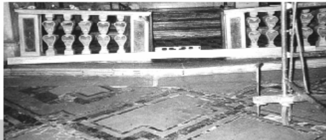
Figura 3 • Smontaggio del rivestimento marmoreo di un pavimento: si noti il cedimento in corrispondenza dell'asse centrale della cappella, riconducibile al cattivo costipamento del terreno sottostante. (SAV)
