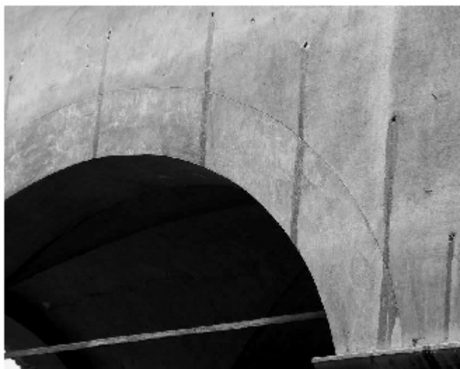
Figura 9 • Applicazione errata della tecnica, con fuoriuscita del prodotto consolidante dai fori di iniezione e conseguente formazione di colature difficilmente eliminabili.
