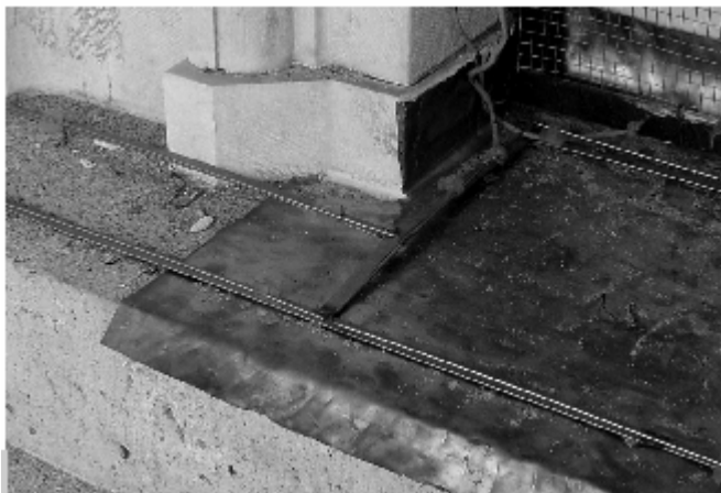
Figura 1 • Sistema elettrostatico per l'allontanamento di volatili: protezione di un marcadavanzale.
