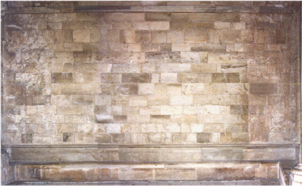
Figura 19 • Castel del Monte, sala VIII, primo piano, parete in conci lapidei con tracce del rivestimento parietale originale in lastre marmoree (alloggiamenti per le grappe di fissaggio delle lastre, grappe intere o spezzate, piombo ecc.). (DEP)
