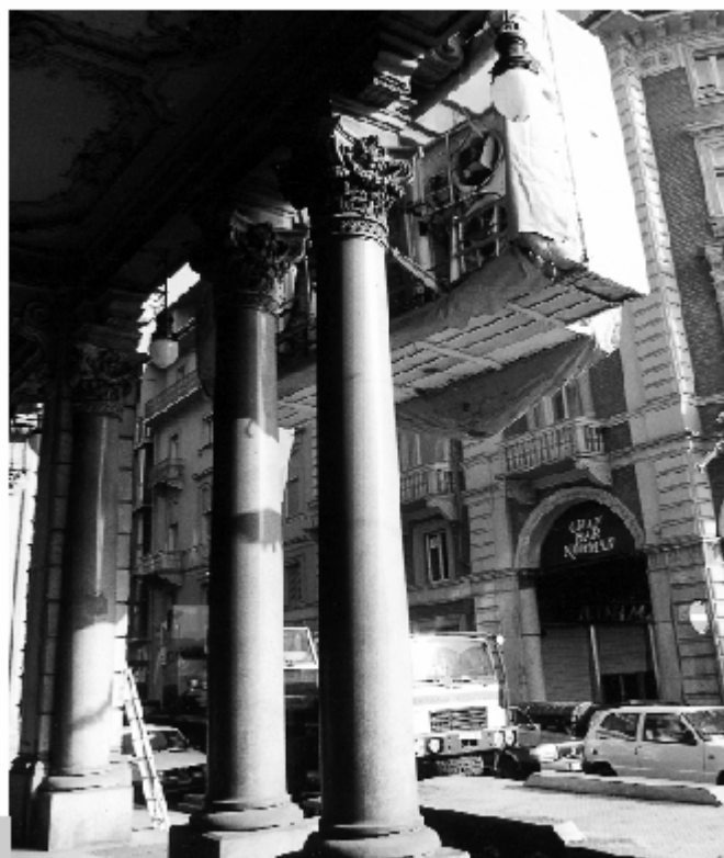
Figura 2 • Cabina sospesa con impianto di emissione del 2 flusso pulente e di aspirazione e filtraggio delle polveri.
