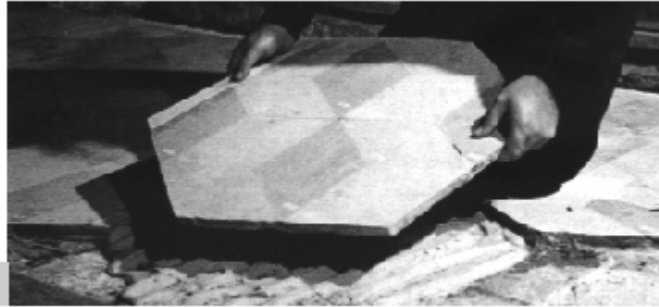
Figura 7 • Smontaggio del rivestimento marmoreo di un pavimento. Dopo aver steso la resina sulla faccia inferiore del primo esagono e sulla superficie corrispondente dello zatterone in pietra, può avvenire la posa del primo elemento. La resina deve essere preparata ogni volta, per ogni singolo pezzo. (SAV)
