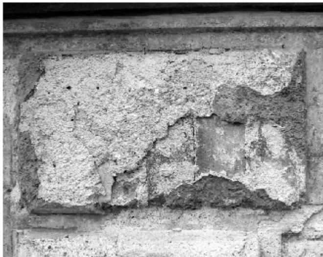
Figura 2 • Distacco degli strati d'intonaco da una bugna realizzata con malta.
