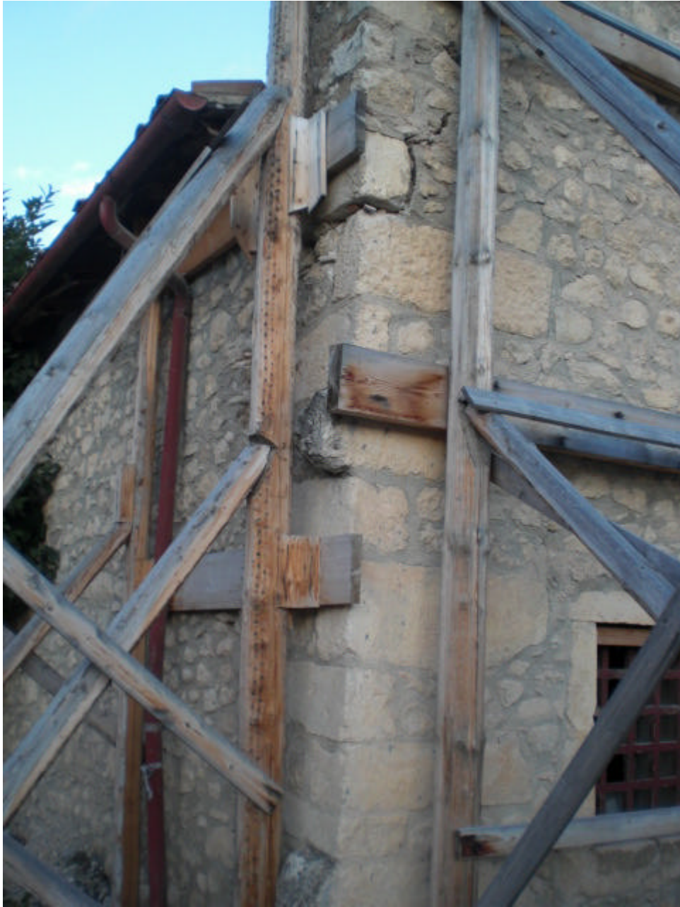
Figura 15 • Sistema di puntelli lignei di ritegno nel centro storico d L'Aquila, Aprile 2010. (BUC)
