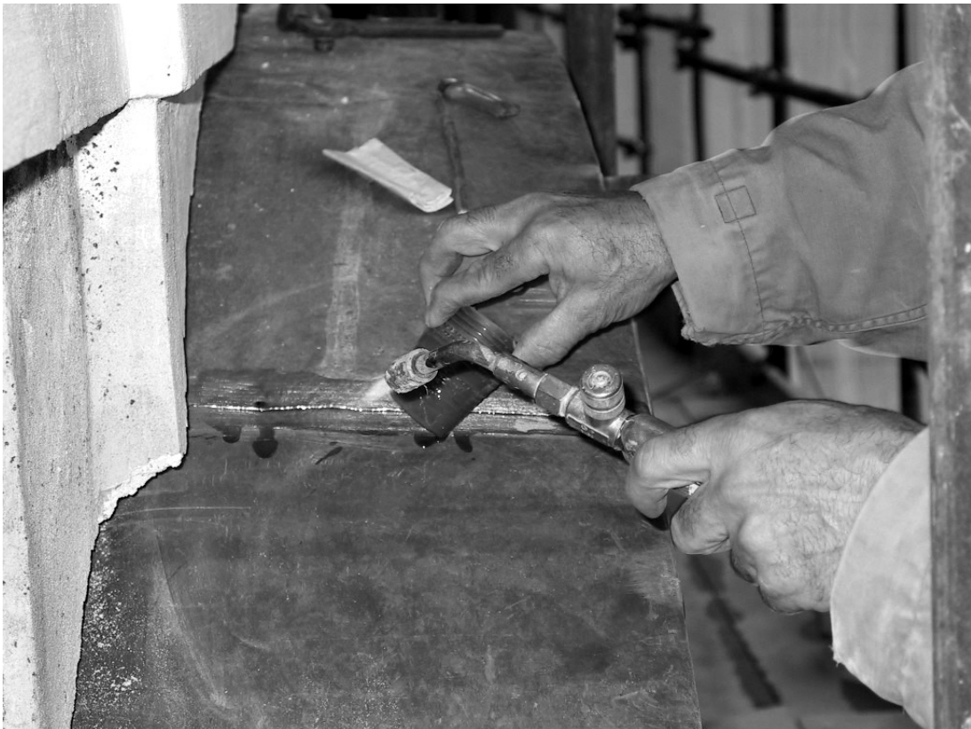
Figura 15 • Riscaldamento dei lembi da saldare e preparazione delle superfici con applicazione di stearina.
