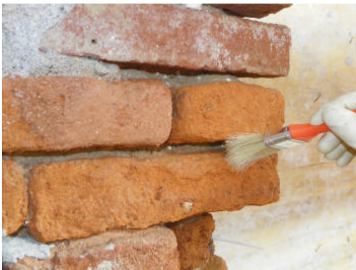
Figura 1 • Pulitura dell'area oggetto di intervento. (Cantiere di restauro Villa Picchetta a Cameri (NO) foto Marta Gnone)
