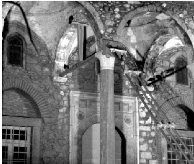
Figura 4 • Puntellatura obliqua di ritegno, per dissesti che si esplicano attraverso una rotazione (ribaltamento di piedritti per la spinta di archi).
