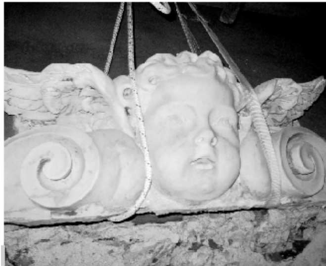
Figura 4 • Sostituzione degli elementi di connessione di una cornice di marmo: l'architrave superiore è imbragato e rimosso dalla sua posizione originale.
