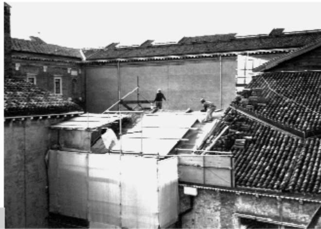
Figura 1 • Smontaggio e rimontaggio di un manto di copertura. Si notino, a sinistra, le coperture provvisorie e, a destra, alcuni coppi accatastati in attesa di essere ricollocati. (SAV)
