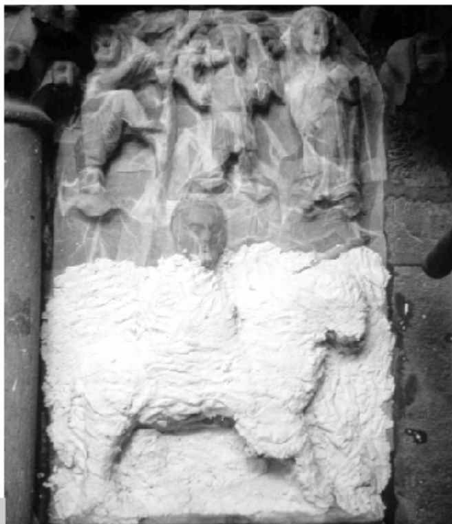
Figura 1 • Prime due fasi di pulitura da croste nere. Nella parte alta, la superficie è protetta da velinatura; nella zona bassa, lo strato di impacco assorbente impregnato di sostanze solventi. (NFM)
