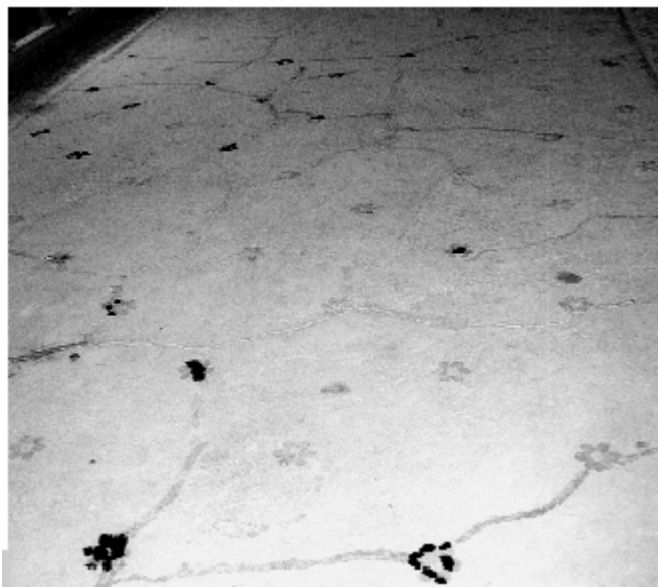
Figura 9 • Il pavimento prima della finitura. Sono ancora evidenti i segni delle fratturazioni integrate. (VIG)
