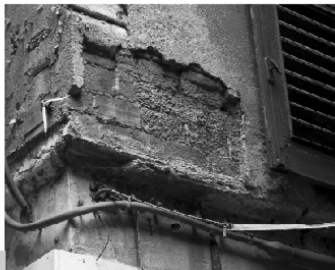
Figura 1 • Perdita di un tratto d'intonaco della facciata.
