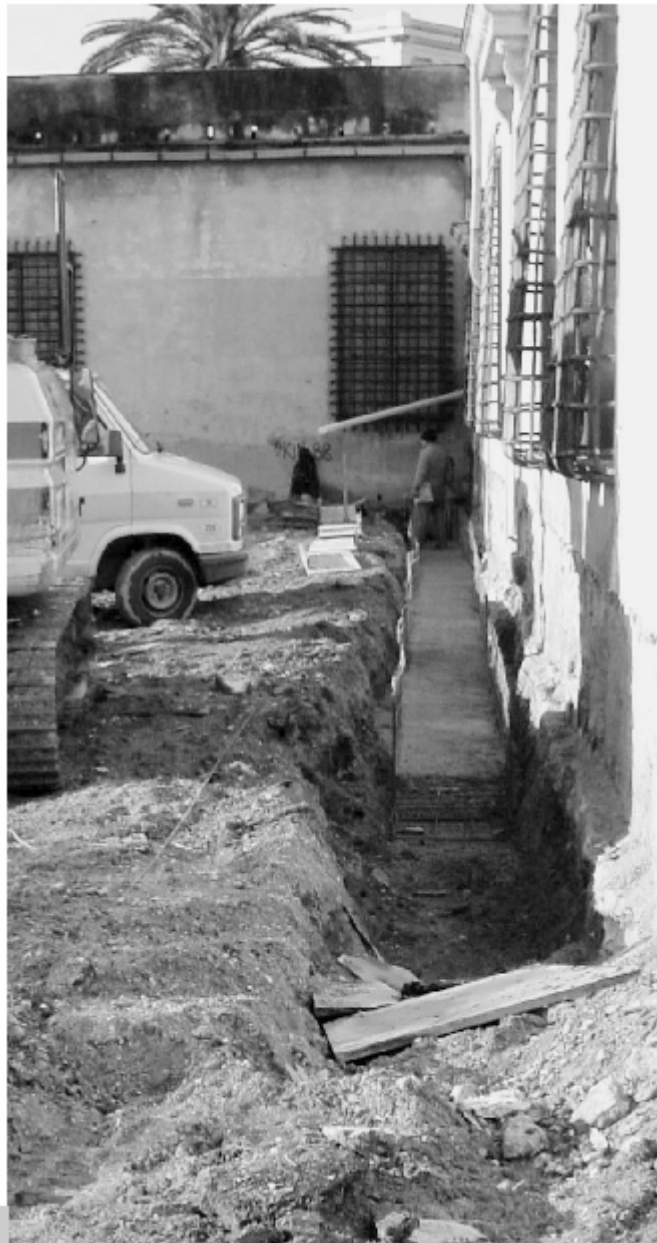
Figura 1 • Intercapedine verticale esterna continua. Lo scavo è stato realizzato in aderenza alla parete dell'edificio per una profondità di 150 cm e larghezza 90 cm.
