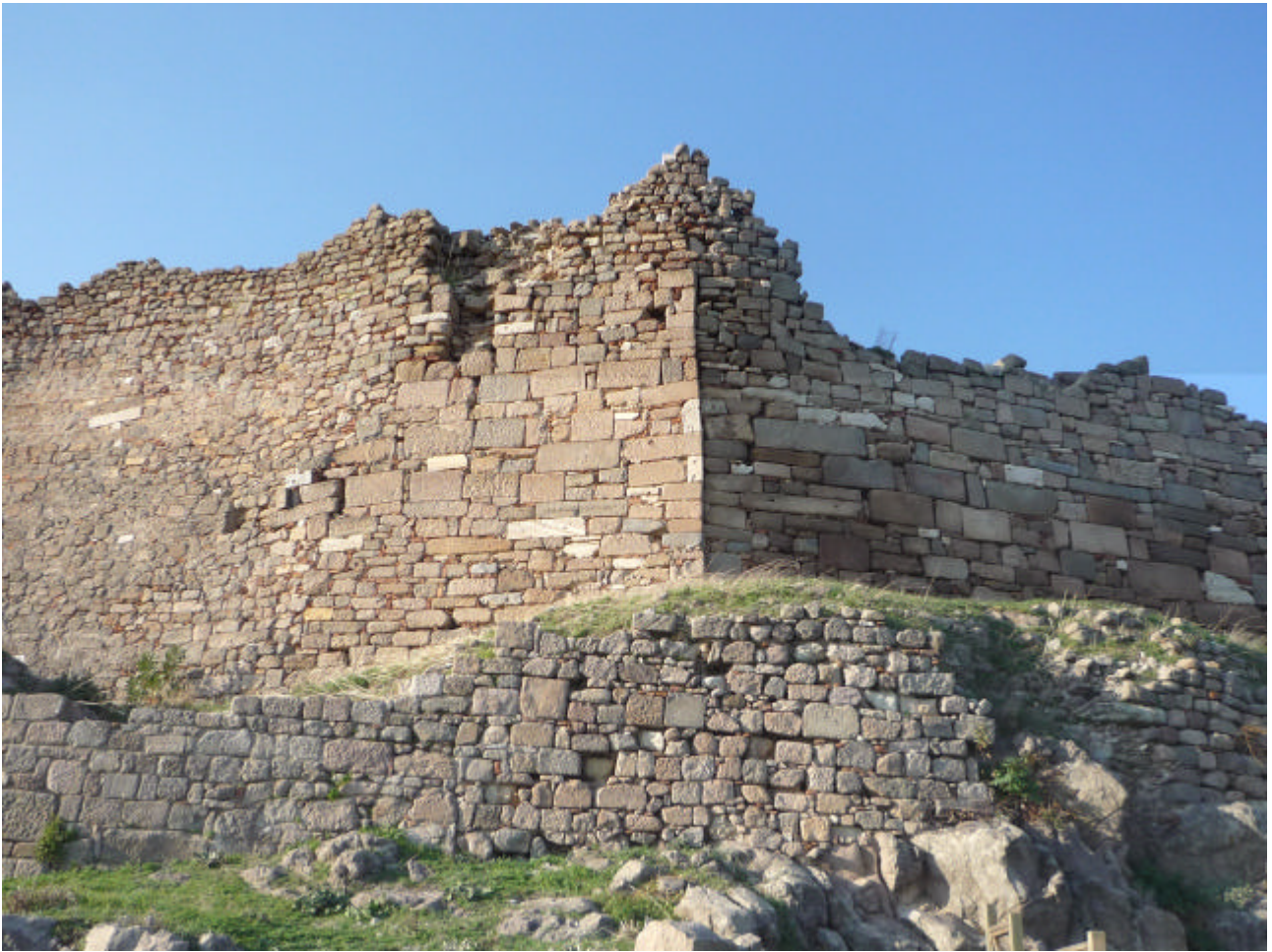
Figura 14 • Acropoli di Pergamo (Turchia): integrazioni murarie con elementi diversi per pezzatura e apparecchiatura, derivanti da raccolta di materiale a piè d'opera. (BUC).
