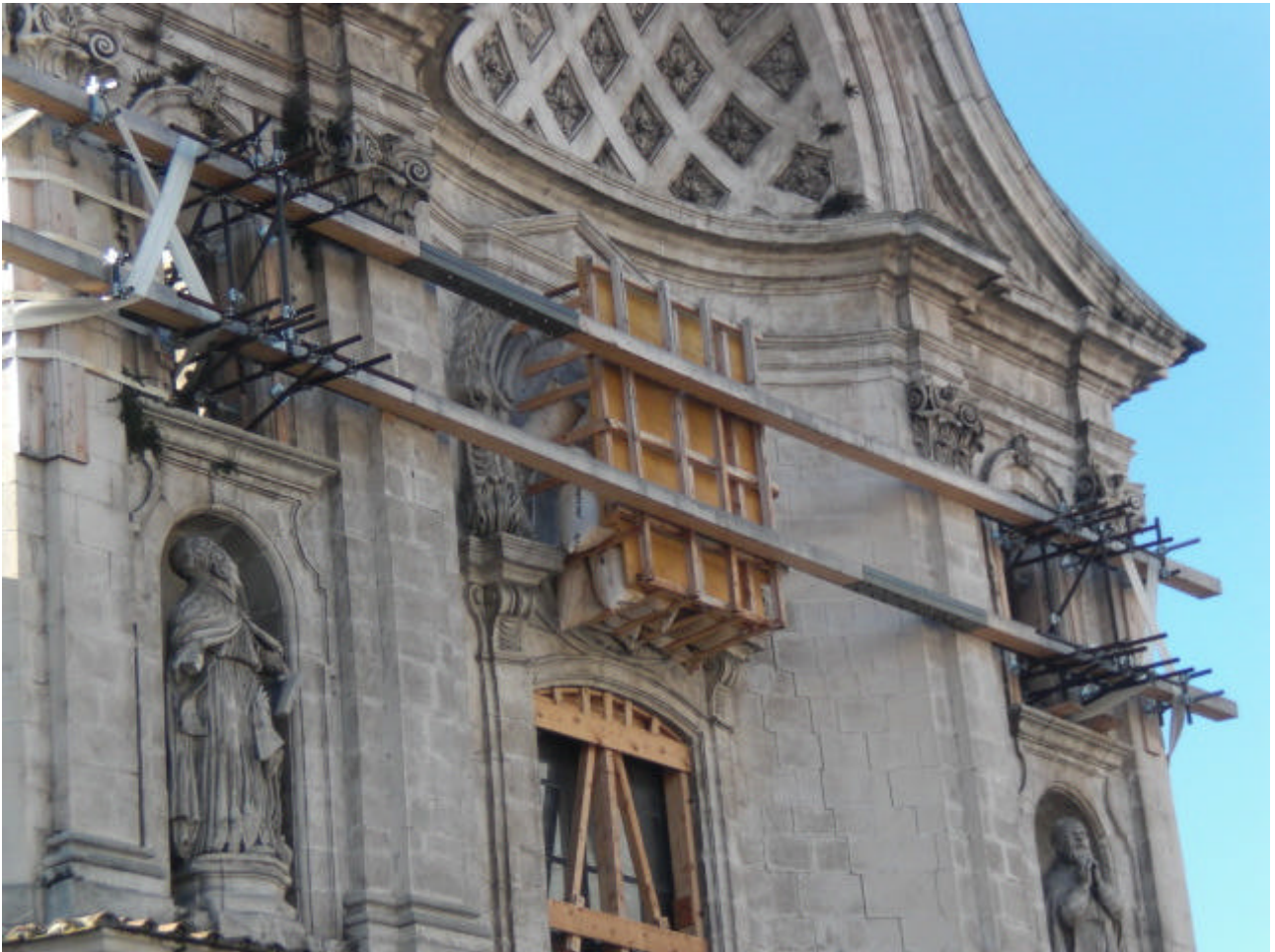
Figura 11 • L'Aquila, chiesa delle Anime Sante: particolare del sistema provvisorio di tiranti. (BUC)
