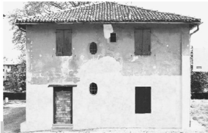
Figura 1 • Rappezzi di varia dimensione e nuova stesura di intonaco nella parte basamentale della facciata. (DEP)
