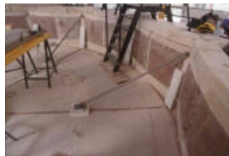
Fig. 13 • Perugia, Fontana Maggiore: il restauro della fontana ha previsto l'impiego di materiali moderni tra cui le FRP e il titanio, utilizzato in sostituzione del ferro piombato originario (già precedentemente soppiantato da elementi d'acciaio) e, sotto forma di lamine, per proteggere le stesse fibre.
