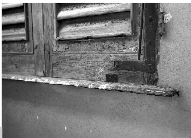
Figura 9 • Persiana in avanzato stato di degradazione (dettaglio).
