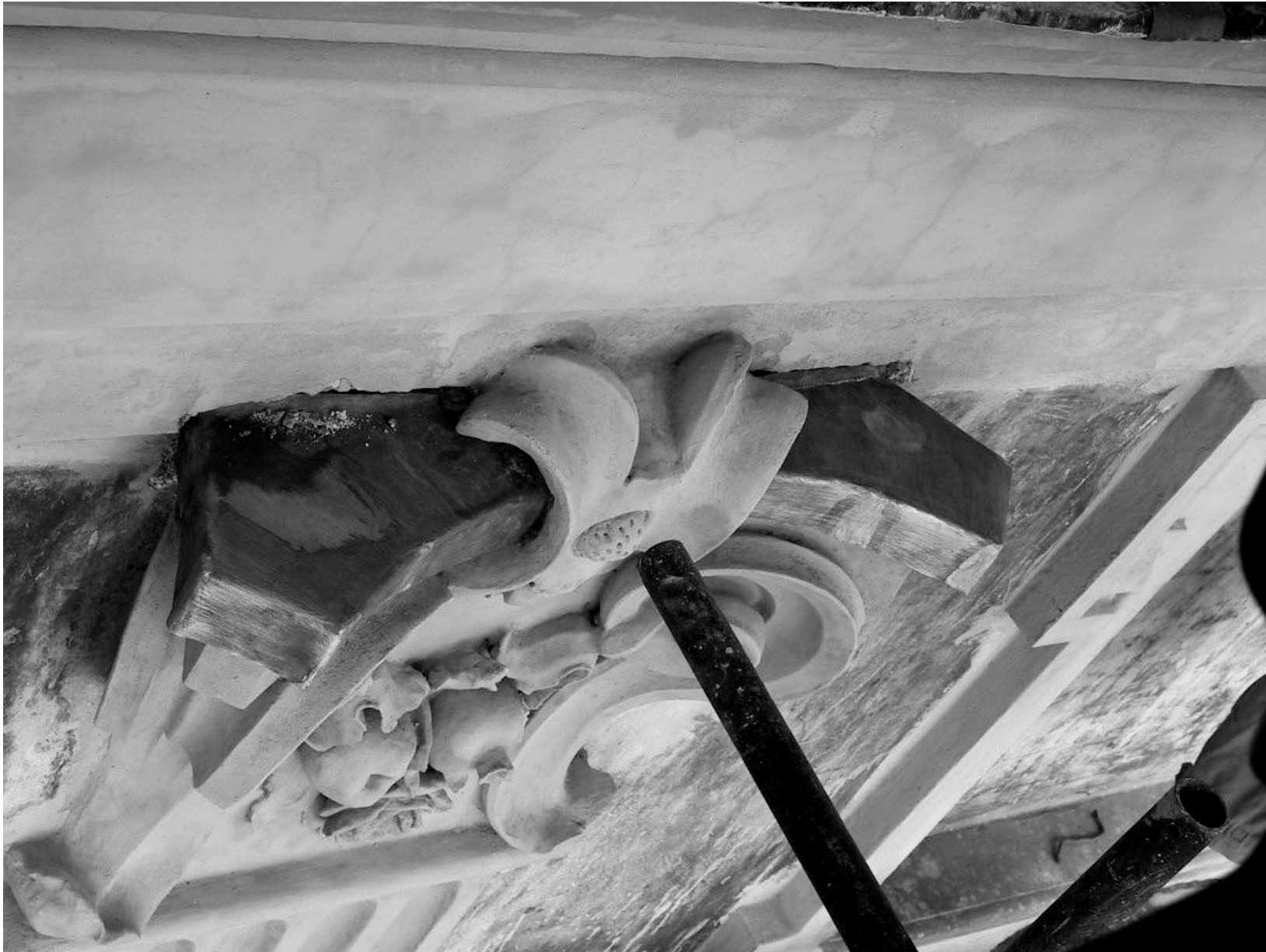
Figura 20 • Protezione di un capitello in stucco ottenuta tramite rivestimento dell'abaco con una lamina di piombo.
