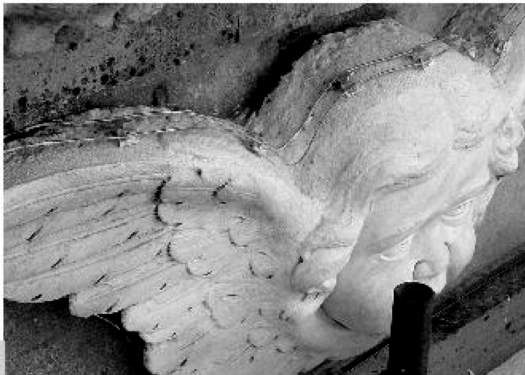
Figura 12 • I conduttori del sistema elettrostatico collocati in una zona non visibile, a protezione di un elemento scultoreo.
