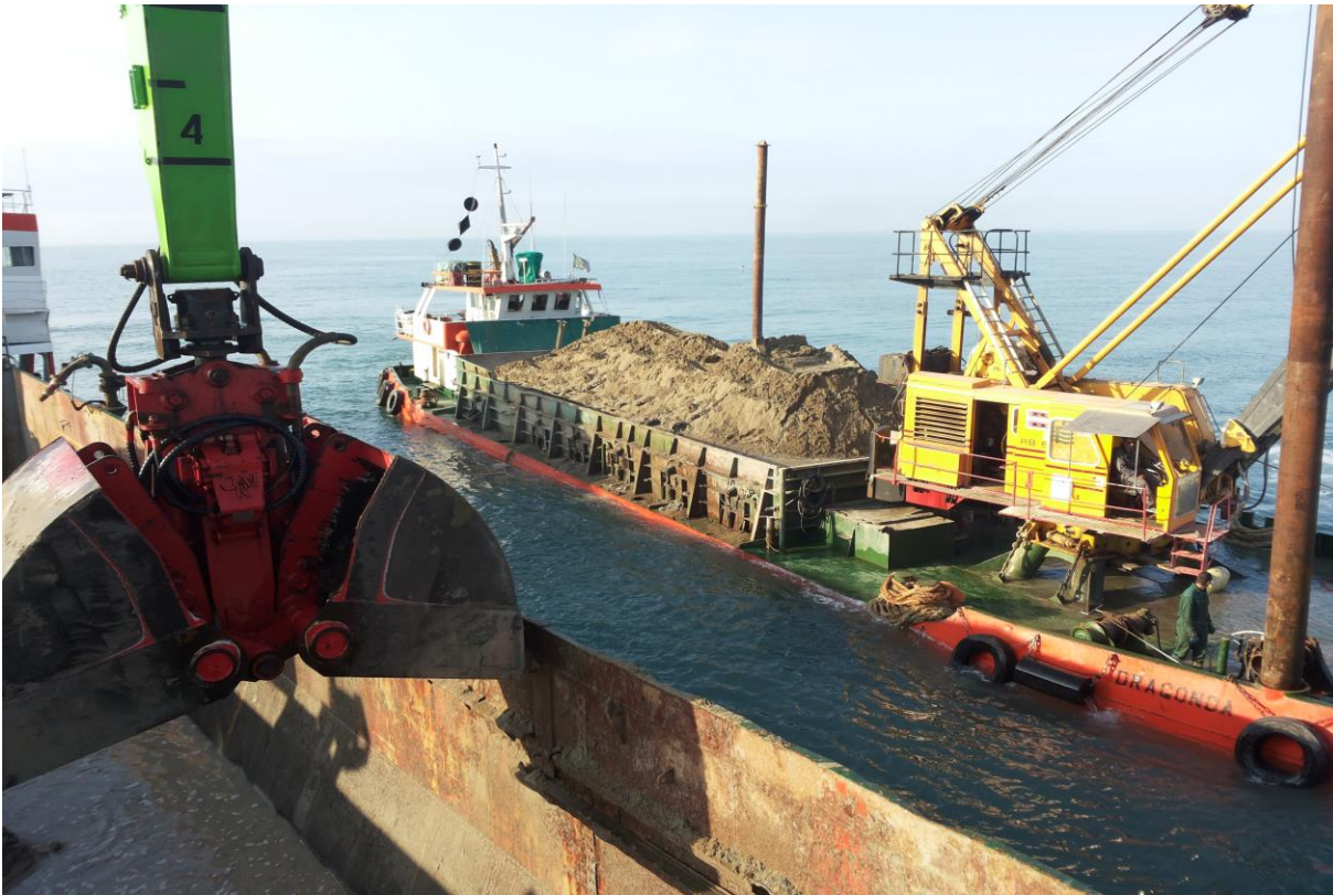
Trasbordo materiale sabbioso da pontone per aumentare la continuità della resa della TSHD
