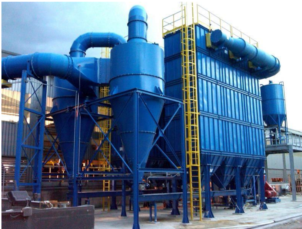
Figura 58 Dispositivo di abbattimento polveri per impiego nell'industria siderurgica. Si notano due cicloni in parallelo seguiti da filtro a maniche.
