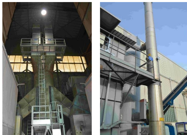
Figura 130 Punti di campionamento sulle capannette (sinistra) e sull'impianto trattamento lamiere (destra)
