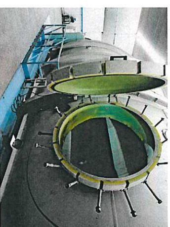
Figura 21 - Foto dell'interno della tank del tandem: si notano il terminale ad alta tensione e la colonna
