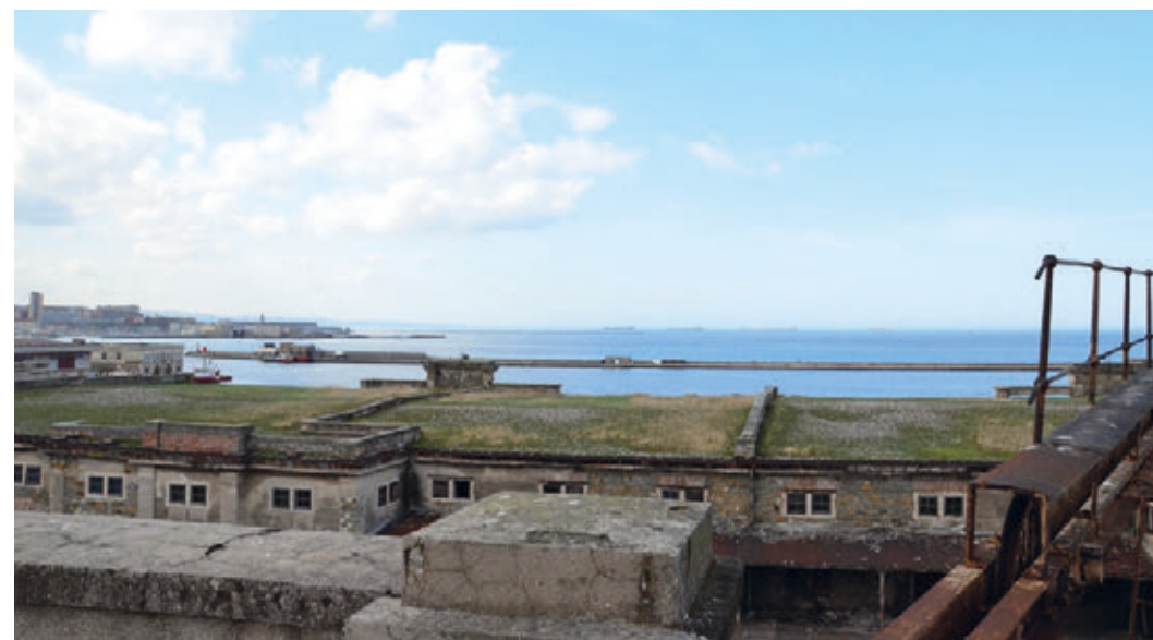
Figura 17 - Copertura di un Magazzino in stato di avanzato degrado con accrescimento spontaneo di specie arboree
