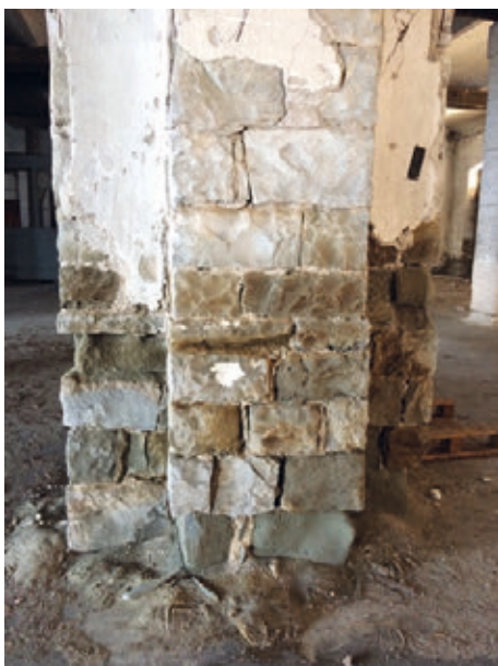
Figura 8 - Pilastro in blocchi di pietra arenaria in cui si evidenziano i blocchi danneggiati dall'azione dell'ambiente salino e la mancanza di blocchi
