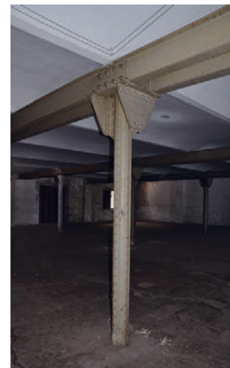
Figura 9 - Colonna in ghisa al secondo piano di un Magazzino, si evidenzia il discreto stato di conservazione
