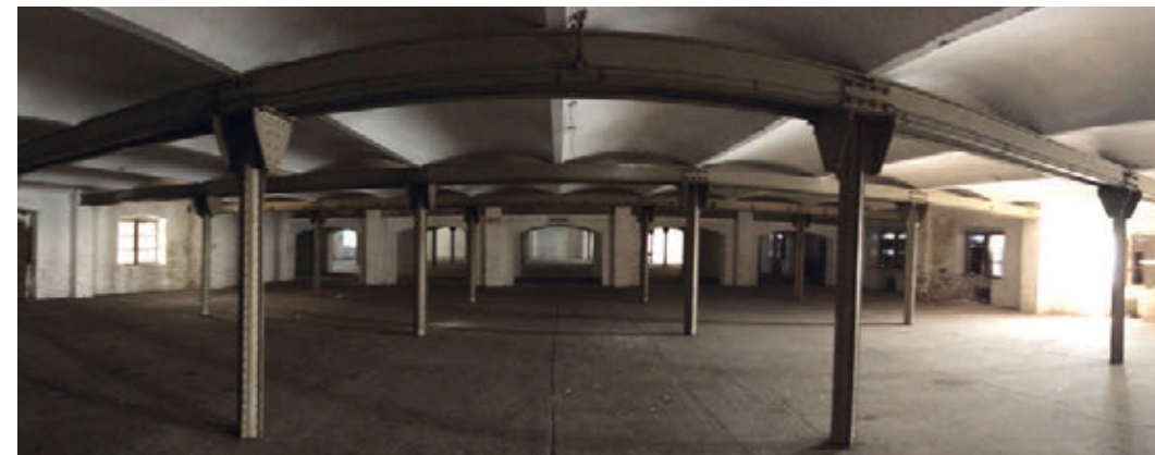
Figura 11 - Lesioni longitudinali presenti sulla soletta superiore degli orizzontamenti interni
