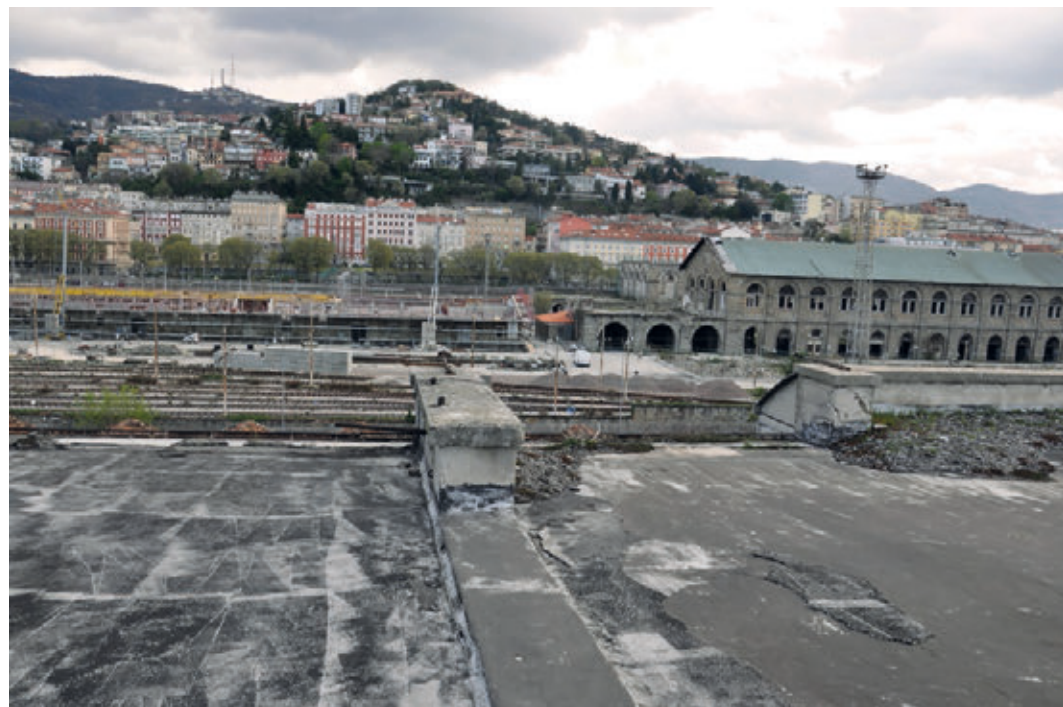
Figura 16 - Copertura di un Magazzino: a sinistra in evidenza lo strato in bitume, mentre sulla destra in evidenza lo strato di scorrimento in sabbia
