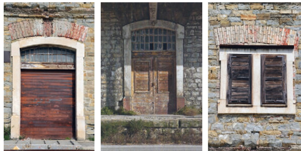
Figura 25 - Stato di fatto di infissi vari di Magazzini e Capannoni del Porto Vecchio
