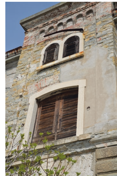
Figura 15 - Distaccamento degli intonaci sull'avancorpo di una facciata di un Magazzino
