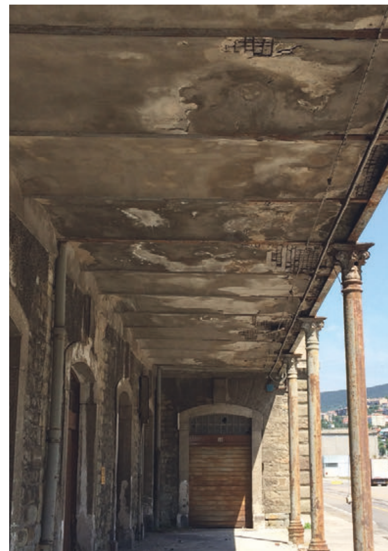
Figura 23 - Avanzato stato di degrado delle solette Monier dei ballatoi esterni: si evidenzia il distacco del copriferro con conseguente esposizione agli agenti atmosferici delle barre
