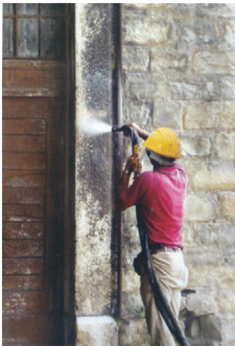
Figura 14 - Procedura di lavaggio acqua in pressione Documenti di un Restauro, Il Magazzino 26 del Porto Vecchio di Trieste
