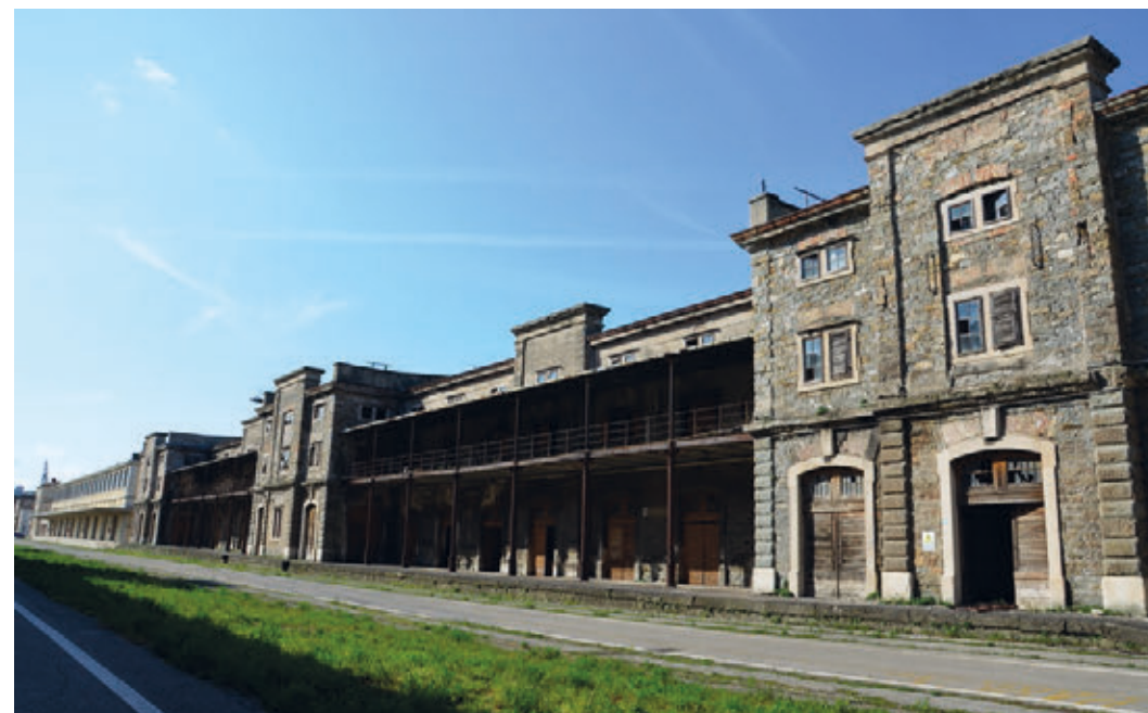
Figura 13 - Capannoni del Porto Vecchio in cui il distacco dell'intonaco lascia a vista le pareti realizzate in blocchi di pietra arenaria
