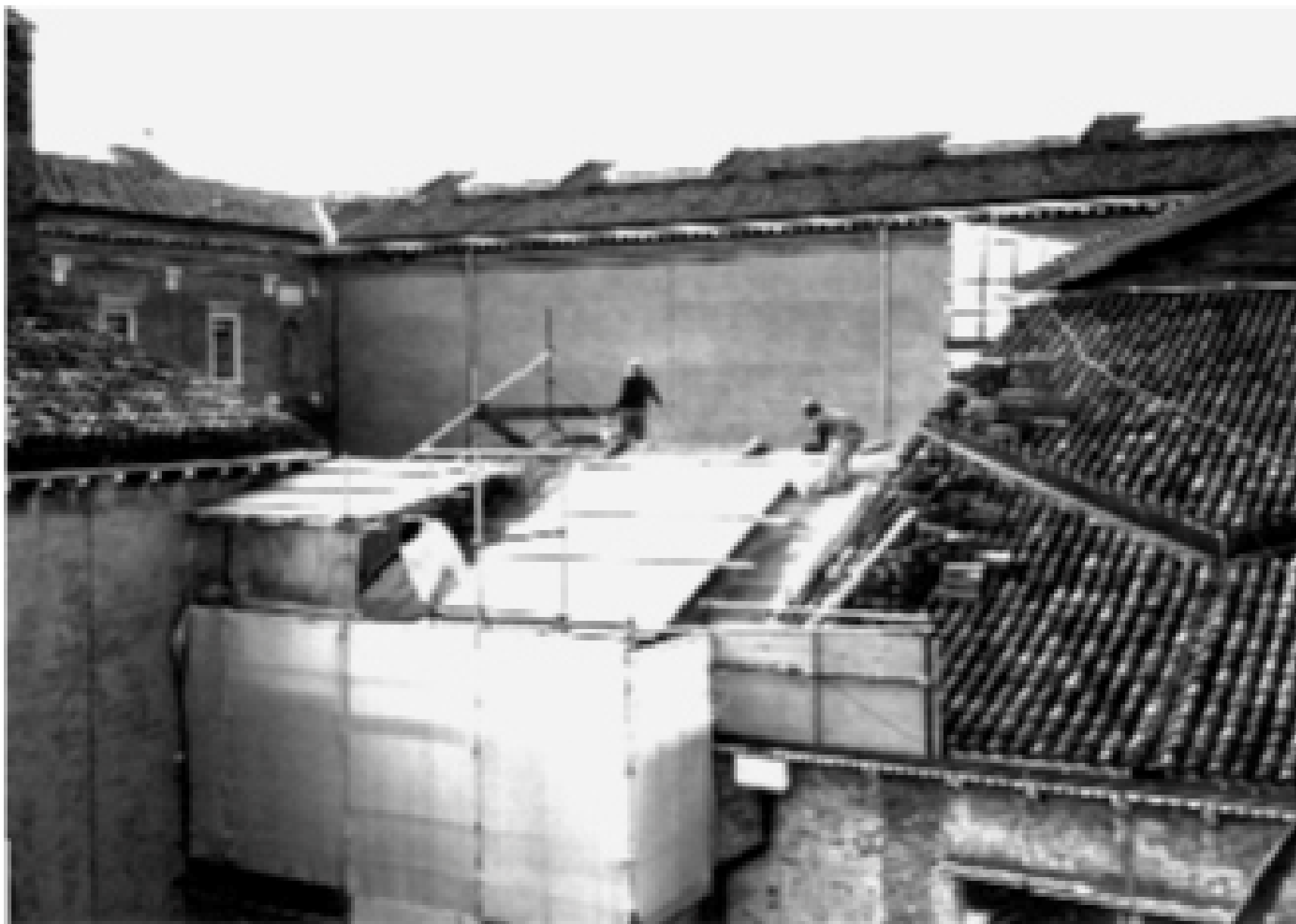
Figura 1 • Smontaggio e rimontaggio di un manto di copertura. Si notino, a sinistra, le coperture provvisorie e, a destra, alcuni coppi accatastati in attesa di essere ricollocati.
