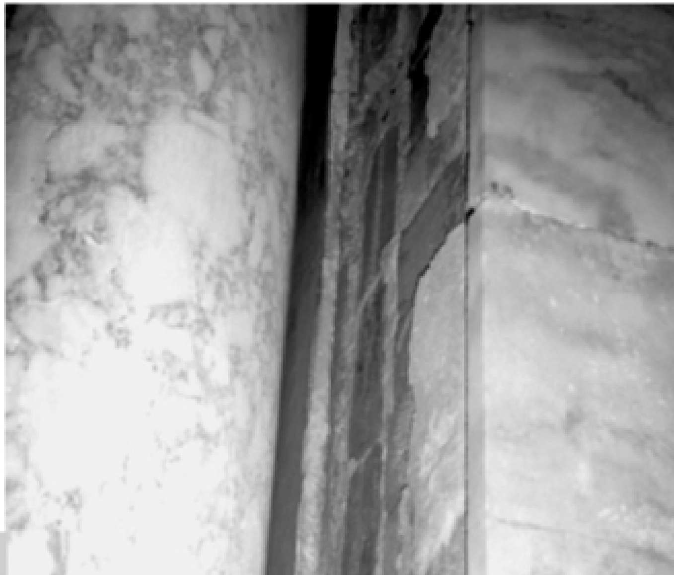
Figura 1 • Lo smontaggio delle lastre marmoree di rivestimento scopre il sottostante paramento in mattoni. Si noti come le lastre del fianco siano montate a filo del paramento murario, in modo tale che lo spessore del rivestimento sia nascosto da quelle poste sulla veduta frontale.
