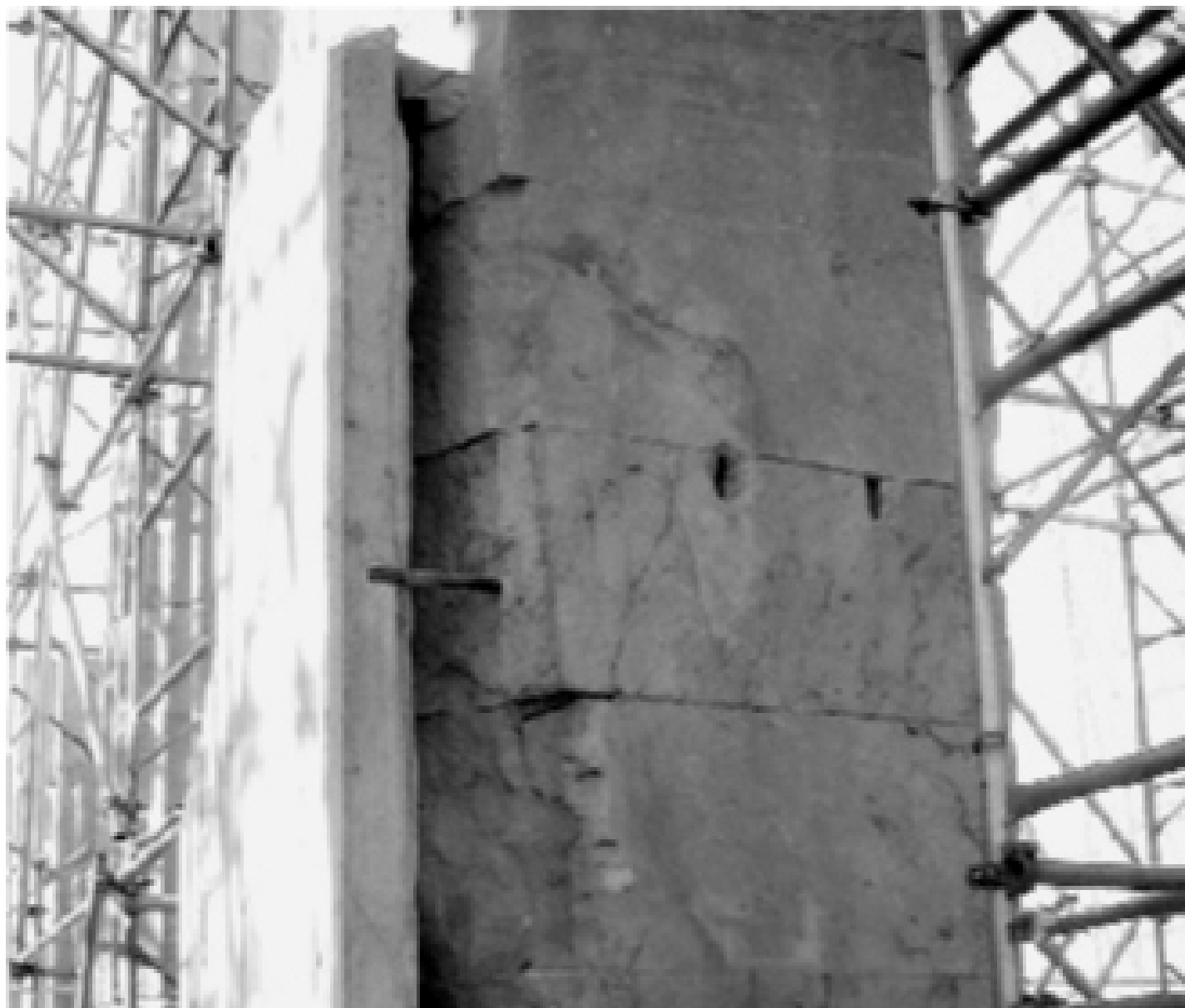
Figura 2 • Un lastrone di rivestimento è rimontato per anastilosi all'interno di un cantiere di restauro archeologico.
