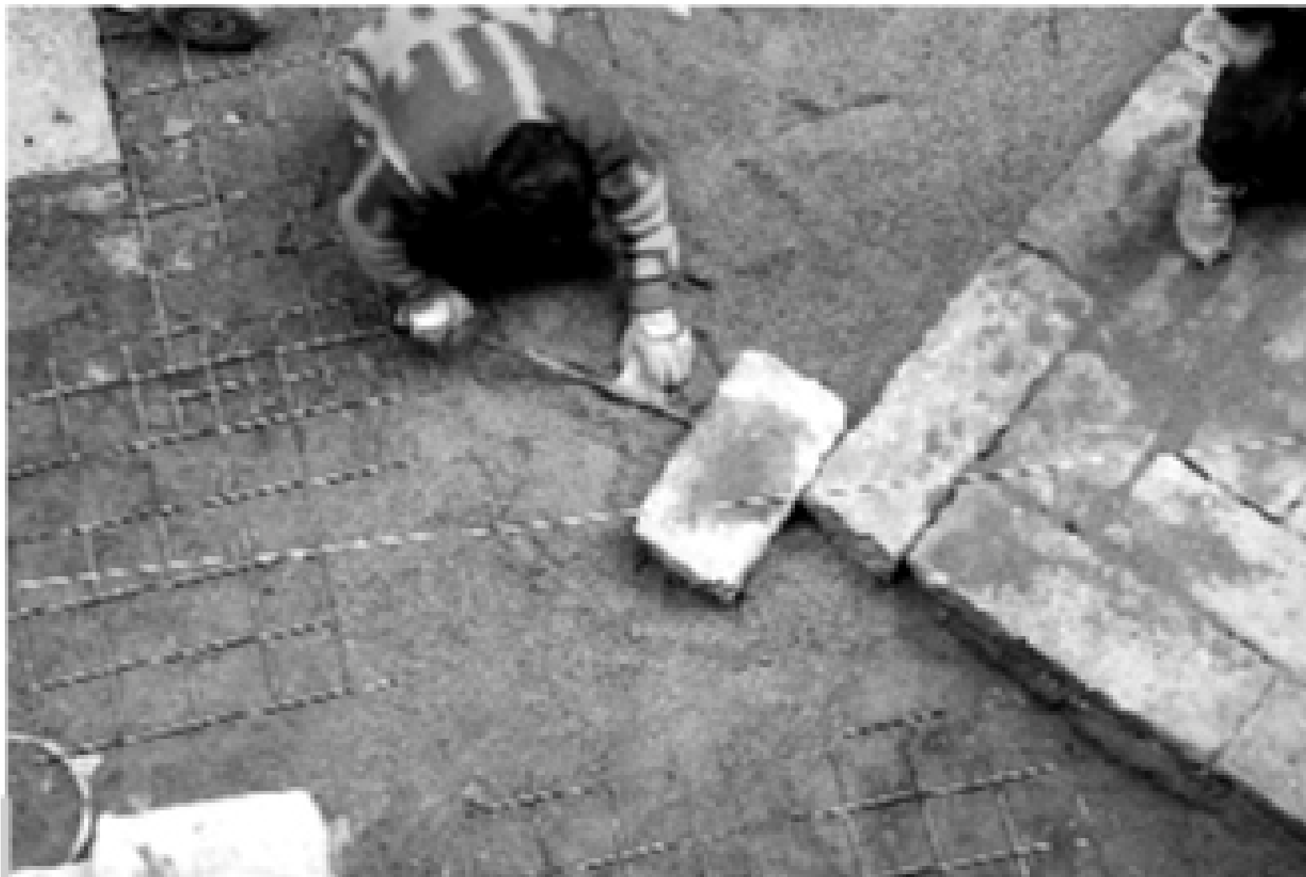
Figura 12 • Posizionamento corretto di un blocco, con l'aiuto di una lenza di allineamento e di una leva.
