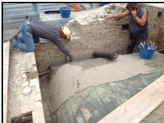
Figura 2.2 – Rinforzo estradosale di volta in foglio mediante placcaggio diffuso con rete in fibra di basalto installata con malta a base di calce idraulica.
