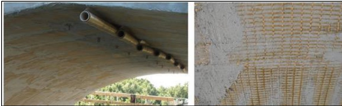
Figura 2.22 – Rinforzo intradossale di un ponte ad archi in calcestruzzo con reti di PBO.
