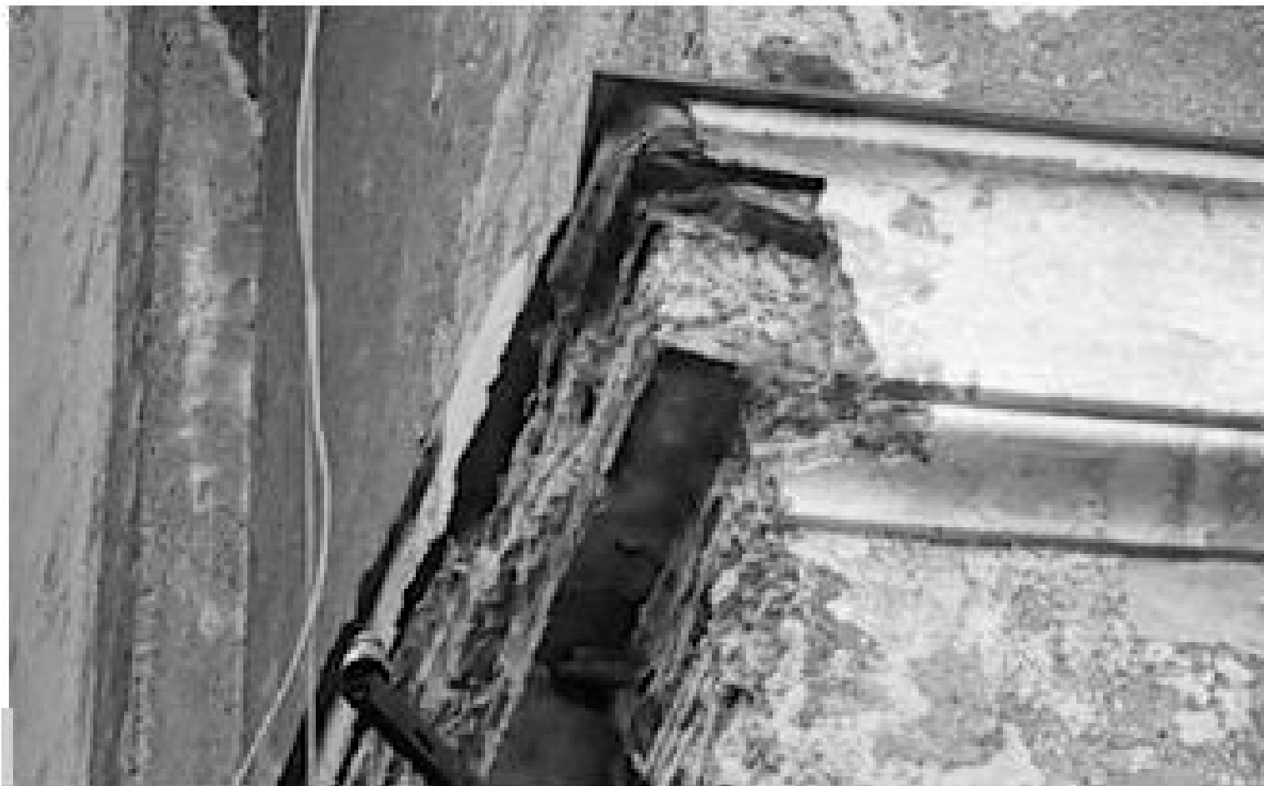
Figura 1 • Cornice marcadavanzale in stucco. La mancata riparazione o sostituzione della copertina di ardesia, posta a protezione della cornice, ha consentito alle acque meteoriche di compromettere l'integrità del rivestimento in stucco e del supporto in mattoni.
