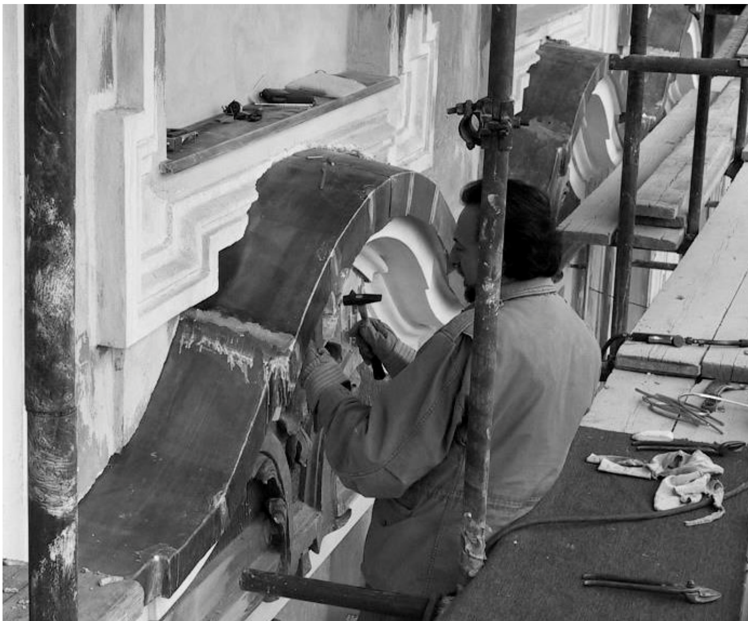
Figura 8 • Lattoniere durante la posa in opera di copertine in piombo a protezione dell'estradosso della cornice di un timpano polilineo.
