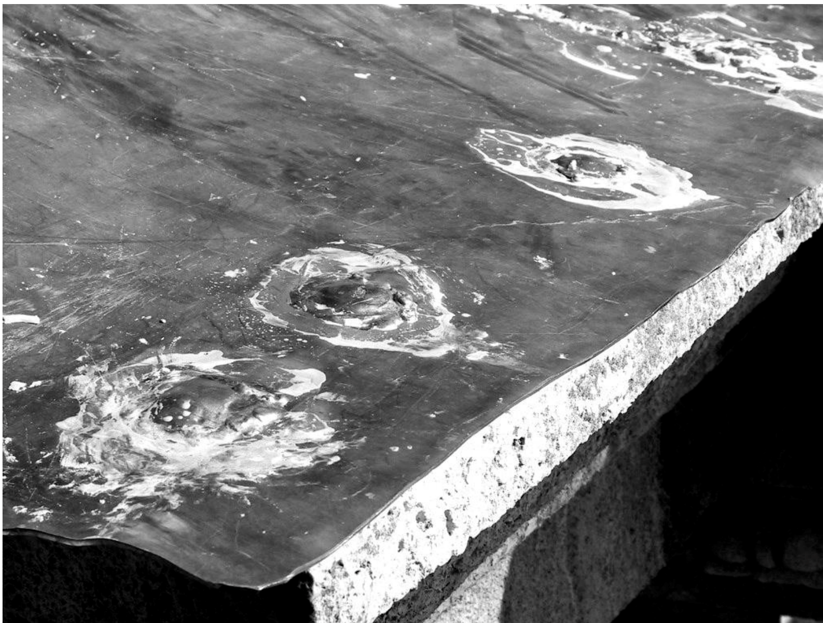
Figura 19 • Rivestimento delle teste delle viti a espansione e relative rondelle, con dischetti in lamina di piombo saldati, per evitare possibili infiltrazioni d'acqua.
