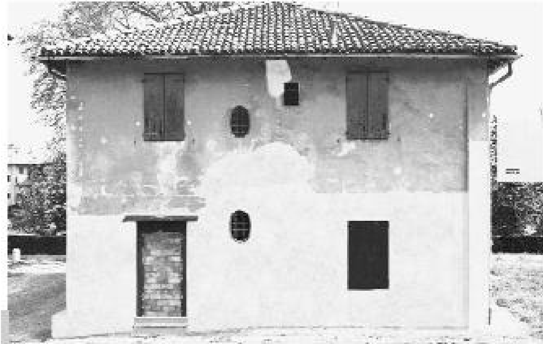
Figura 1 • Rappezi di varia dimensione e nuova stesura di intonaco nella parte basamentale della facciata.
