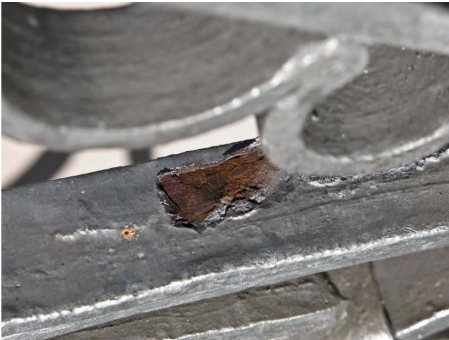
Figura 9 • Villa Barbaro a Maser. Cancellò seicentesco. Particolare della discontinuità della zincatura. Il ferro preindustriale è incompatibile con la zincatura che si stacca a scaglie lasciando scoperto il vecchio metallo. (TORSELLO)
