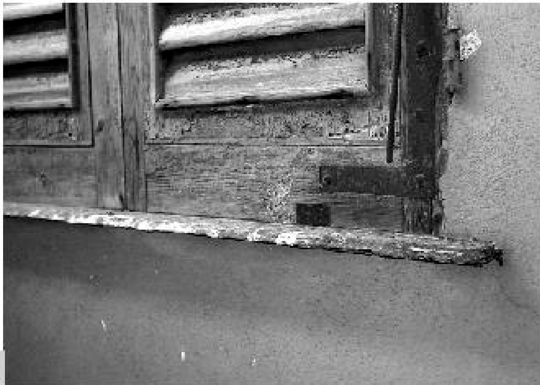
Figura 9 • Persiana in avanzato stato di degradazione (dettaglio).
