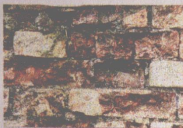
Erosione della muratura e delle malte nel lato nord
