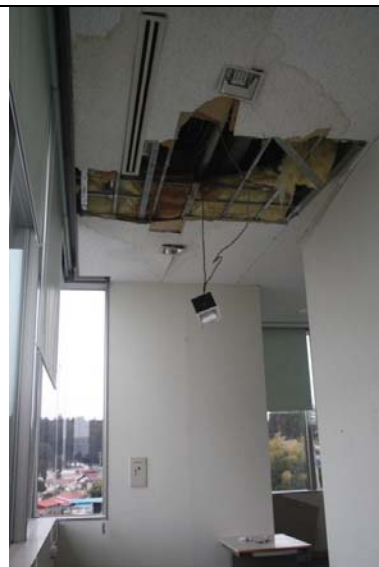
(d) Fall of ceiling of Municipal Assembly Hall (2)
