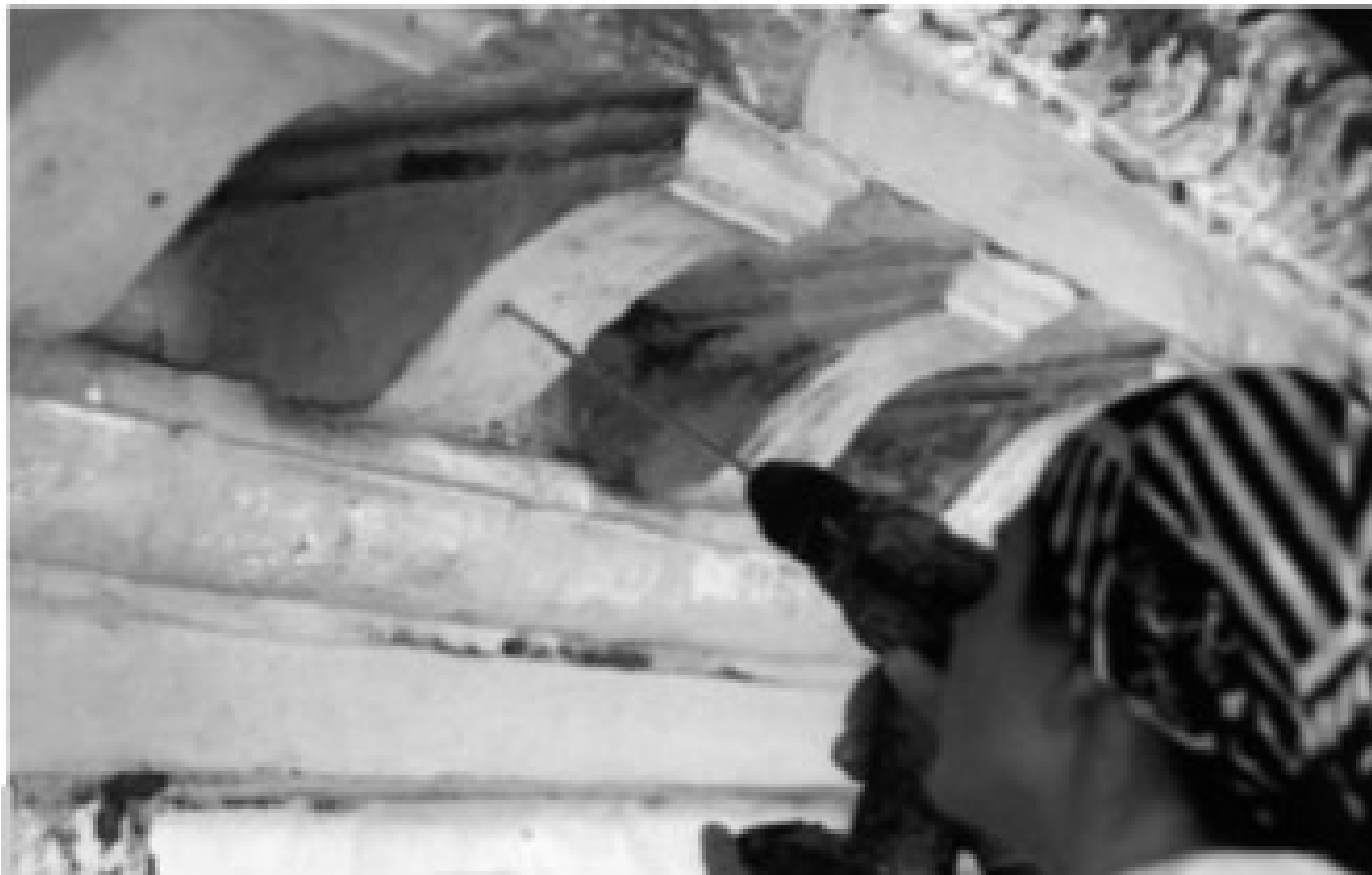
Figura 3 • Mensole di stucco. L'operatrice pratica un foro per l'inserimento di un perno.
