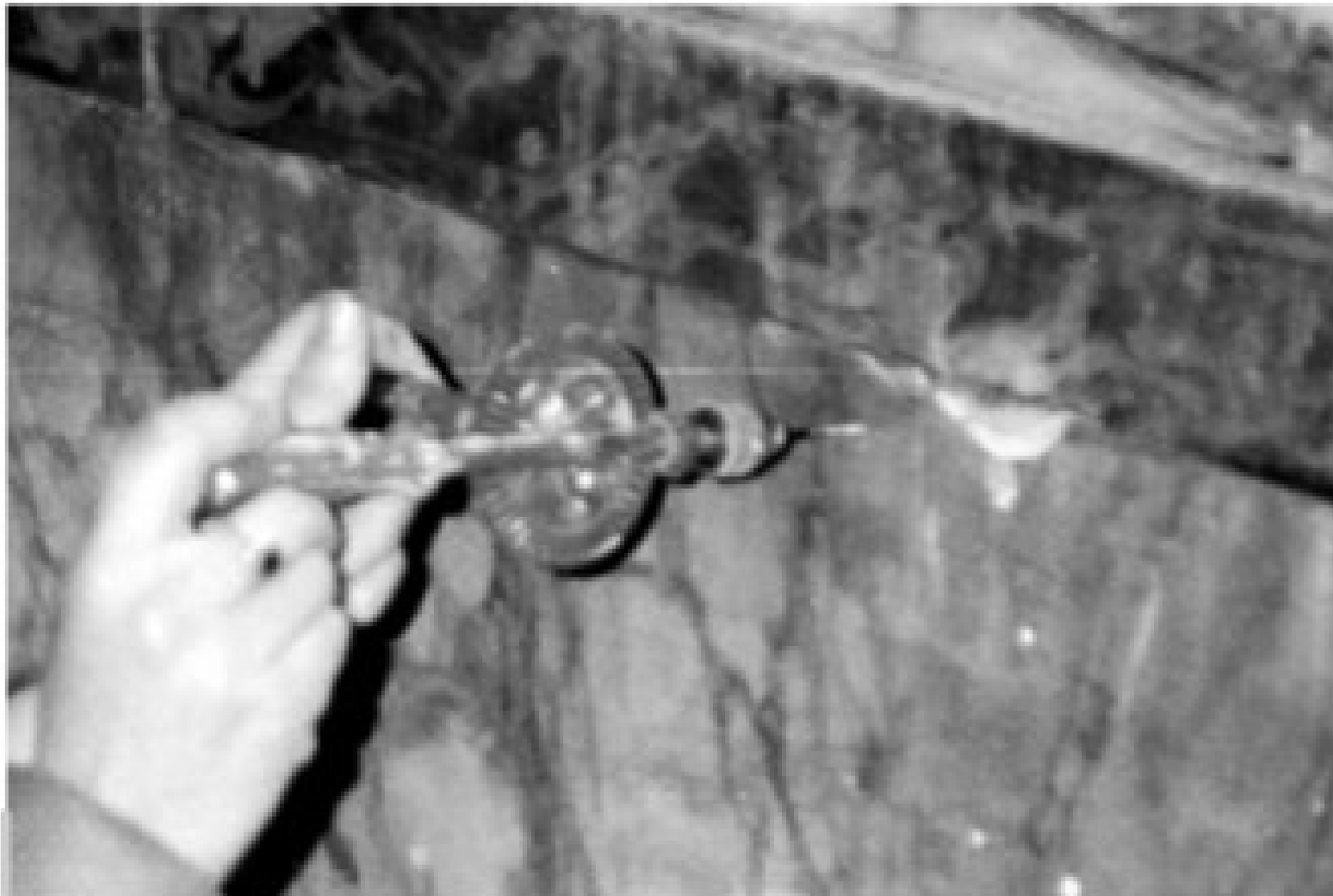
Figura 2 • Esecuzione del foro, con trapano manuale a rotazione, per l'iniezione del consolidante.
