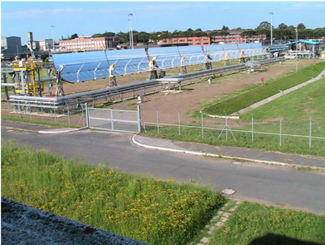
Figura 27 - Impianto PCS, Centro Ricerche ENEA Casaccia
