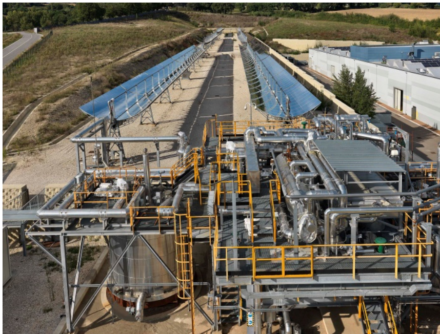
Figura 41 - Vista del sistema di generazione del vapore
