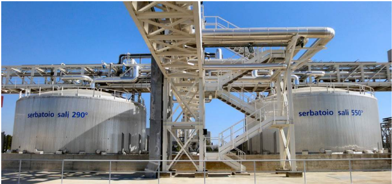
Figura 36 - Sistema di accumulo termico (serbatoio freddo e caldo) dell'impianto Archimede
