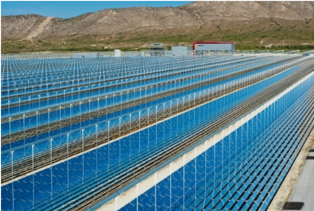
Figura 6 - Impianto solare di Puerto Errado 2, Spagna
