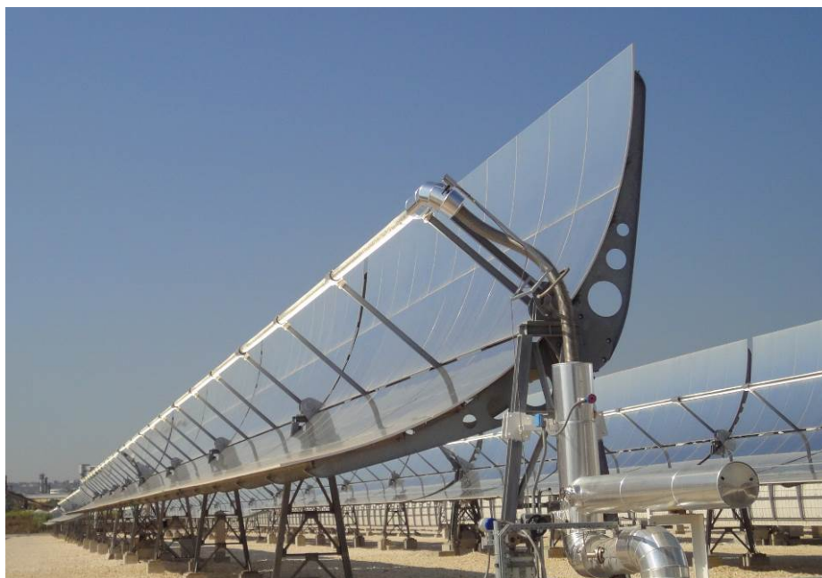
Figura 35 - Collettori solari dell'impianto Archimede
