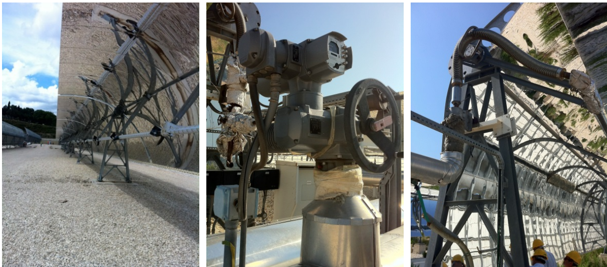
Figura 74 - CSP SAREA: collettore lineare, valvole per sali fusi e tubazioni flessibili presso l'impianto ASE
