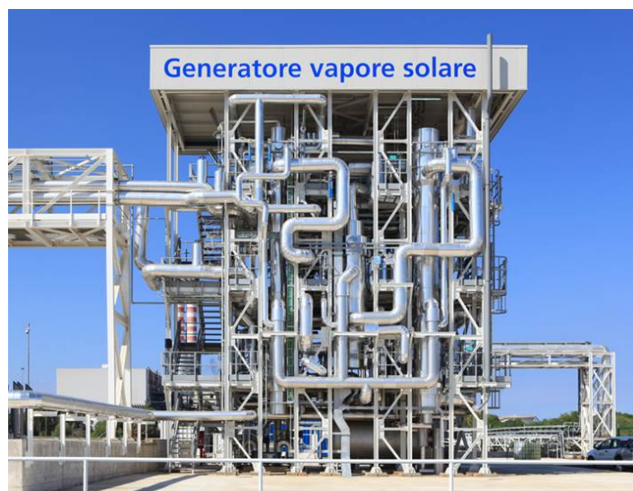
Figura 37 - Generatore di vapore dell'impianto Archimede
