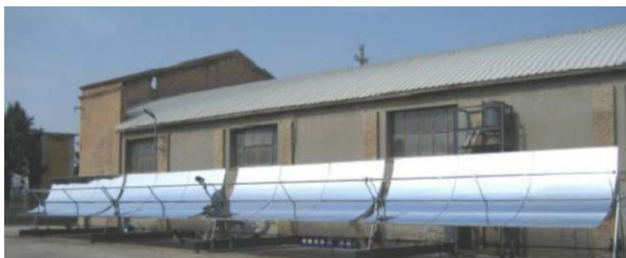
Figura 22 - Collettori per l'impianto pilota di solar cooling di Soltigua
