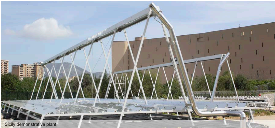
Figura 31 - Vista dell'impianto solare STS-Med Università di Palermo
