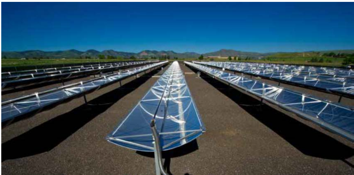
Figura 18 - Collettori solari parabolici per calore di processo PT-1 – Abengoa di Minera El Tesoro
