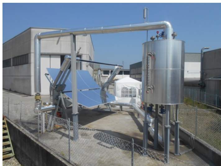
Figura 69 - Impianto sperimentale per la caratterizzazione del modulo base Ronda HT
