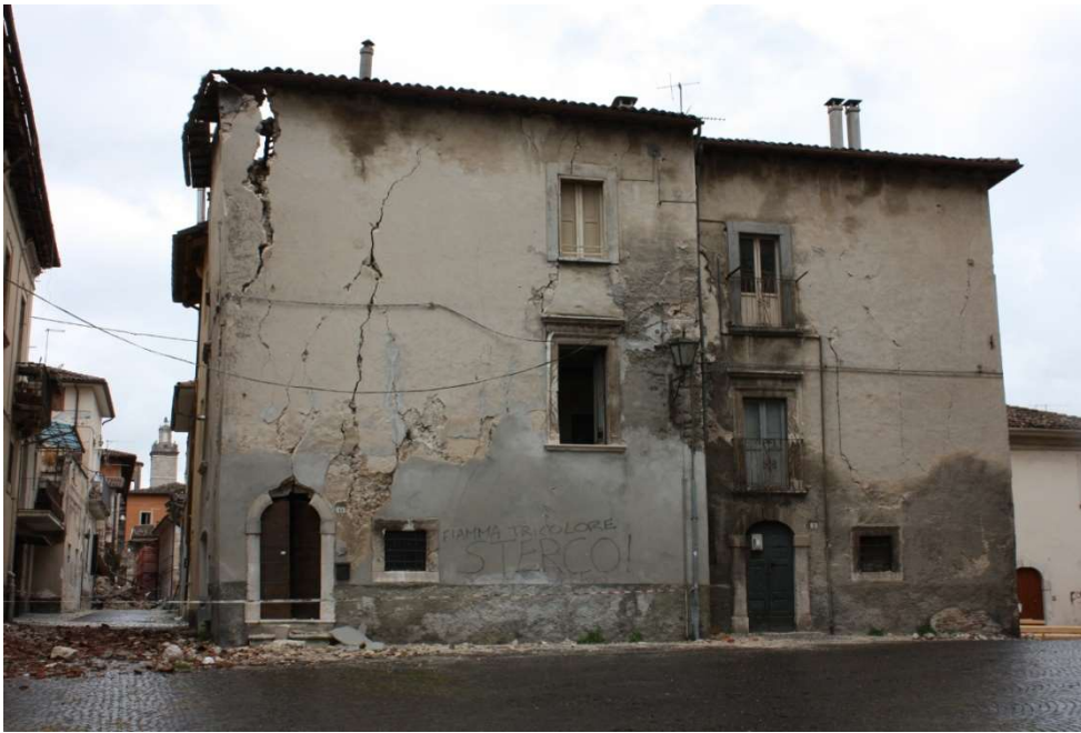
L'Aquila 2009 Separazione parete all'intersezione con quella perpendicolare
