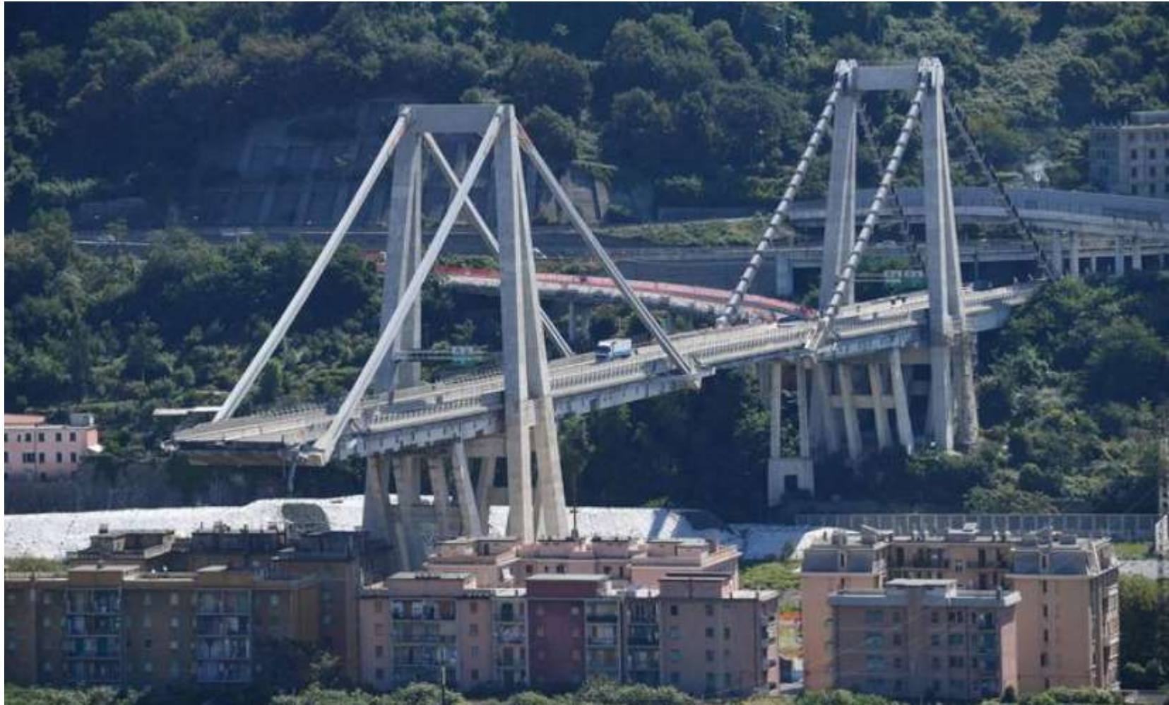
Viadotto sul Polcevera – Genova (ago. 2018)
