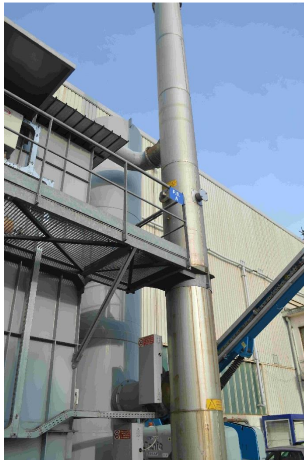
Figura 5 Punto di prelievo su condotto verticale
