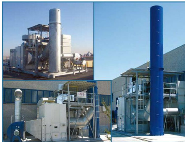
Figura 110 Impianti di abbattimento con rotoconcentratore
