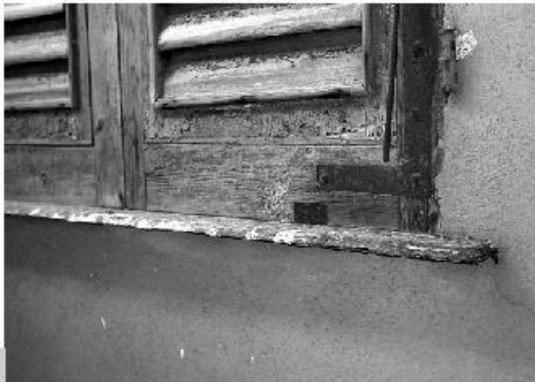
Figura 9 • Persiana in avanzato stato di degradazione (dettaglio).
