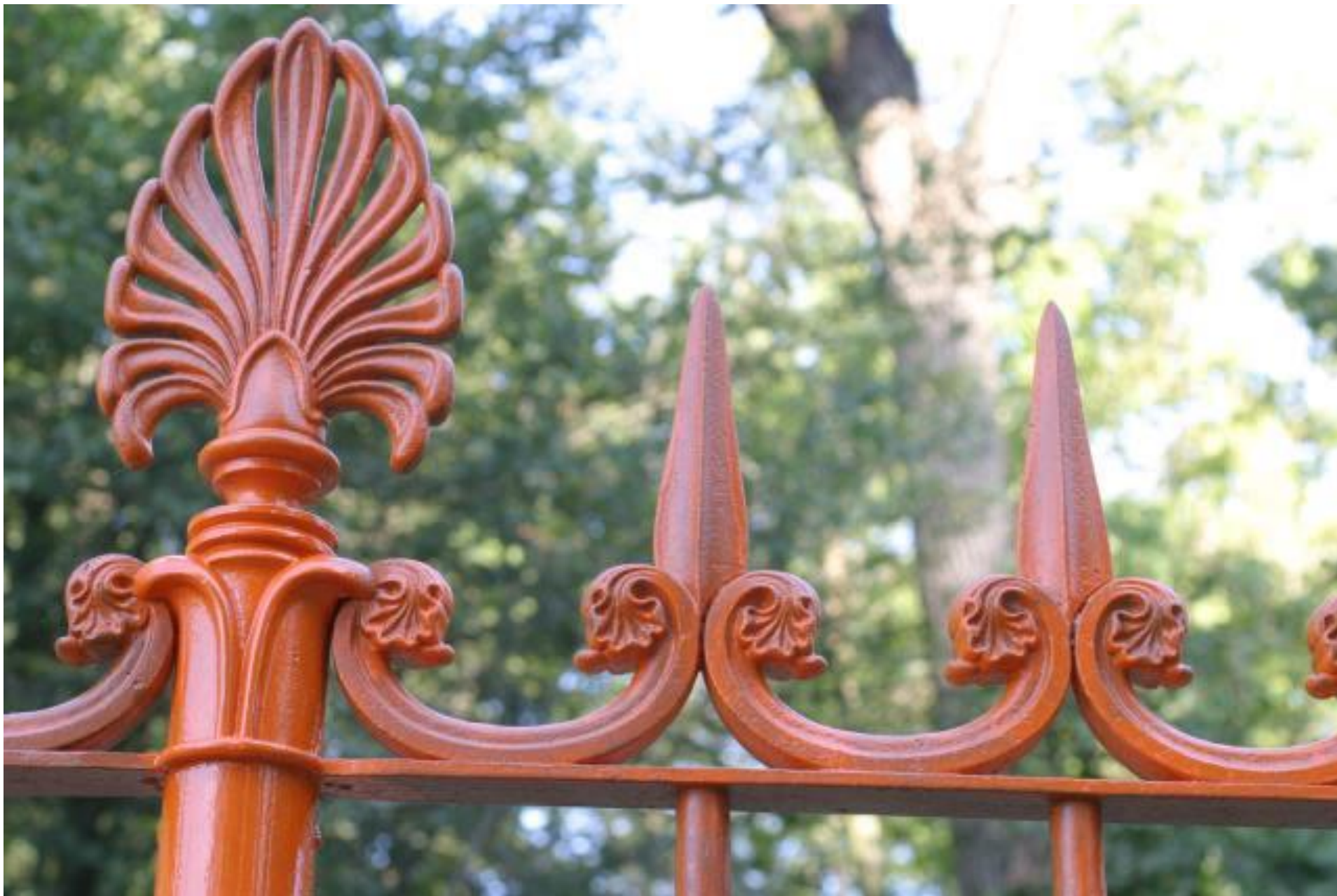
Figura 5 • Particolare della prima mano di minio su superficie sabbiata di una palmetta della cancellata.
