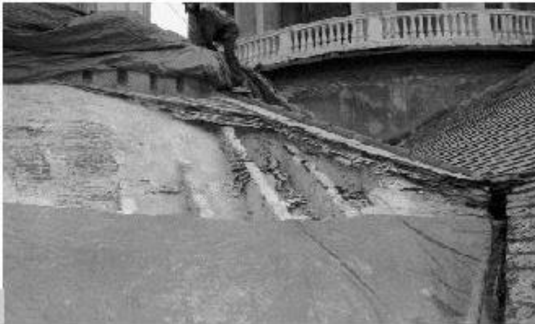
Figura 1 • Teloni di protezione su una cupola minore dell'Assunta di Carignano a Genova. Si notino i muricci in mattoni di supporto al rivestimento in abbadini d'ardesia e di mediazione tra la superficie curva dell'estradosso della cupola e la superficie piana del manto di rivestimento stesso.
