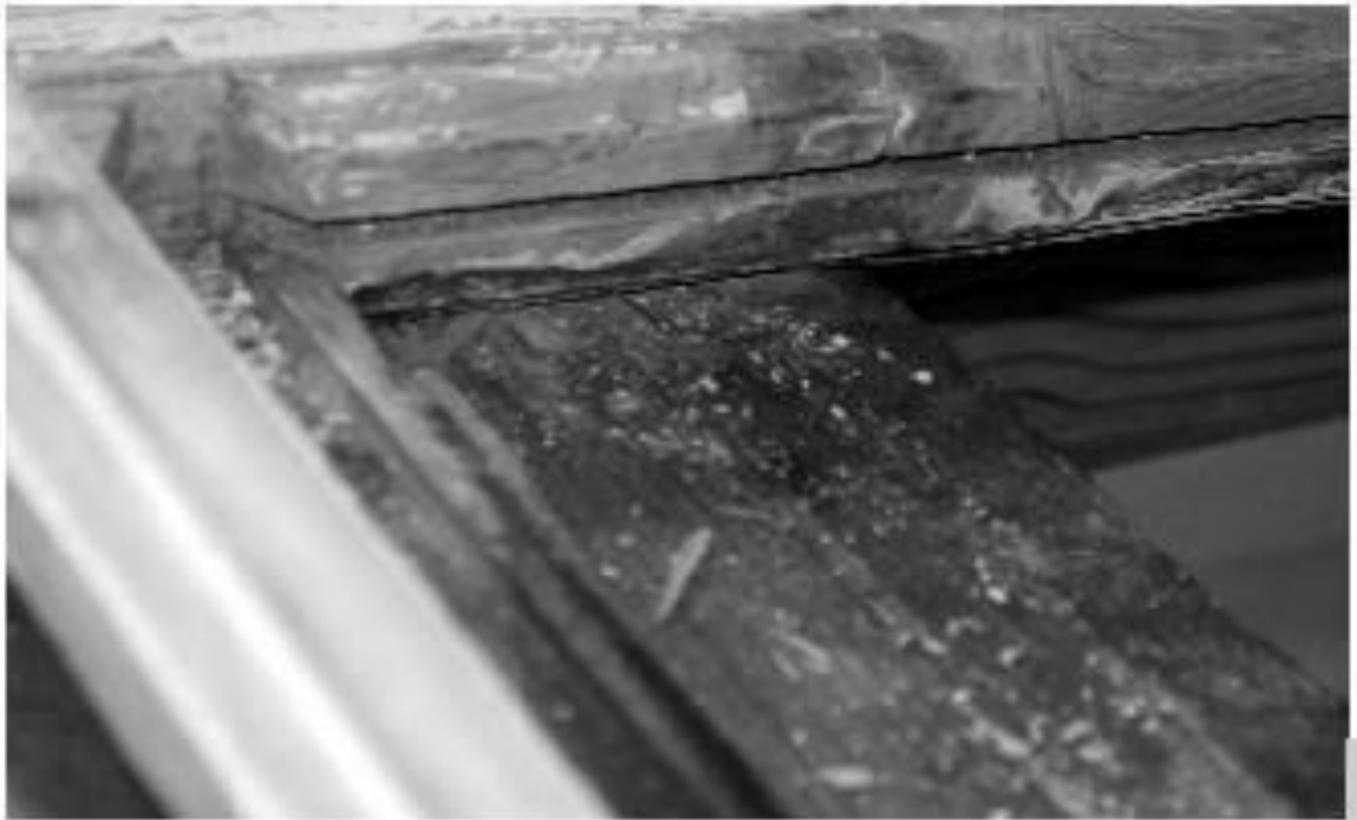
Figura 3 • Sede del vetro a infilare, dopo la rimozione della lastra e l'inizio della pulitura.
