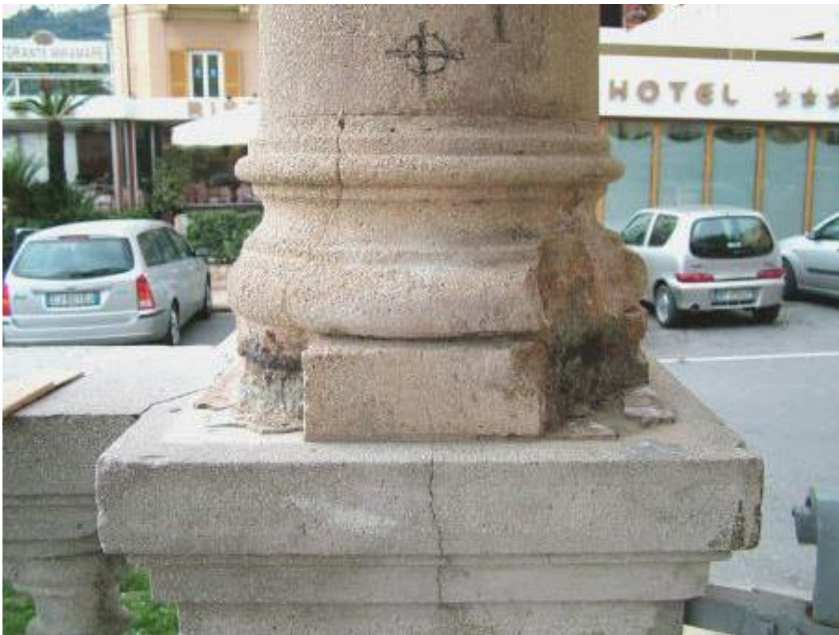
Figura 15 • Mancanze in un basamento in pietra artificiale.
