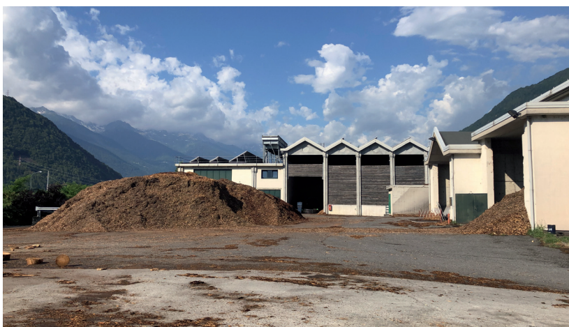
Figg. 5.9 e 5.10 - Impianto di teleriscaldamento a biomassa di TCVVV SpA. Fonte: Luca Tricarico
