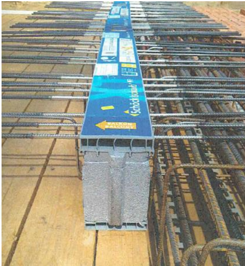
A sinistra, armatura della trave di bordo. A destra, armatura di ripresa per soletta a sbalzo.
