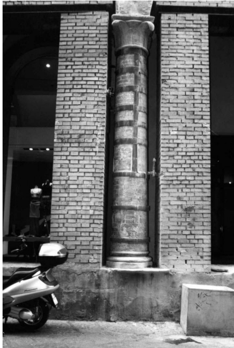
Figura 3 • Colonna in mattoni con base e capitello in pietra, stretta da numerose cerchiature lungo tutto il fusto. Ai lati, due pilastri di mattoni scaricano, parzialmente, la colonna dal peso delle strutture sovrastanti.
