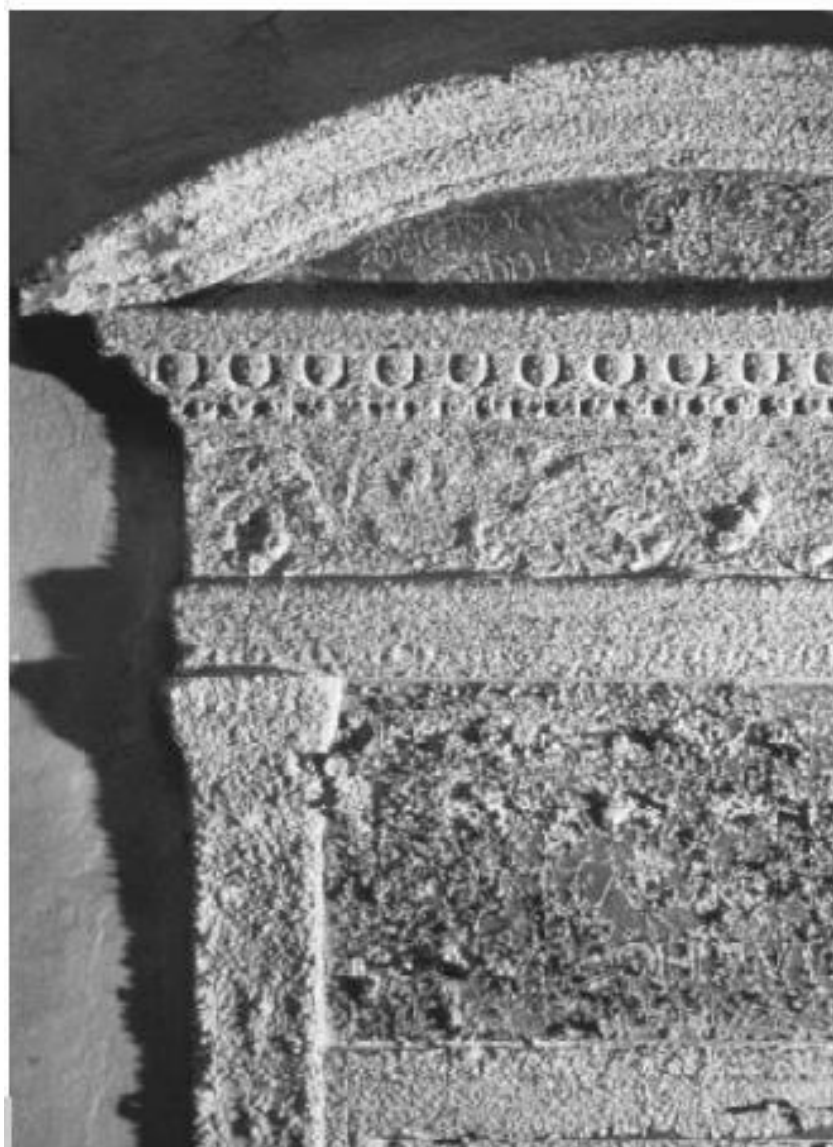
Figura 1 • Superficie lapidea fortemente decoesa sulla quale sono necessari interventi di pulitura che potrebbero essere incompatibili con la fragilità della superficie stessa e determinare perdite o distacchi irreversibili di materiale.
