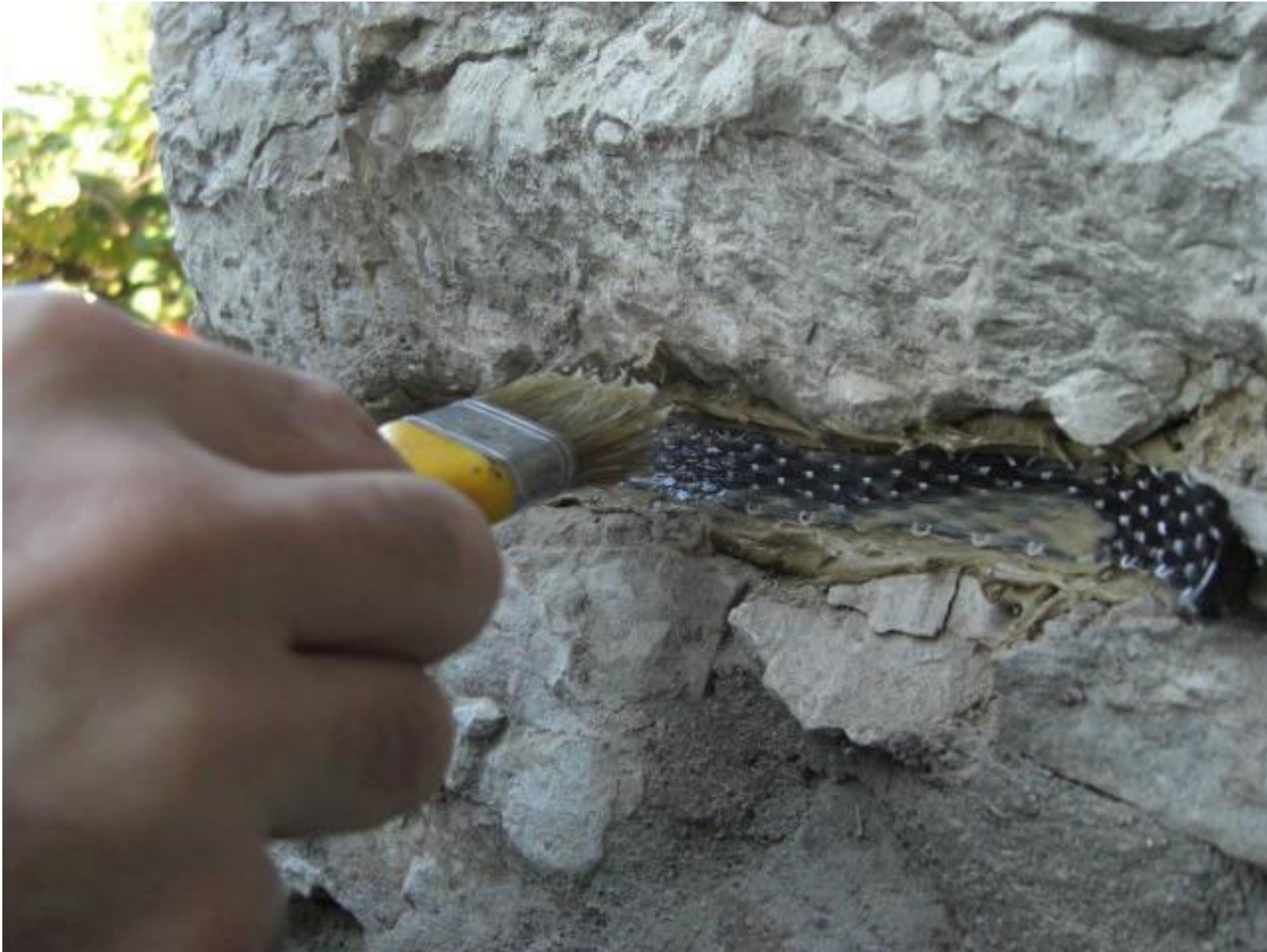
Figura 16d • Fasciatura inserita nei giunti di malta. Saturazione dei nastri in fibra in carbonio con resina epossidica fluida.
