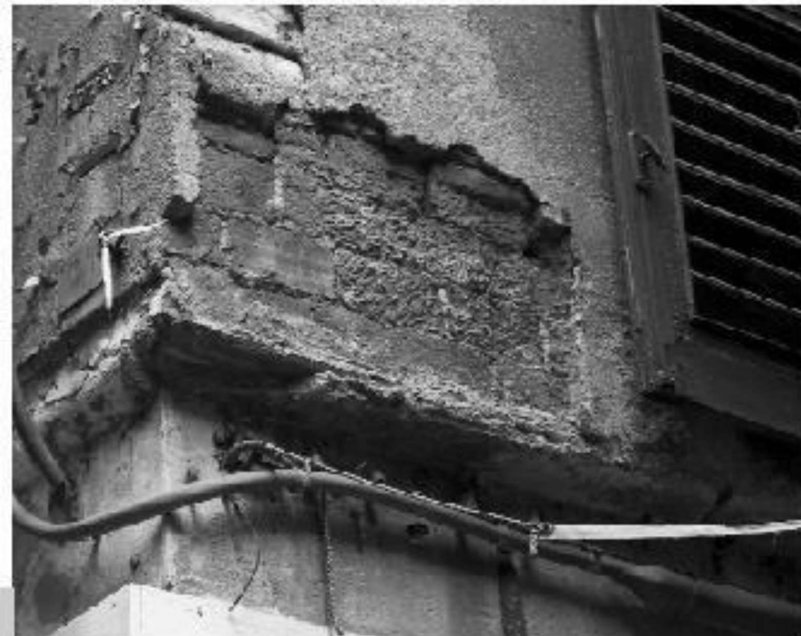
Figura 1 • Perdita di un tratto d'intonaco della facciata.
