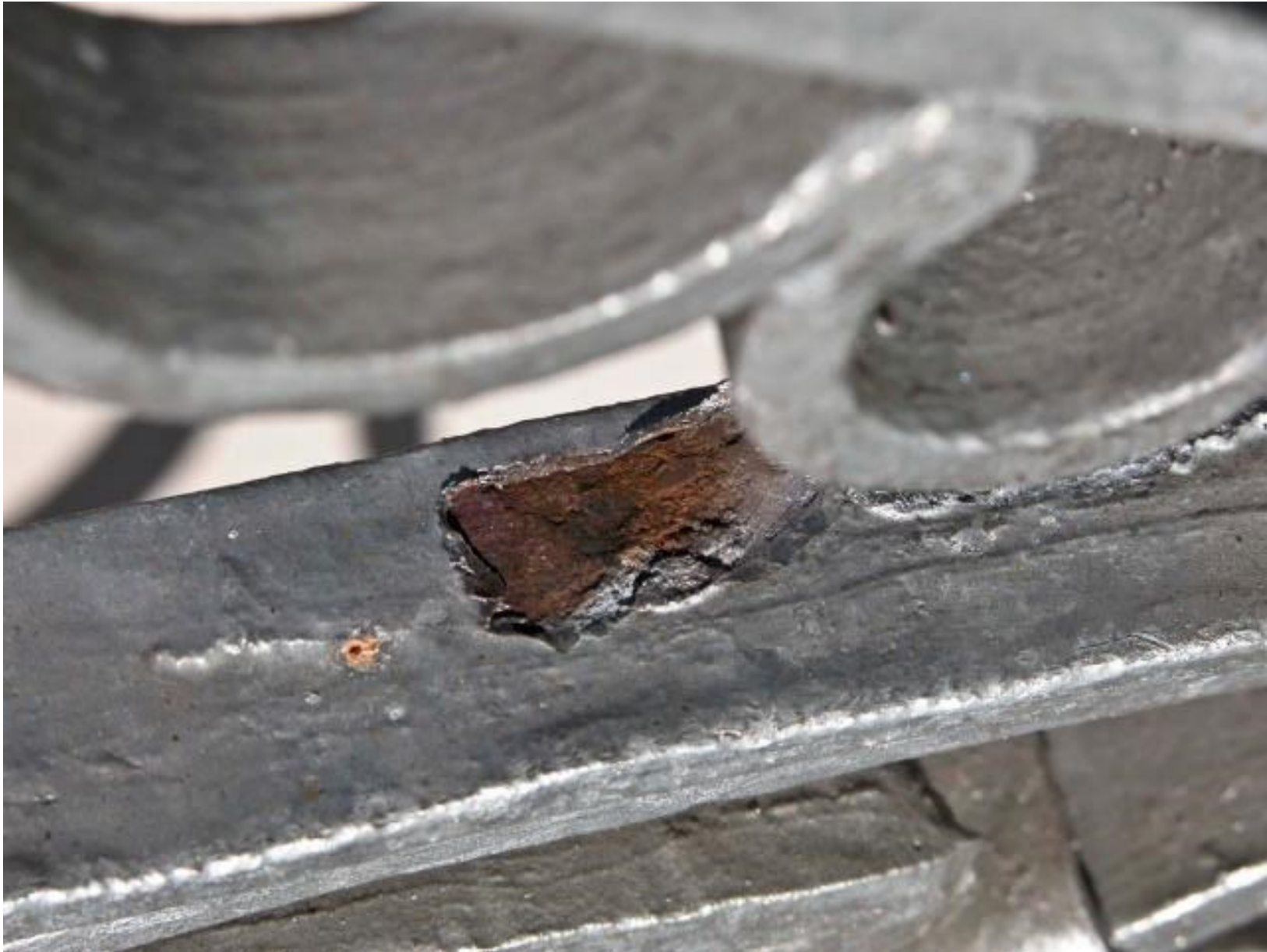
Figura 9 • Villa Barbaro a Maser. Cancelli seicentesco. Particolare della discontinuità della zincatura. Il ferro preindustriale è incompatibile con la zincatura che si stacca a scaglie lasciando scoperto il vecchio metallo.
