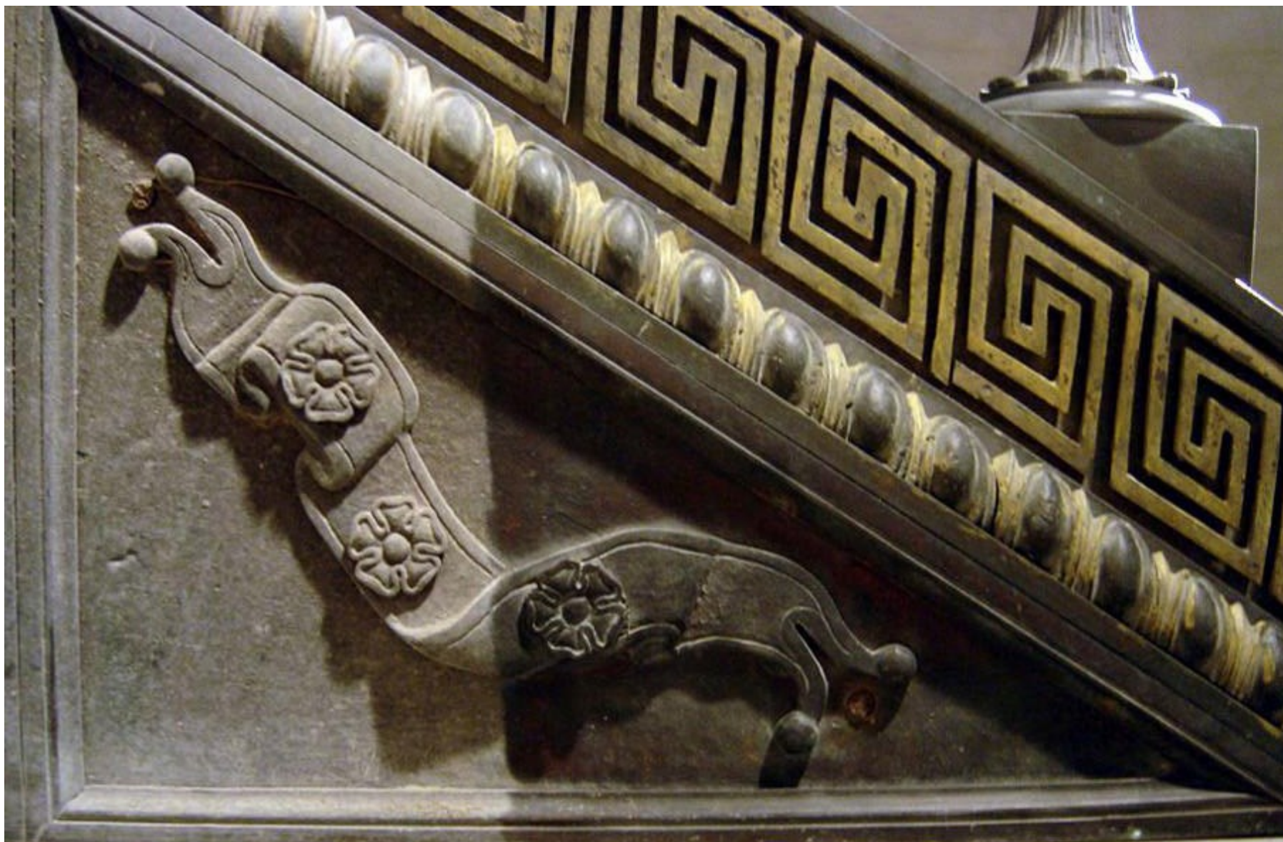
Figura 3 • Palazzo Nobile di Villa Torlonia (Roma). Particolare di una formella della ringhiera durante la stesura del protettivo a base di resina acrilica e benzotriazolo. Il protettivo oltre a proteggere il metallo dalla corrosione, esalta le decorazioni.
