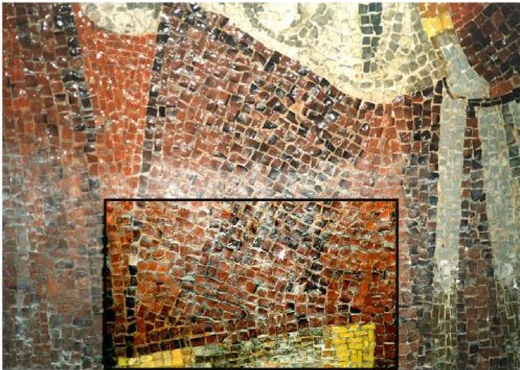
Figura 9 • Particolare di mosaico parietale prima della simulazione della pulitura (desalinizzazione). La superficie delle tessere si presenta opaca e biancastra per la presenza di sali.
