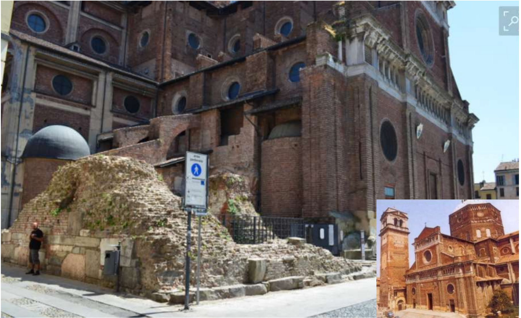
Crollo Torre Civica (marzo 1989)
