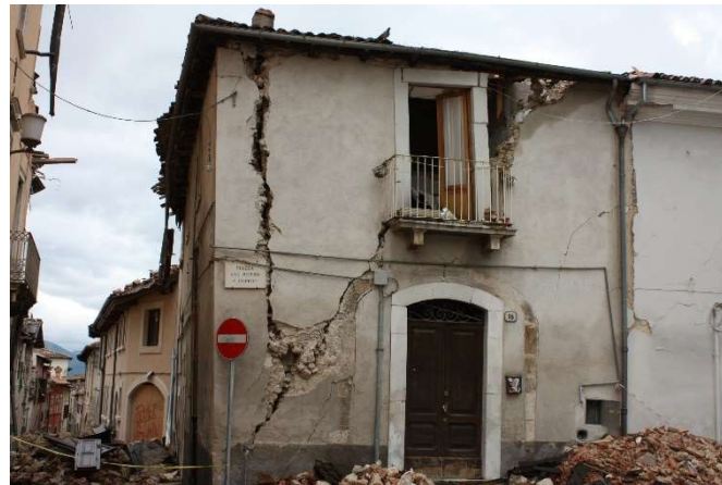
Edificio centro L'Aquila – L'Aquila 2009
