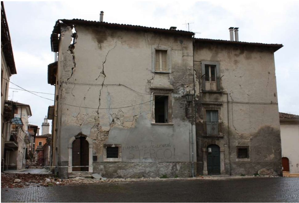
L'Aquila 2009 Separazione parete all'intersezione con quella perpendicolare
