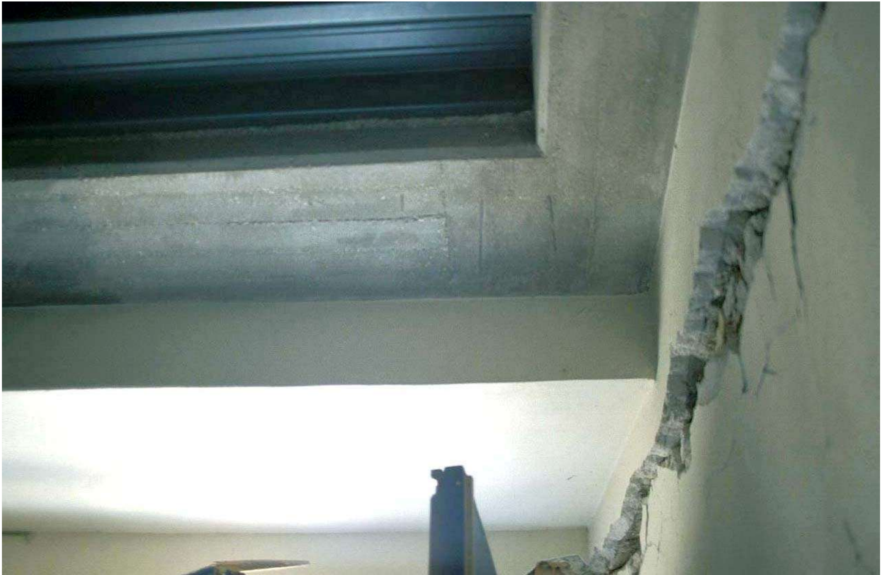
Umbria 1997: rottura orizzontale muratura dovuta al nuovo solaio in calcestruzzo
