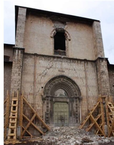
Flessione orizzontale fuori piano – L'Aquila 2009
