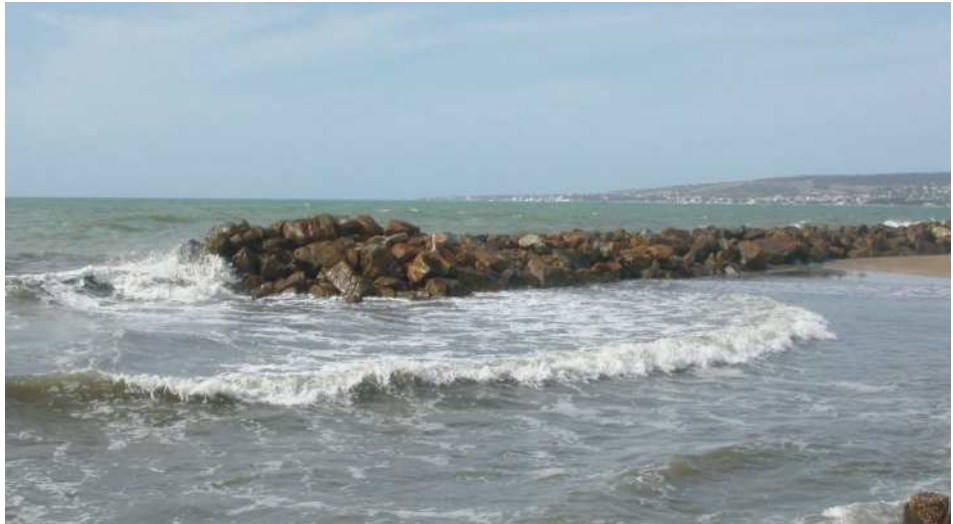
Figura 4.1.14: Barriera frangiflutti in massi di cava. Il suo scopo principale è quello di intercettare le onde, dissipandone l'energia prima che colpiscano la costa. Nella zona di calma presente sul lato terra, se il rapporto tra larghezza del varco e distanza dalla battigia è stato ben calcolato, si ha tendenza alla deposizione di sedimento marino.
