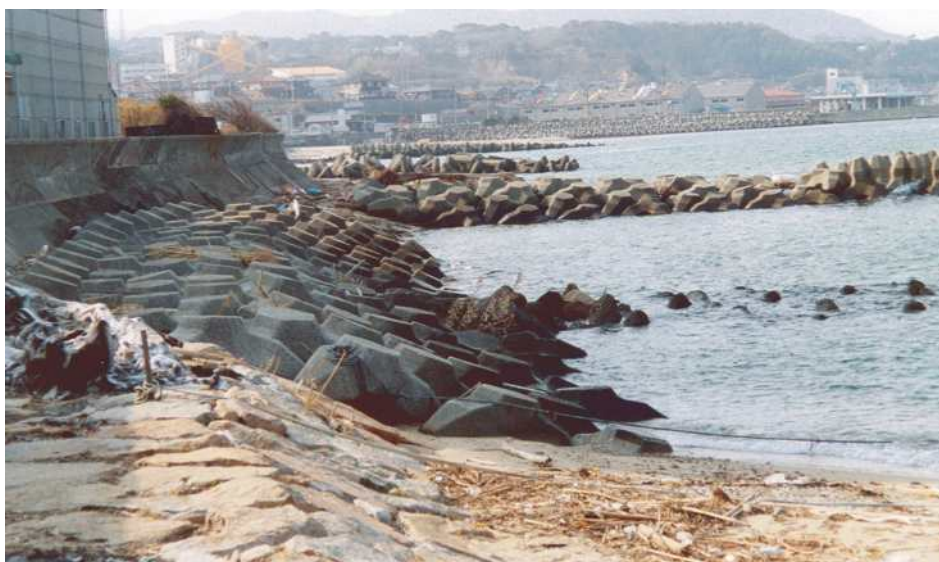
Figura 4.3.1: Sistema combinato di strutture aderenti a difesa di un impianto industriale. La scogliera è rivestita con elementi in cemento armato atti a creare una superficie frastagliata per favorire la dissipazione dell'energia del moto ondoso incidente prima dell'urto finale con il muro. Si noti la curvatura del muro verso mare con funzione antisormonto.
