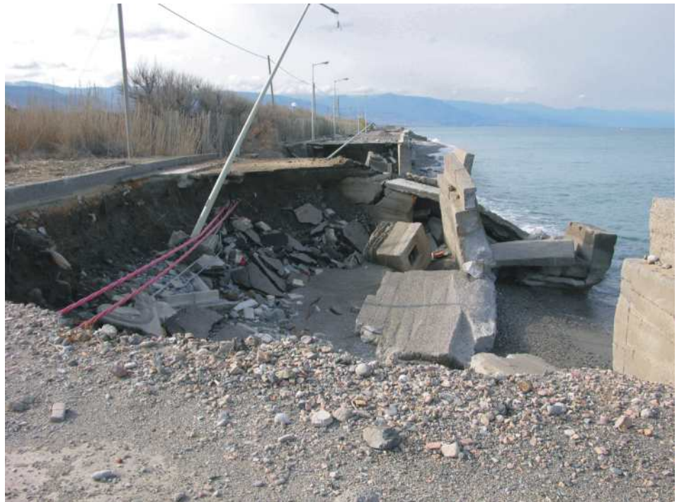
Figura 4.0.3: Conseguenze dell'attacco ondoso su una strada litoranea. L'azione erosiva delle onde incidenti si esplica mediante violenti impatti che possono anche demolire la struttura. Nella maggior parte dei casi si deve prevedere un adeguamento o una protezione al piede dell'intervento.
