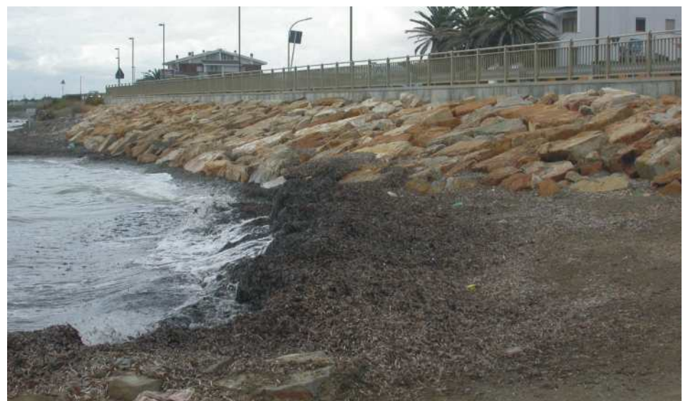
Figura 4.3.10: Rivestimento in massi. Spesso per limitare i danni alle infrastrutture viarie e ferroviarie causati da tempeste e mareggiate, si utilizzano rivestimenti con materiali di cava. La loro costruzione a ridosso delle massicciate viene eseguita con una disposizione più o meno regolare dei massi che ne aumenta la stabilità, mentre la loro conformazione superficiale irregolare consente una buona dissipazione dell'energia delle onde incidenti.
