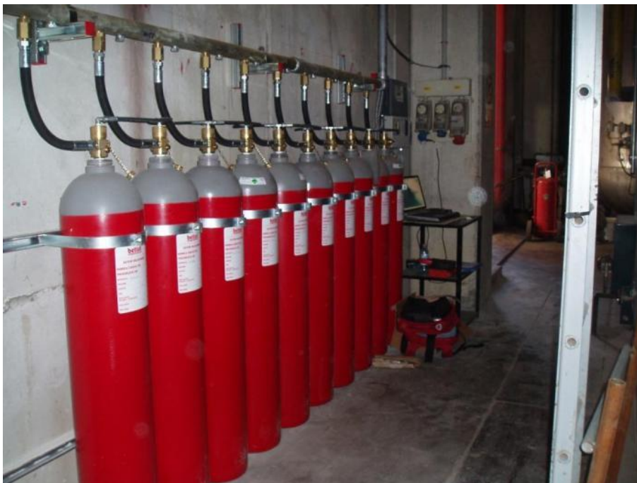
Figura 73 Bombele di CO 2 in rastrelliera
