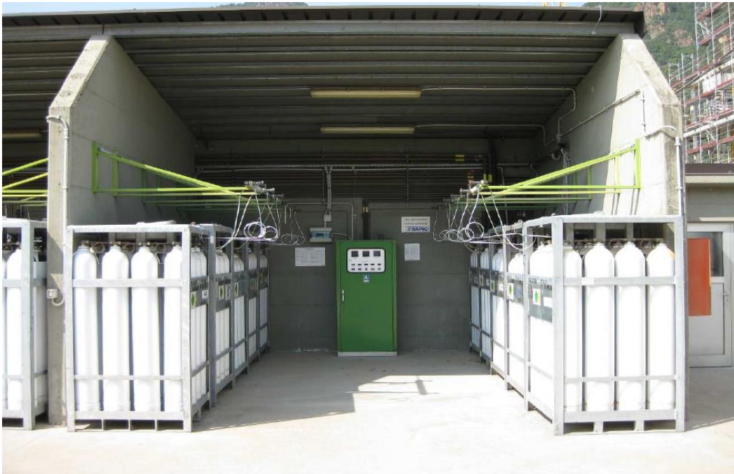
Figura 122 Centrale gas medicali
