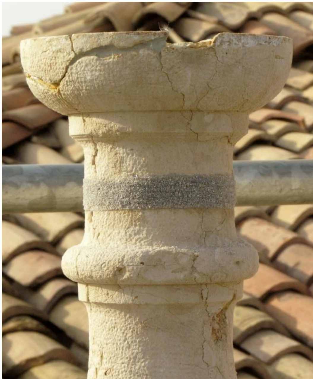
Figura 13 • Nastro di altezza ridotta in fibra di carbonio prima della stesura della malta di finitura.
