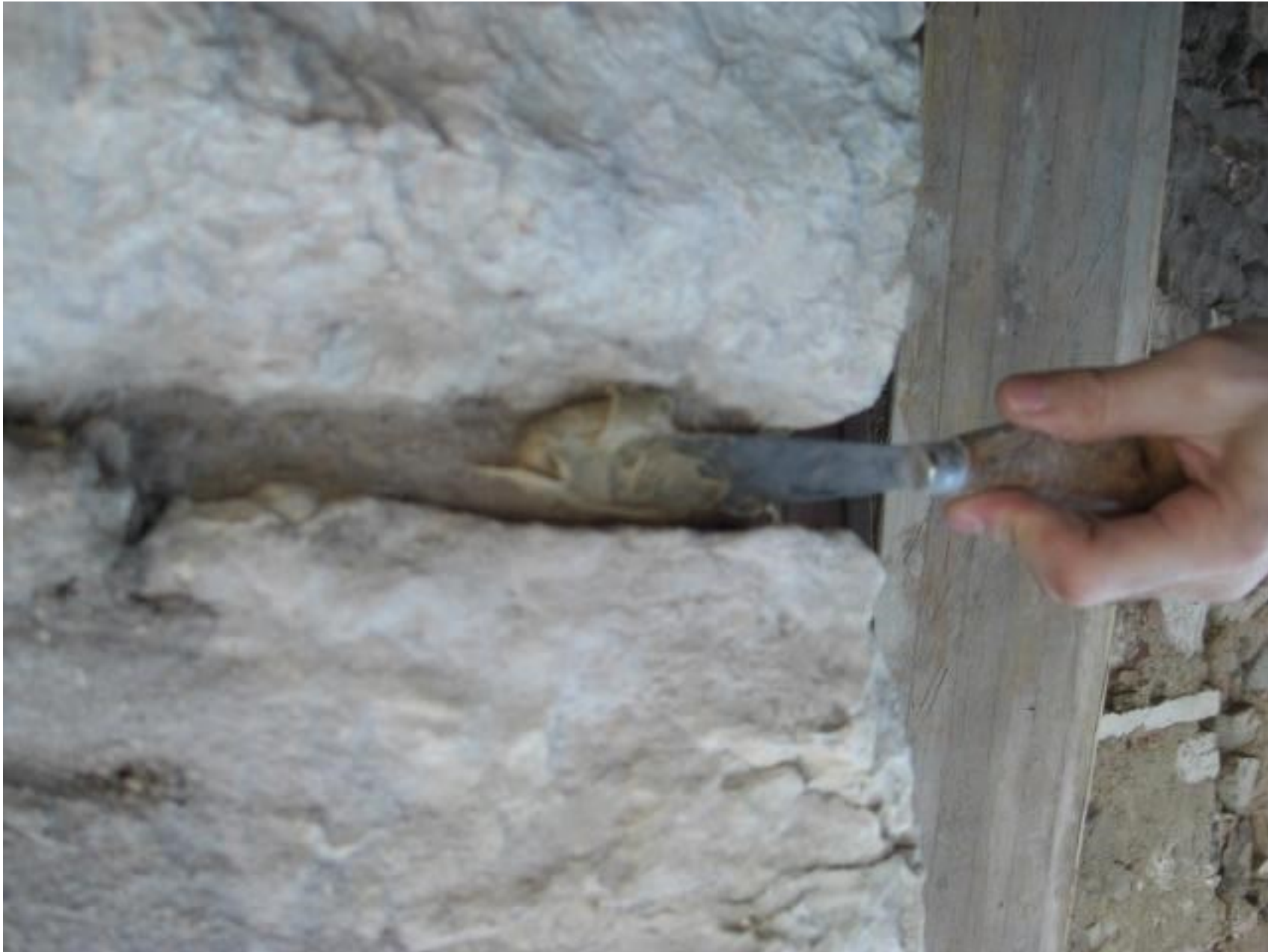
Figura 16b • Fasciatura inserita nei giunti di malta. Stesura dell'adesivo epossidico a consistenza di stucco.
