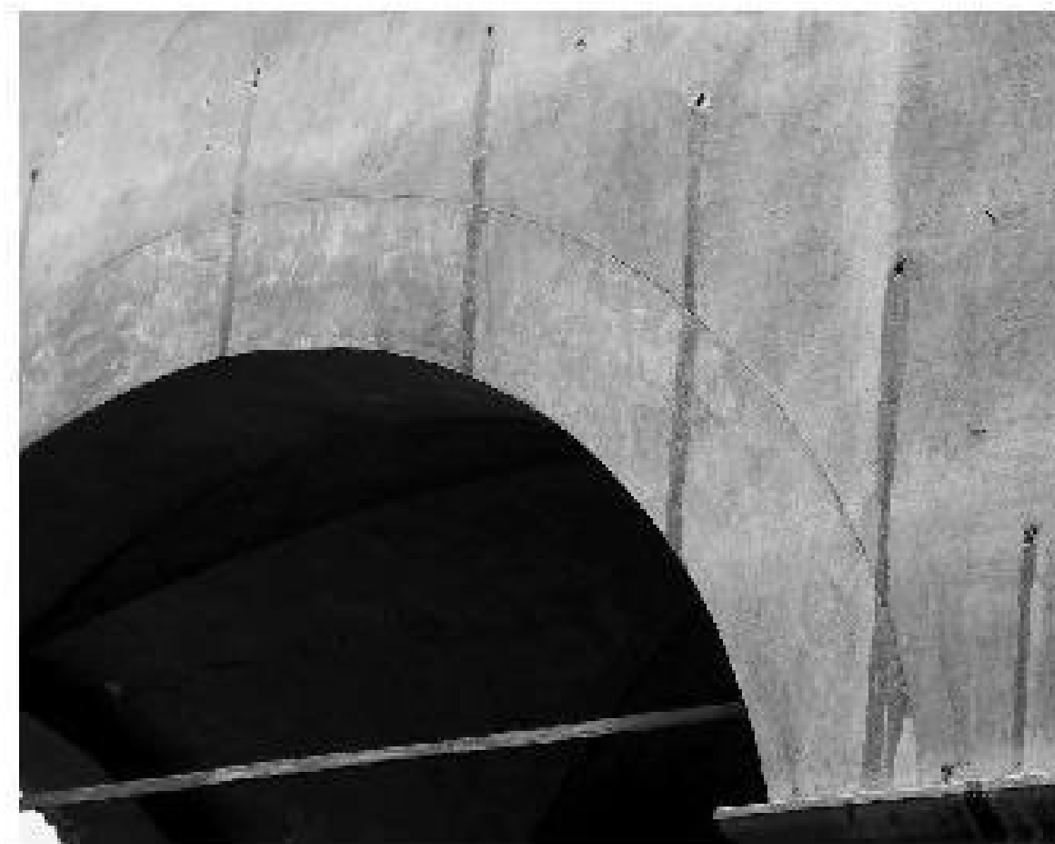
Figura 9 • Applicazione errata della tecnica, con fuoriuscita del prodotto consolidante dai fori di iniezione e conseguente formazione di colature difficilmente eliminabili.
