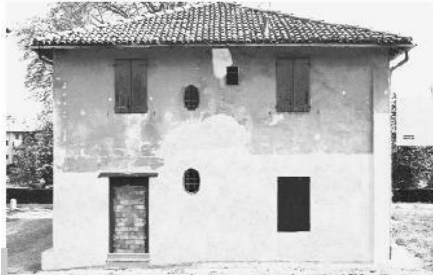
Figura 1 • Rappezi di varia dimensione e nuova stesura di intonaco nella parte basamentale della facciata.
