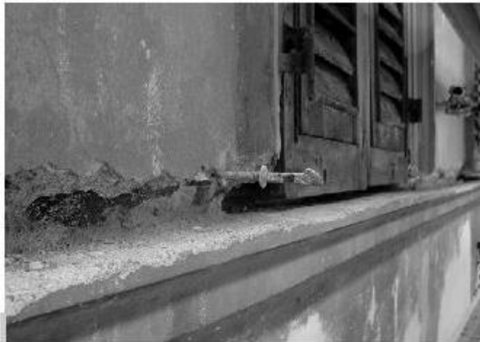
Figura 5 • Rimozione delle copertine in ardesia irrecuperabili e preparazione dello scasso, per accogliere le nuove.
