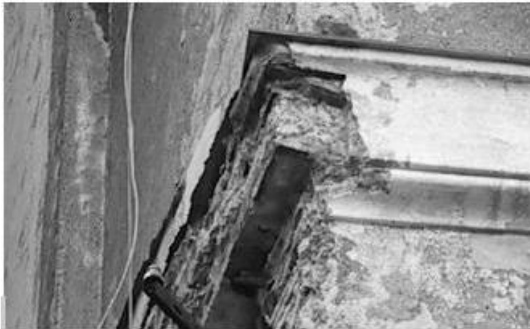
Figura 1 • Cornice marcadavanzale in stucco. La mancata riparazione o sostituzione della copertina di ardesia, posta a protezione della cornice, ha consentito alle acque meteoriche di compromettere l'integrità del rivestimento in stucco e del supporto in mattoni.
