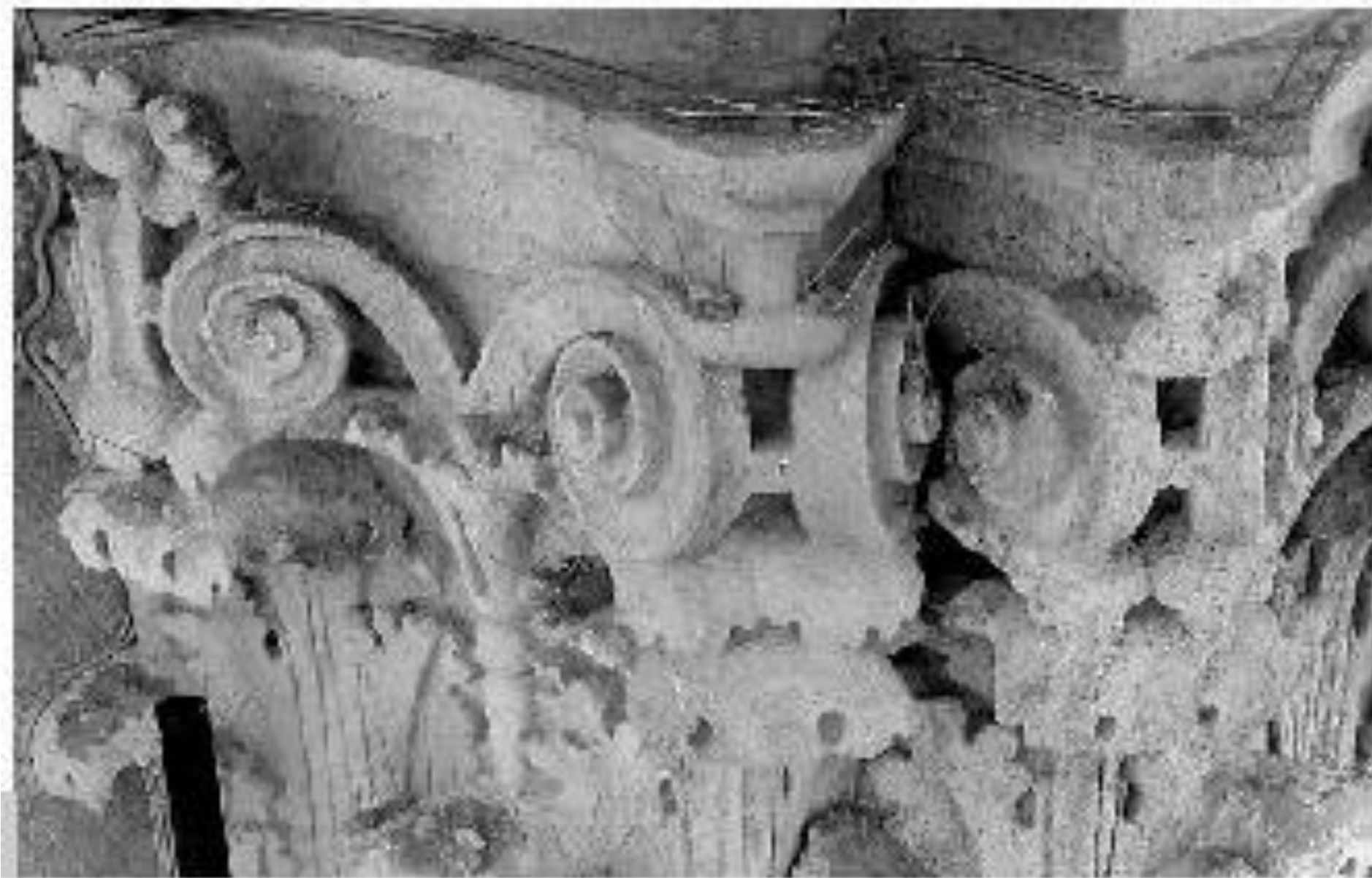
Figura 8 • Allontanamento di volatili con sistemi misti: mentre sulle volute sono stati applicati dei dissuasori ad aghi, sull'abaco del capitello si può vedere la linea del sistema elettrostatico.
