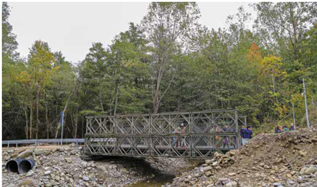
Amatrice, 2016. Installazione di un ponte bailey in località Retrosi per il ripristino della viabilità stradale.
