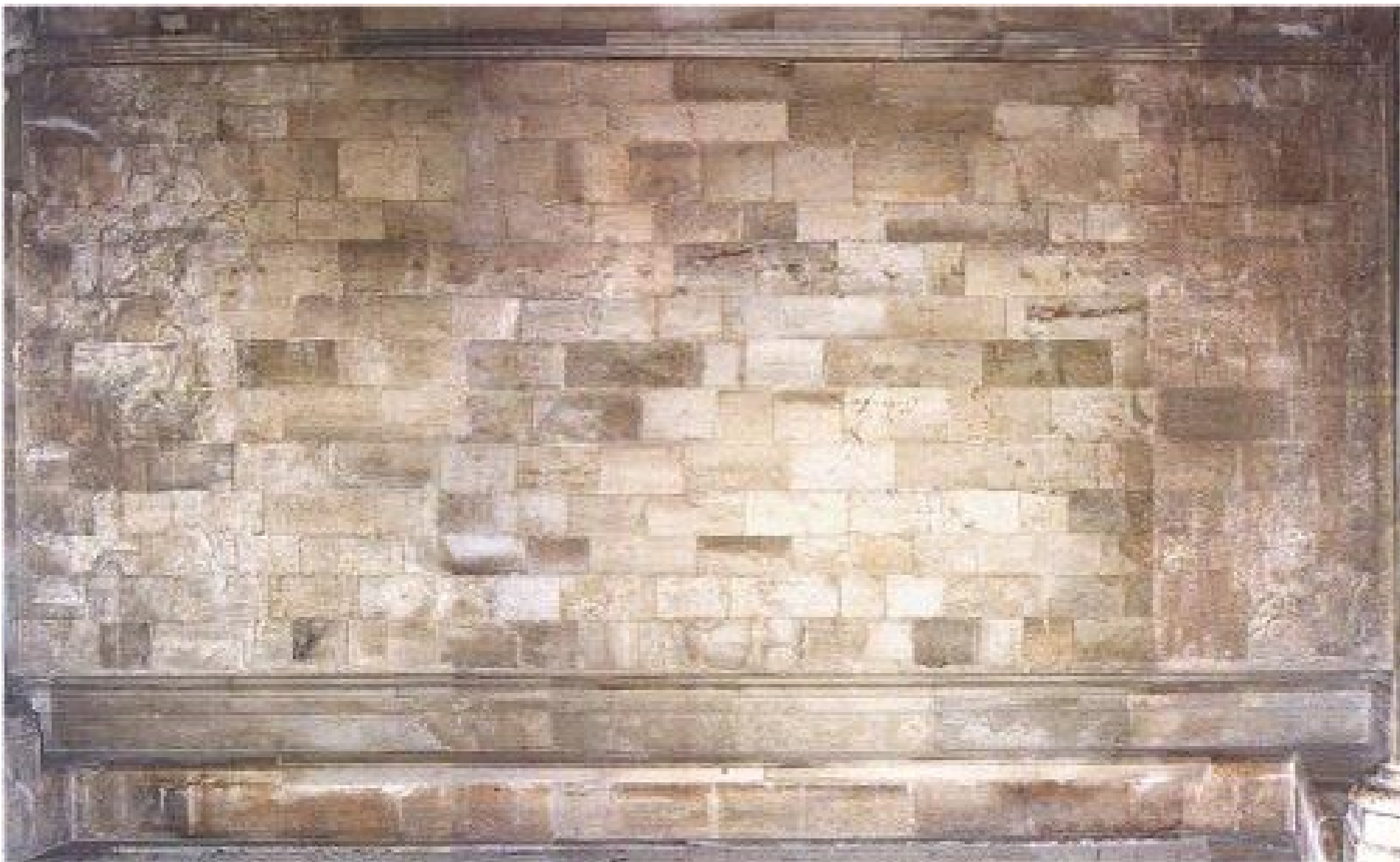
Figura 19 • Castel del Monte, sala VIII, primo piano, parete in conci lapidei con tracce del rivestimento parietale originale in lastre marmoree (alloggiamenti per le grappe di fissaggio delle lastre, grappe intere o spezzate, piombo ecc.).
