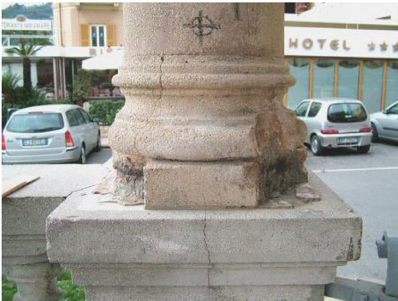
Figura 15 • Mancanze in un basamento in pietra artificiale.
