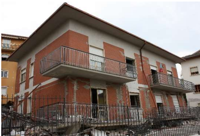
Collasso edificio con piano terra porticato
