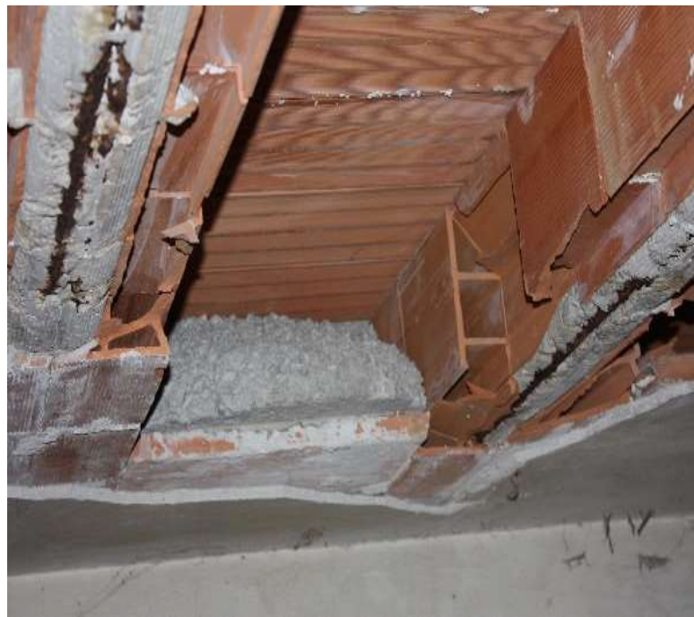
Sfondellamento solaio tipo Sapal
