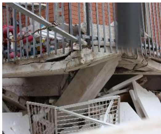
Particolare collasso pilastro piano terra
