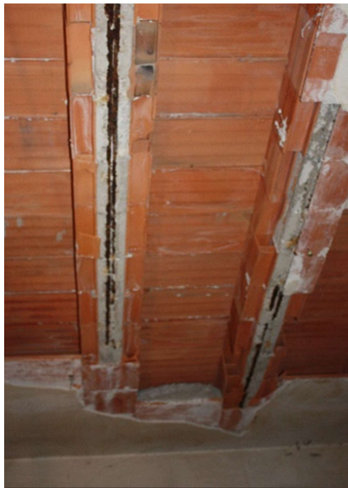
Sfondellamento solaio tipo Sapal
