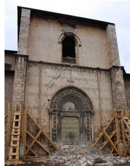
Flessione orizzontale fuori piano – L'Aquila 2009
