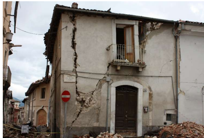
Edificio centro L'Aquila – L'Aquila 2009
