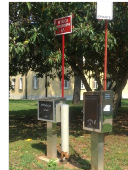
40 | VANI E ELEMENTI TECNICI Attacco autopompa
