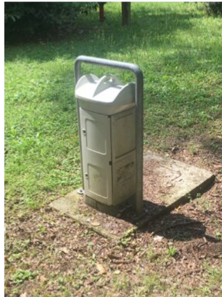
08 | VANI E ELEMENTI TECNICI Cabinetta enel
