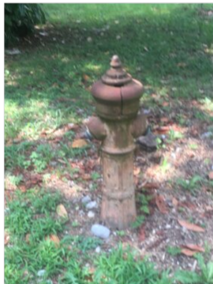
72 | VANI E ELEMENTI TECNICI Idrante non in uso
