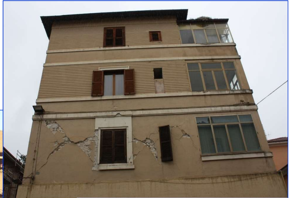
L'Aquila, 2009 Fessurazione diagonale maschi
