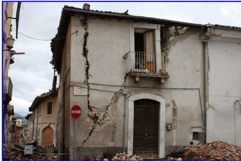
Edificio centro L'Aquila – L'Aquila 2009
