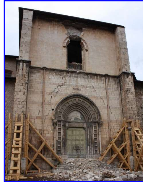
Flessione orizzontale fuori piano – L'Aquila 2009
