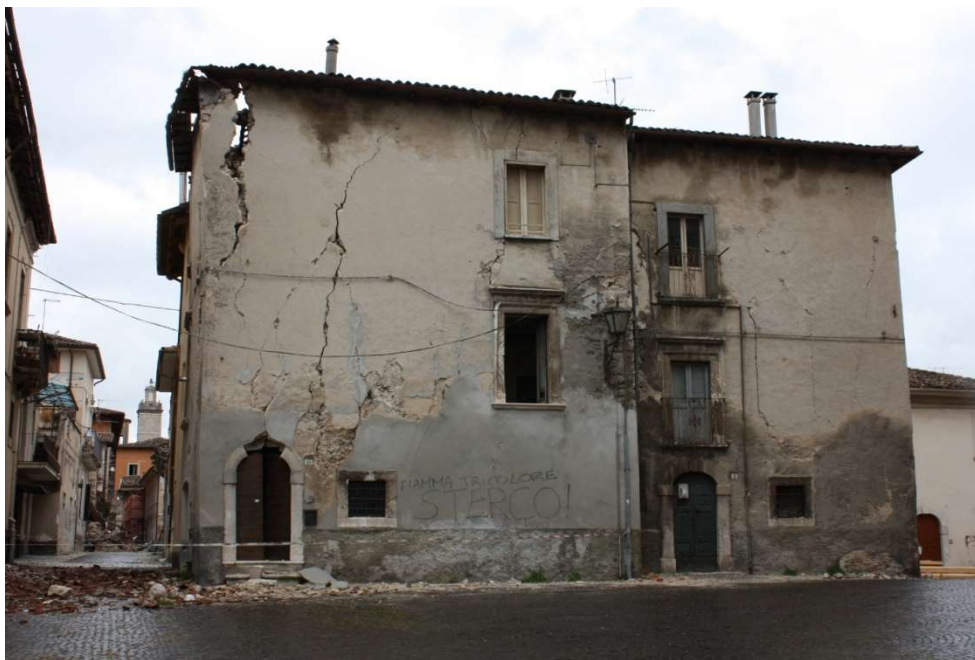
L'Aquila 2009 Separazione parete all'intersezione con quella perpendicolare
