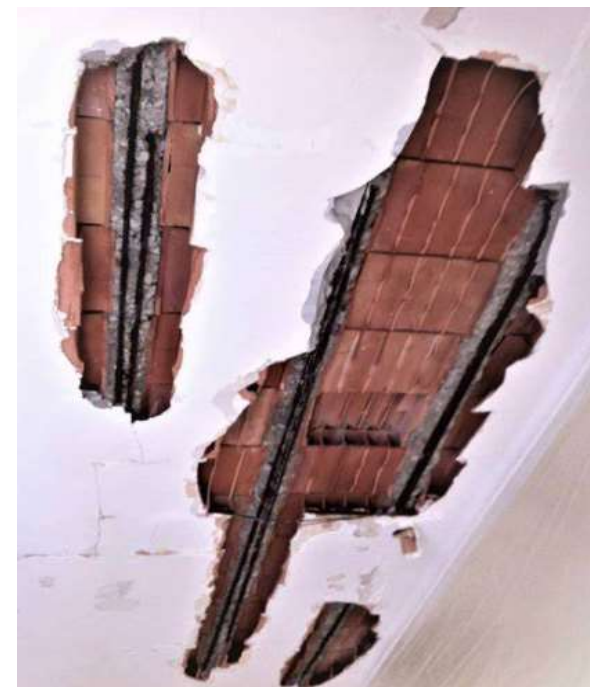
Sfondellamento solaio a travetti tralicciati
