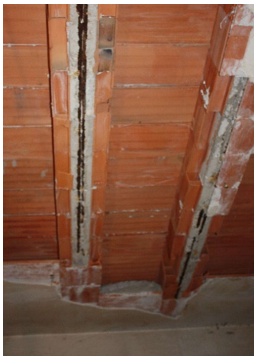
Sfondellamento solaio tipo Sapal
