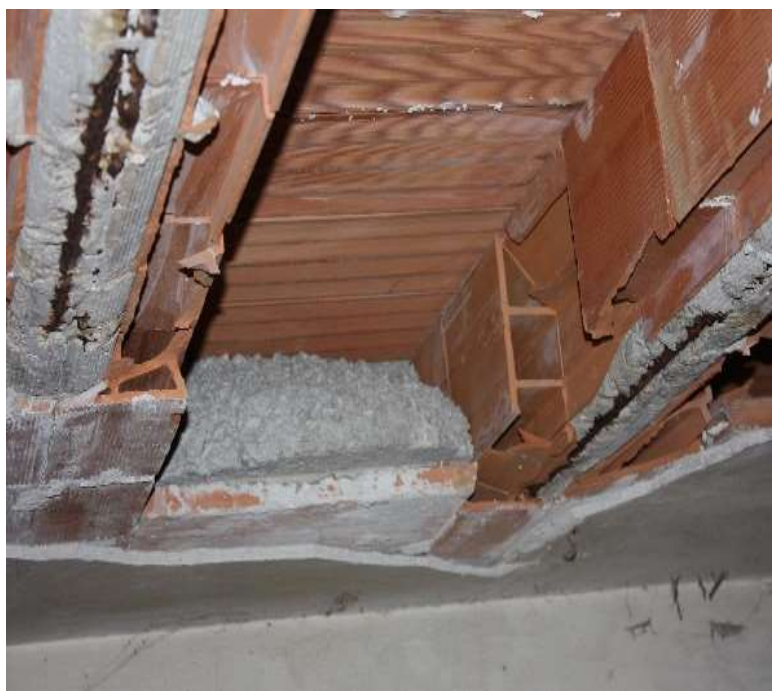
Sfondellamento solaio tipo Sapal
