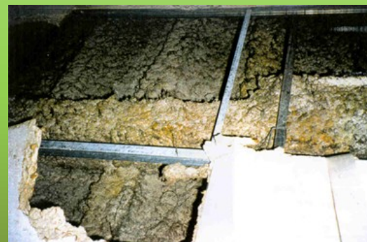
amianto spruzzato a soffitto visibile dopo rimozione di controsoffittature
