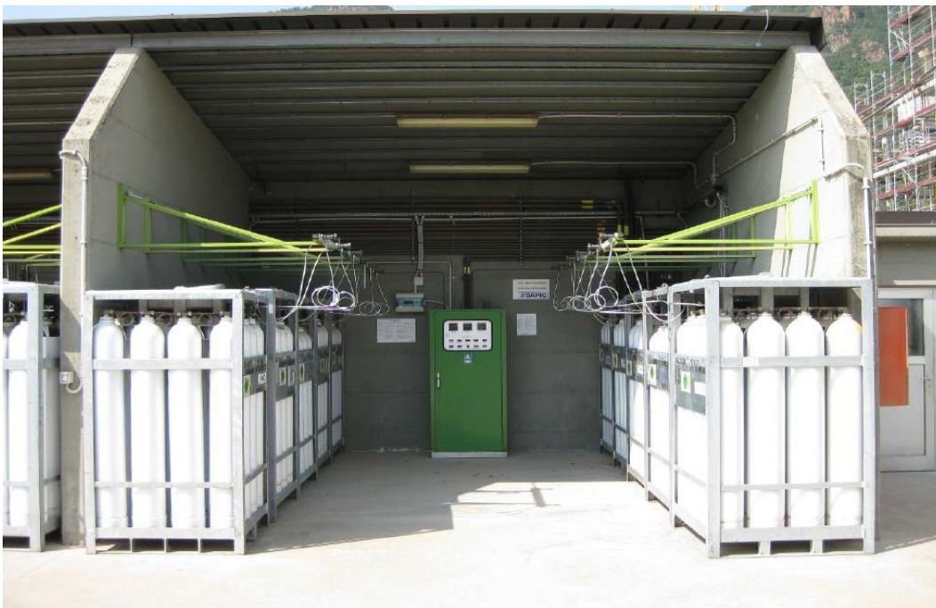
Figura 122 Centrale gas medicali
