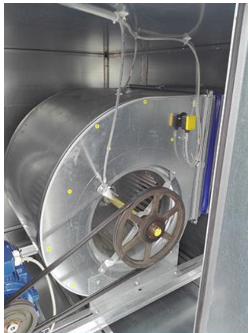
Figura 113 Ventilatore centrifugo a servizio di una UTA
