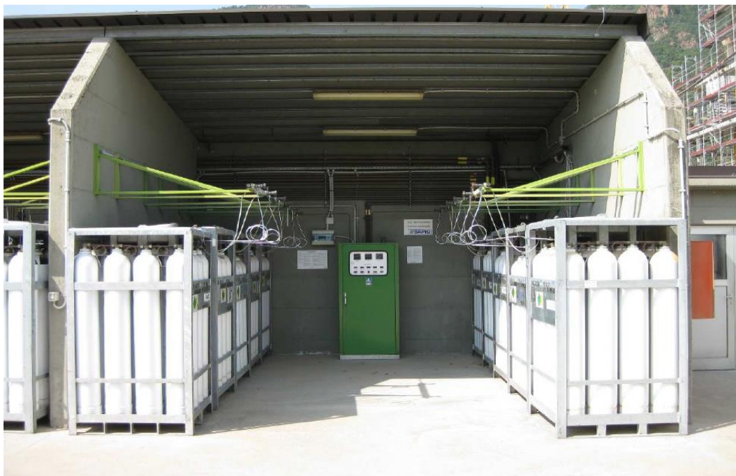
Figura 122 Centrale gas medicali
