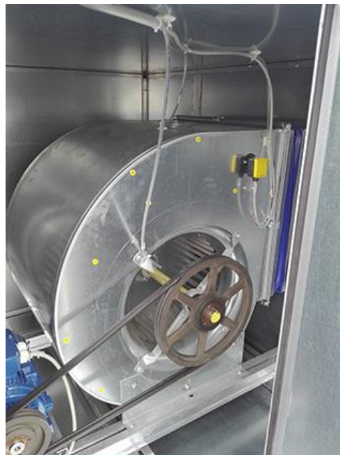
Figura 113 Ventilatore centrifugo a servizio di una UTA
