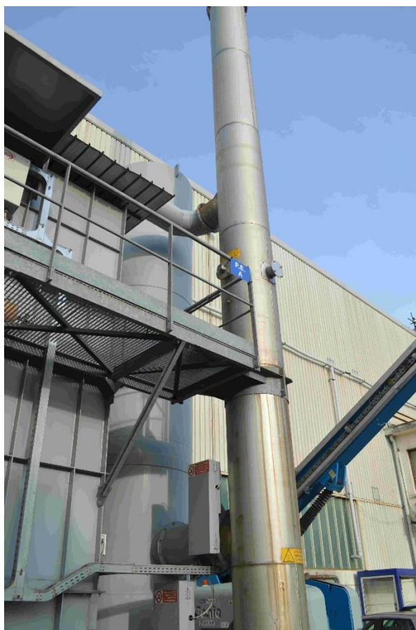
Figura 5 Punto di prelievo su condotto verticale
