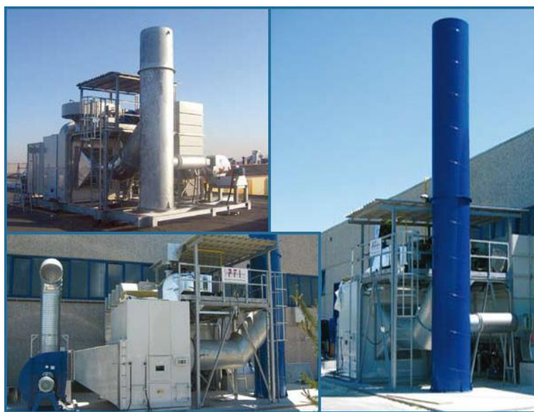
Figura 110 Impianti di abbattimento con rotoconcentratore
