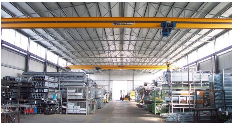
Figura 3 Carroponte installato nel magazzino materie prime
