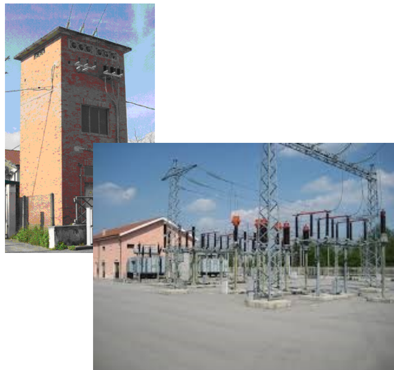
Cabine di trasformazione e sottostazioni elettriche
